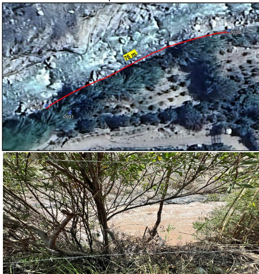
Imágenes n.ºs 57 y 58 Visualización del tramo que no se observa acomodo de roca en talud
