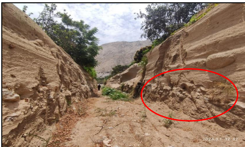
Imágenes n.ºs 7 Y 8 Tomas fotográficas de la quebrada – Falta perfilado de talud
