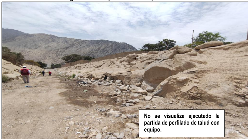
Imágenes n.ºs 17 y 18 Tomas fotográficas de la quebrada – Falta perfilado de talud
