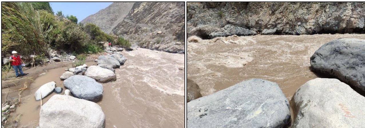
Imágenes n.ºs 50 y 51 Deficiente protección en margen derecho del río
