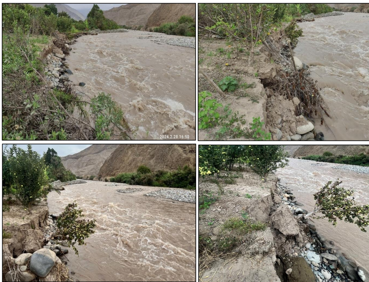
Imágenes n.ºs 61, 62, 63 y 64 Tramo sin conformación de dique, desmoronamiento de terreno
