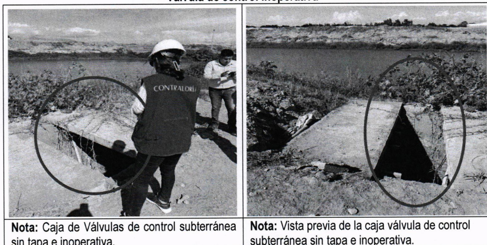
Imágenes n.ºs 25 y 26 Válvula de control inoperativa
