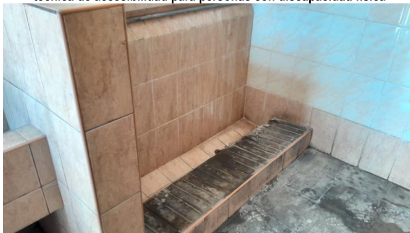
Imagen n.º 05 Urinarios para varones contrario al tipo exigido en la normativa técnica de accesibilidad para personas con discapacidad física
