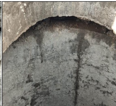
TOMA FOTOGRÁFICO N° 11 DISCONTINUIDAD EN PARED LATERAL DE BUZÓN BP-4.
