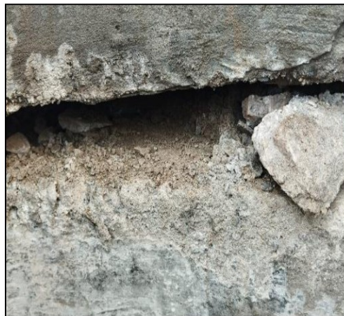
TOMA FOTOGRÁFICA N° 10 DISCONTINUIDAD EN PARED LATERAL DE BUZÓN BP-5
