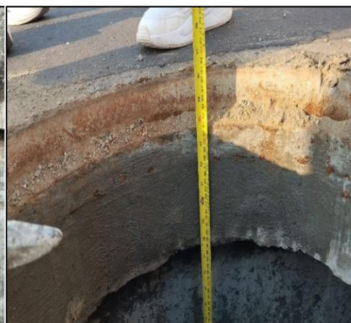
TOMA FOTOGRÁFICA N° 13 DISCONTINUIDAD EN PARED LATERAL DE BUZÓN BP-2
