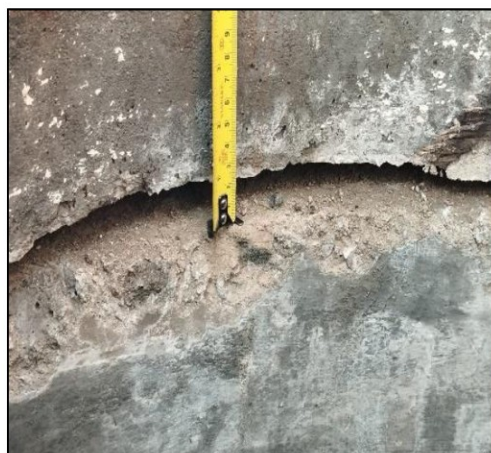
TOMA FOTOGRÁFICA N° 12 DISCONTINUIDAD EN PARED LATERAL DE BUZÓN BP-3
