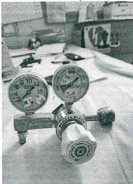
Imagen n.º12 Manómetro inoperativo
