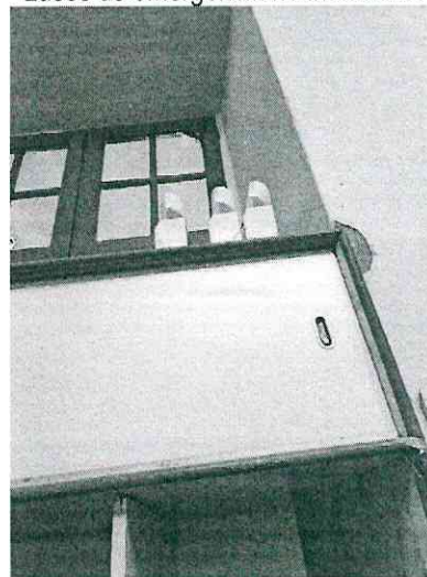
Imagen n.º 18 Luces de emergencia no instaladas
