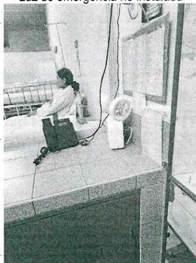
Imagen n.º 17 Luz de emergencia no instalada
