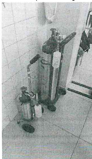
Imagen n.º15 Unidades de transporte de oxígeno oxidadas
