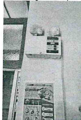
Imagen n.º32 Luz de emergencia inoperativa
