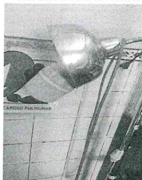
Imagen n.º19 Luminaria mal colocada
