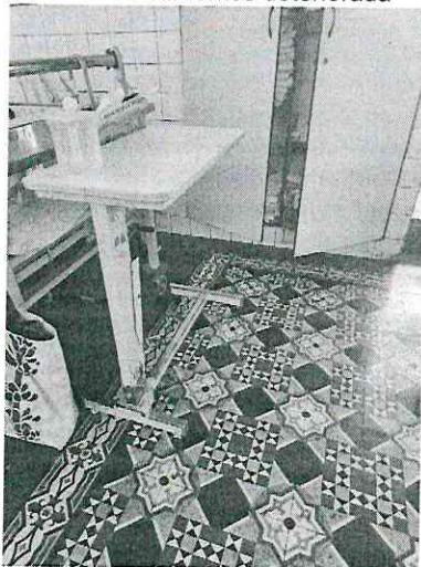
Imagen n.º13 Mesa de alimentos deteriorada
