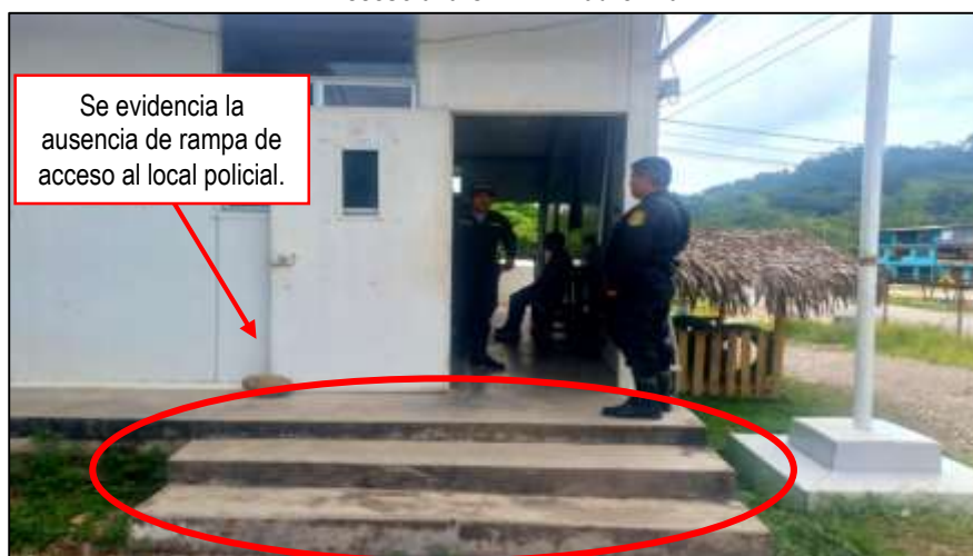
Fotografía n.º 1 Acceso a la CPNP – Madre Mía
