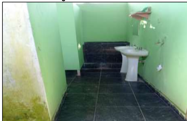
Fotografía n.° 3 Servicios Higiénicos de la CPNP – Madre Mía
