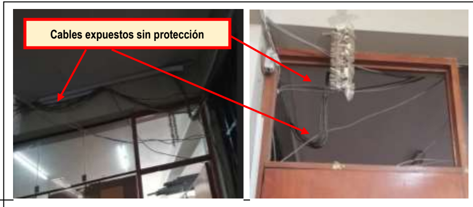
IMAGEN N° 06 CABLES EXPUESTOS SIN CANALETAS
