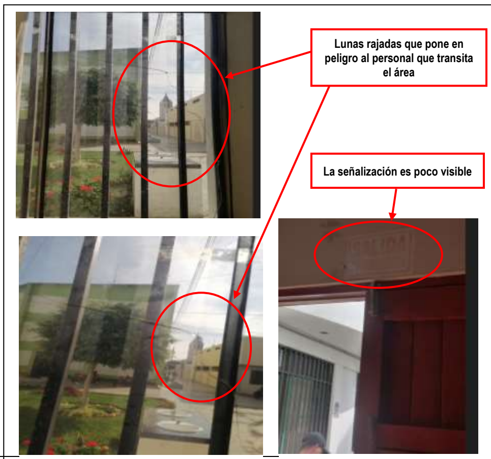
IMAGEN N° 05 VENTANA CON VIDRIOS RAJADOS Y SEÑALIZACIÓN POCO VISIBLE
