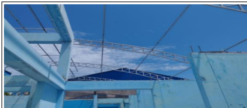
Imagen n.º 9 Techo de mercado sin instalación de pararrayo
