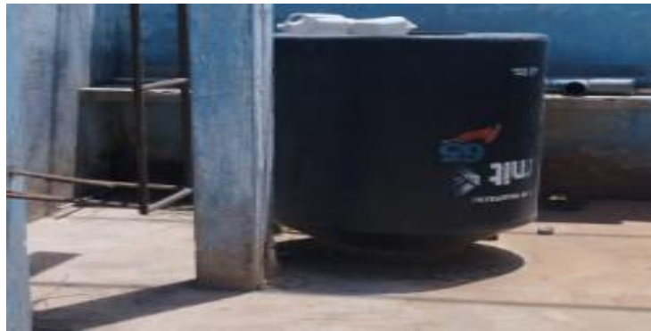
Imagen n.º15 Imagen de tanque de agua
