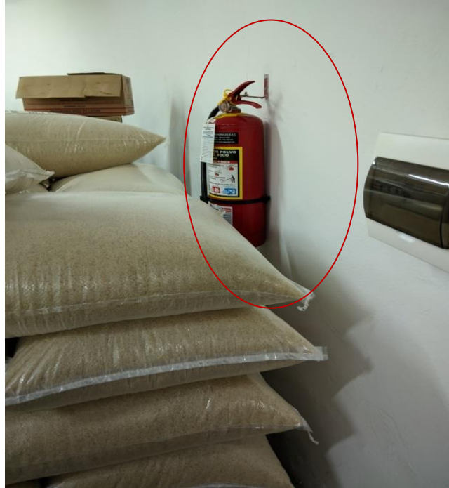
Imagen n.º 7 Sacos de Arroz bloquean acceso a extinguidor
