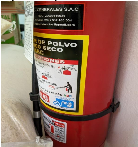
Imagen n.º 5 Extinguidor con fecha vigente al lado de los sacos de arroz
