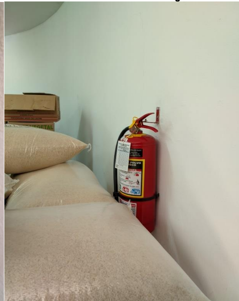
Imagen n.º 6 Falta de señal o cartel del extinguidor
