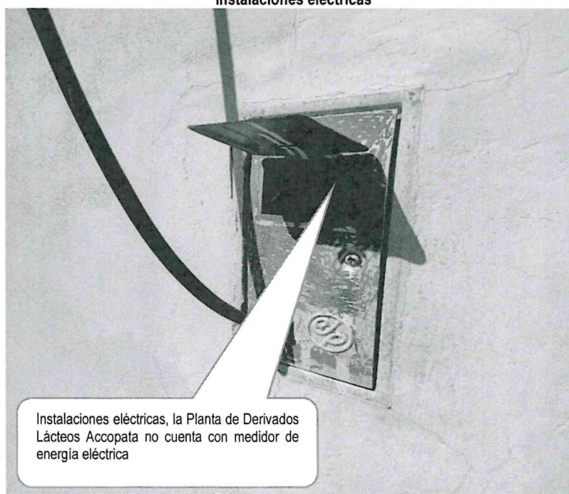
Imagen n.º 9 Instalaciones eléctricas
