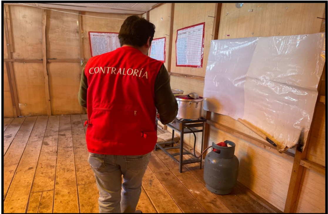
Imagen n°5: Techos en mal estado, piso se encuentra sucio.
