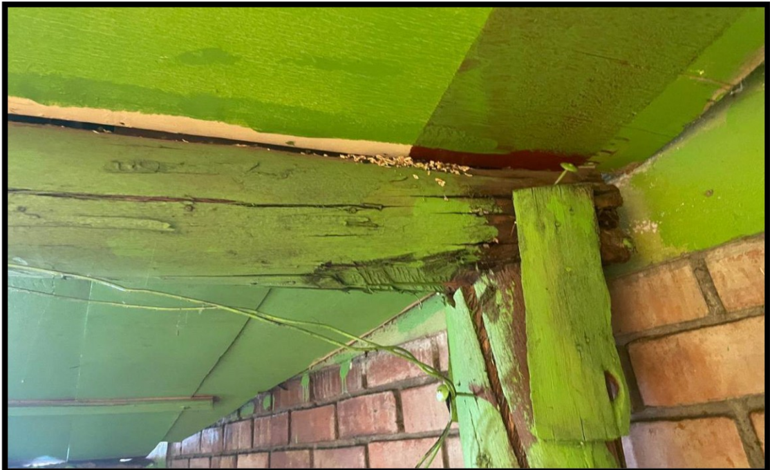
Imagen n°4: Vigas de madera en mal estado (Rajaduras) riesgo de colapso.
