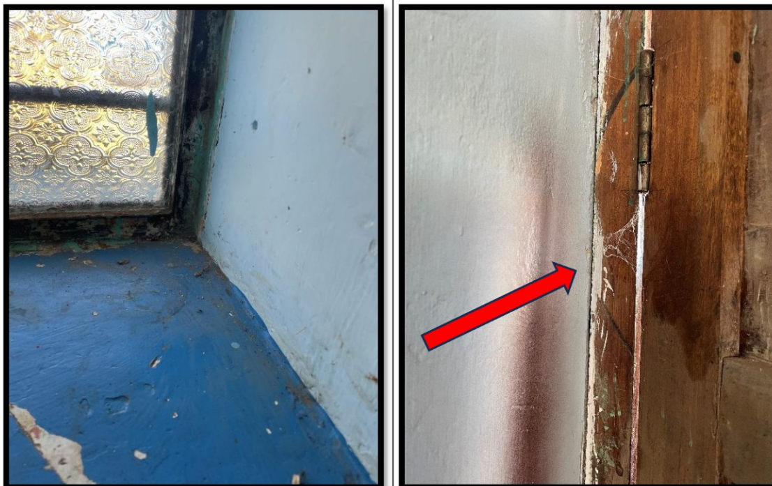
Imagen n° 2 - IIEE Inca Garcilazo de la Vega: Polvo y suciedad en las ventanas, Presencia de tela de arañas.
