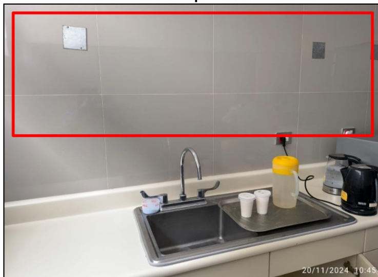
Imagen n.º 70 Ausencia de insumos para lavado de manos
