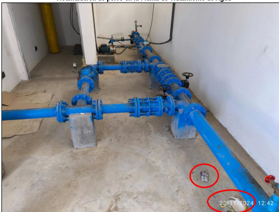
Imagen n.º 15 Acumulación de polvo en la Planta de Tratamiento de Agua
