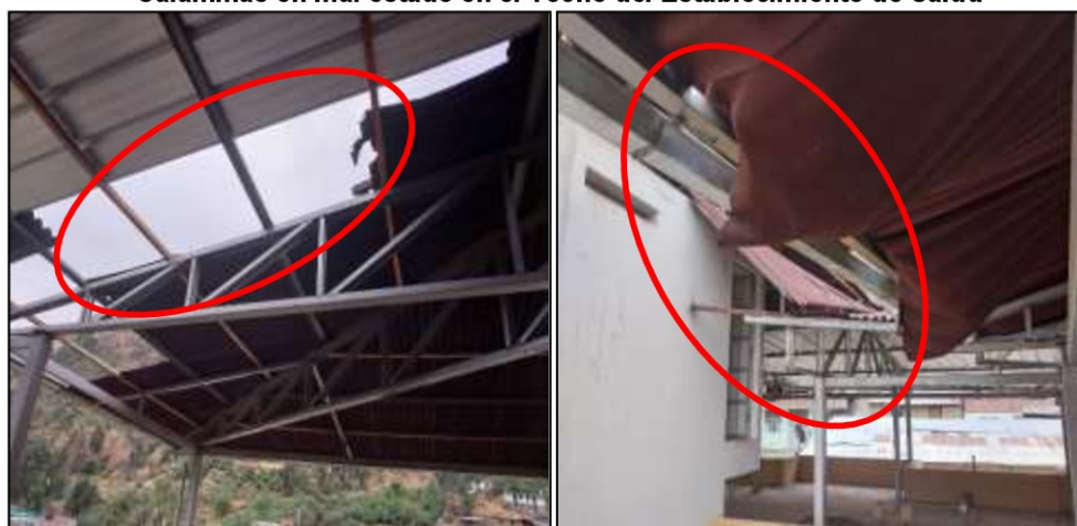
Imágenes n.º 1 y 2 Calaminas en mal estado en el Techo del Establecimiento de Salud
