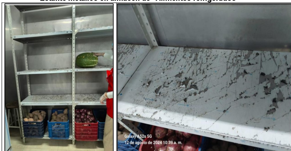
Imagen n.º 20 y 21 Estante metálico en almacén de “Alimentos refrigerados”
