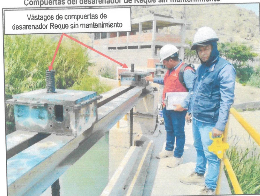
Imagen n.º 3 Compuertas del desarenador de Reque sin mantenimiento
