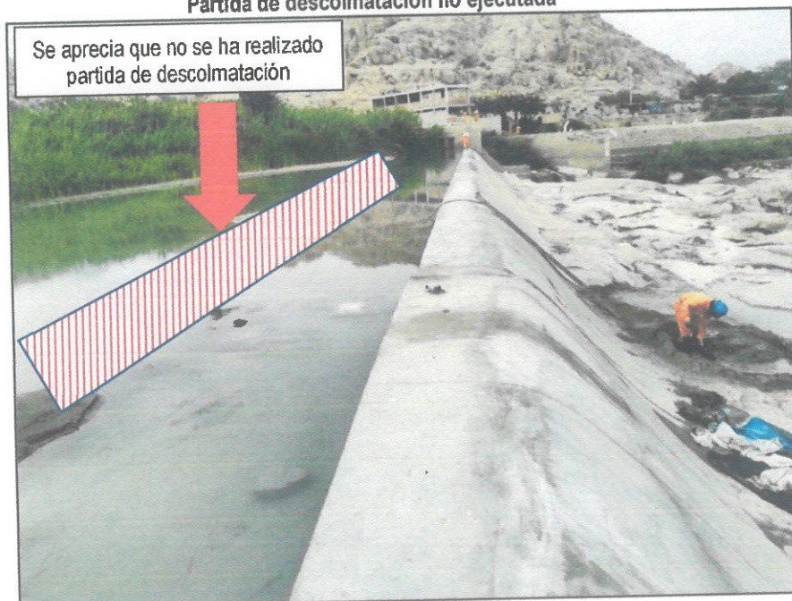
Imagen n.º 5 Partida de descolmatación no ejecutada
