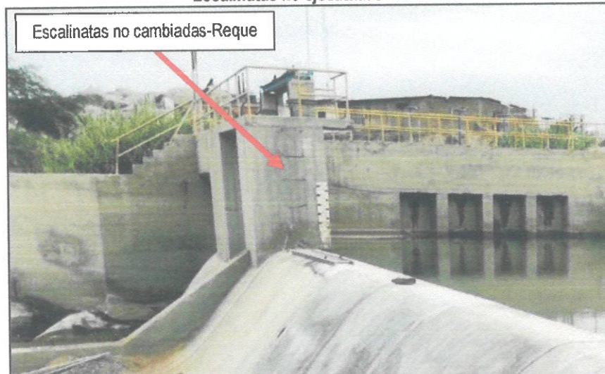
Imagen n.º 4 Escalinatas no ejecutadas
