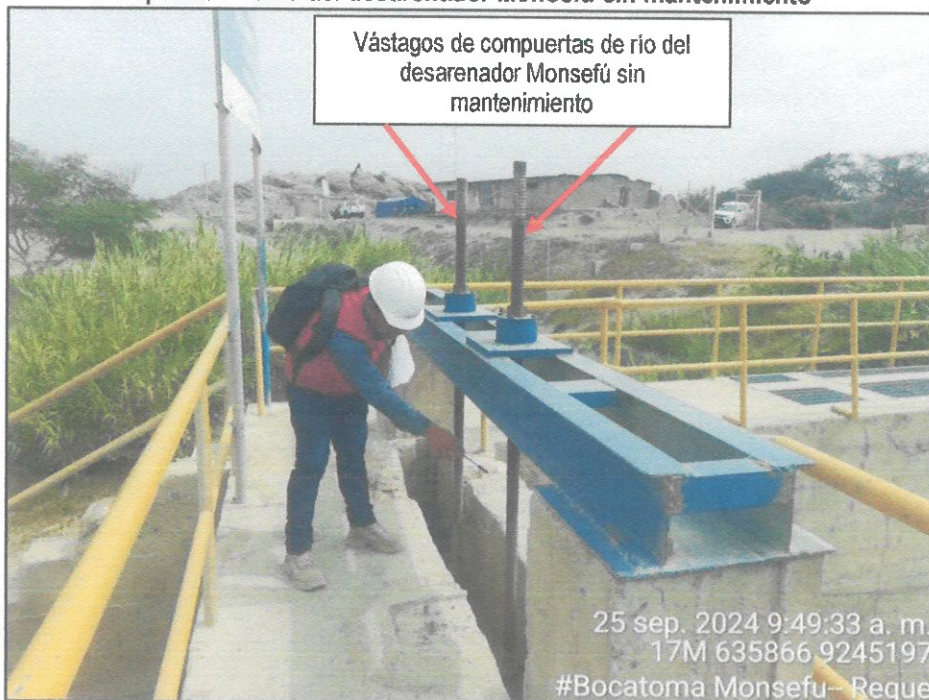
Imagen n.º 1 Compuertas de río del desarenador Monsefú sin mantenimiento
