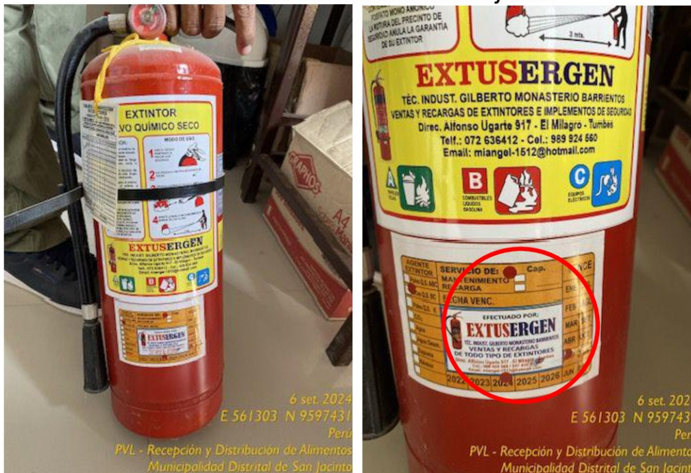
IMAGEN N°. 7 Extintor con fecha de vencimiento mayo 2024
