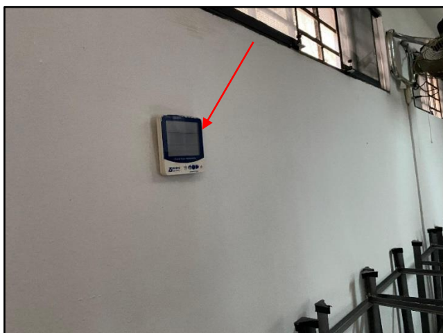
Imagen n.º 8 Medidor de temperatura sin funcionamiento
