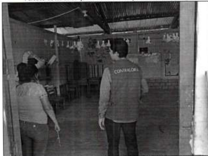
Imagen n.º 2 Paredes de las aulas que al menos una requiere sustitución
