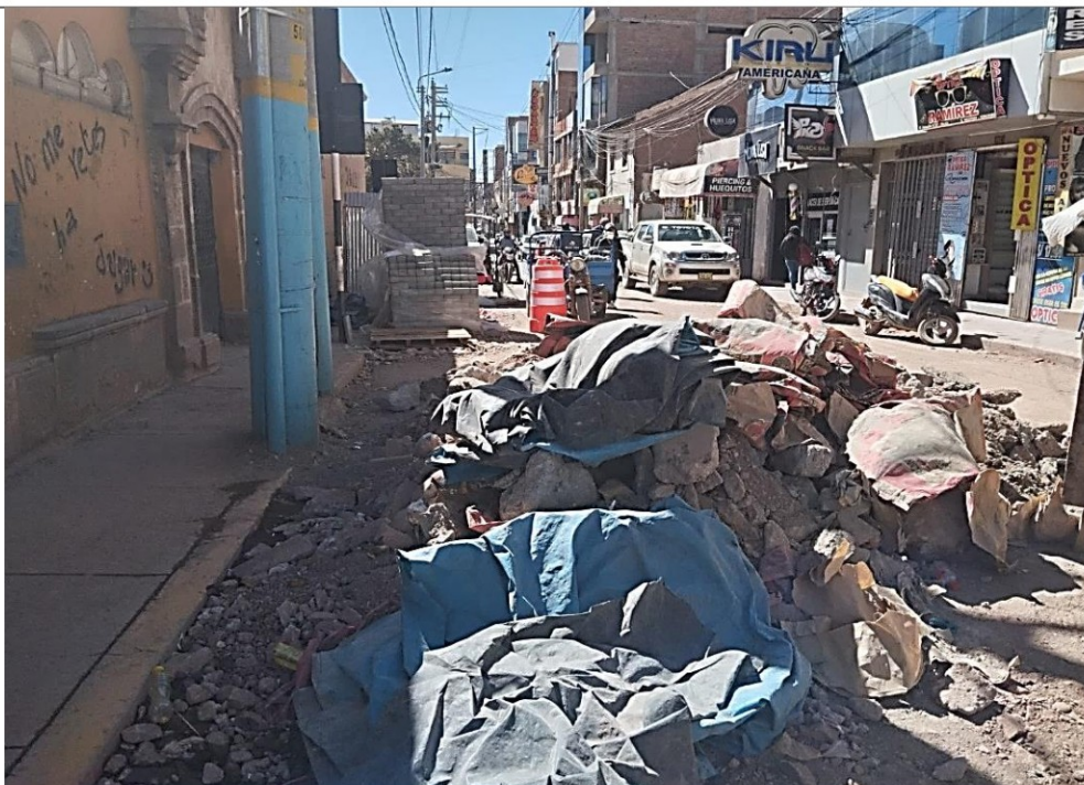
Fotografía n.º 10: Falta de señalización y manejo de material excedente
