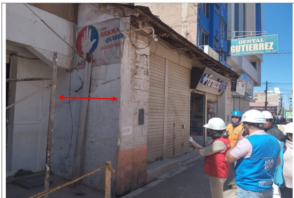
Fotografía n.º 11 Vivienda no alineada que impide la construcción de veredas
