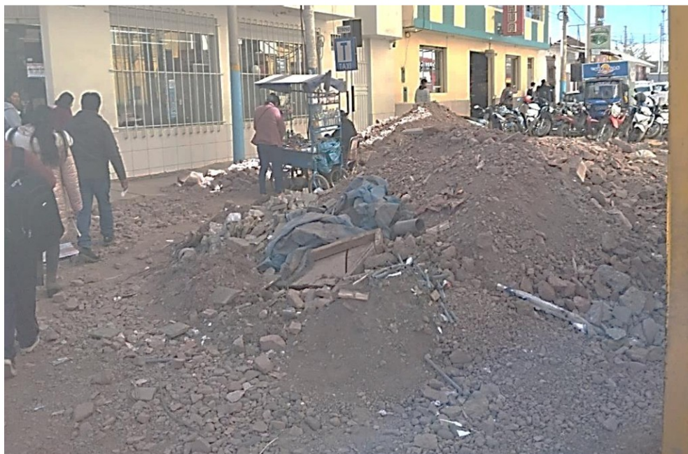
Fotografía n.º 9: Falta de manejo de material excedente.
