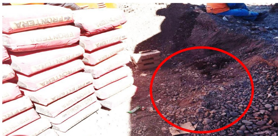
Fotografía n.º 4: Presencia de plástico y tierra no se verifica una adecuada dosificación agregado mayor a \frac{3}{4} ".
