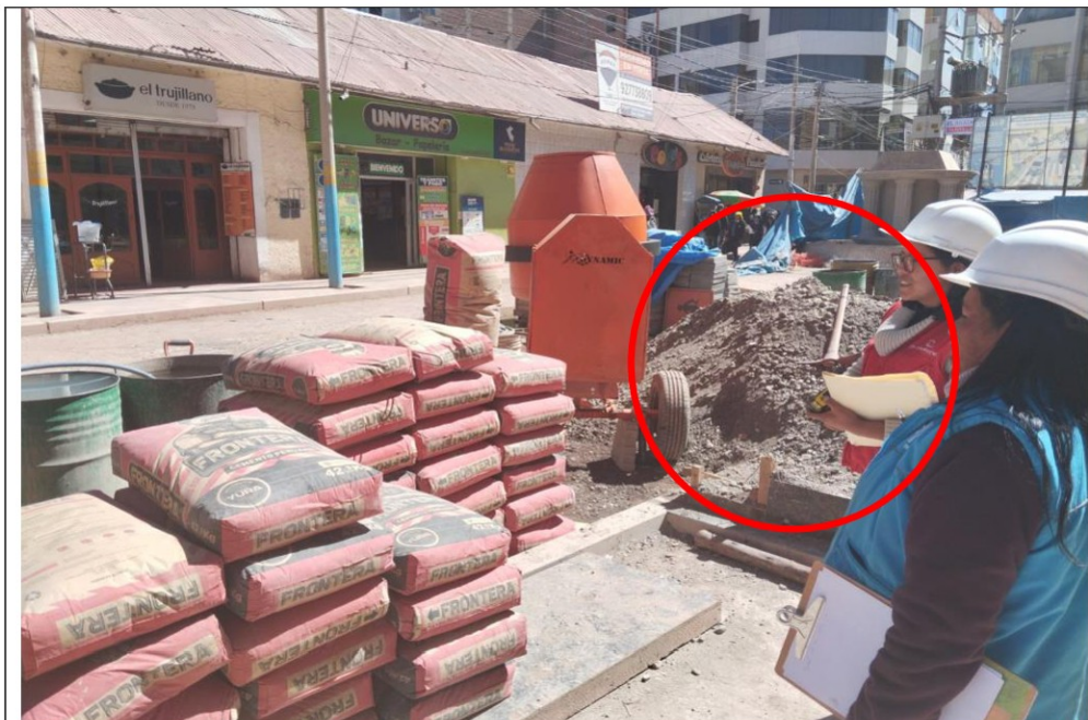
Fotografía n.º 1: Se advierte hormigón de río para el preparado de concreto en obra, el cual incumple lo establecido en el expediente técnico, que considera el uso de piedra chancada y arena.
