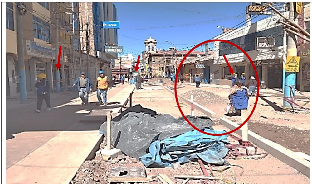
Fotografía n.º 7: Falta de señalización y vías alternas para tránsito peatonal.
