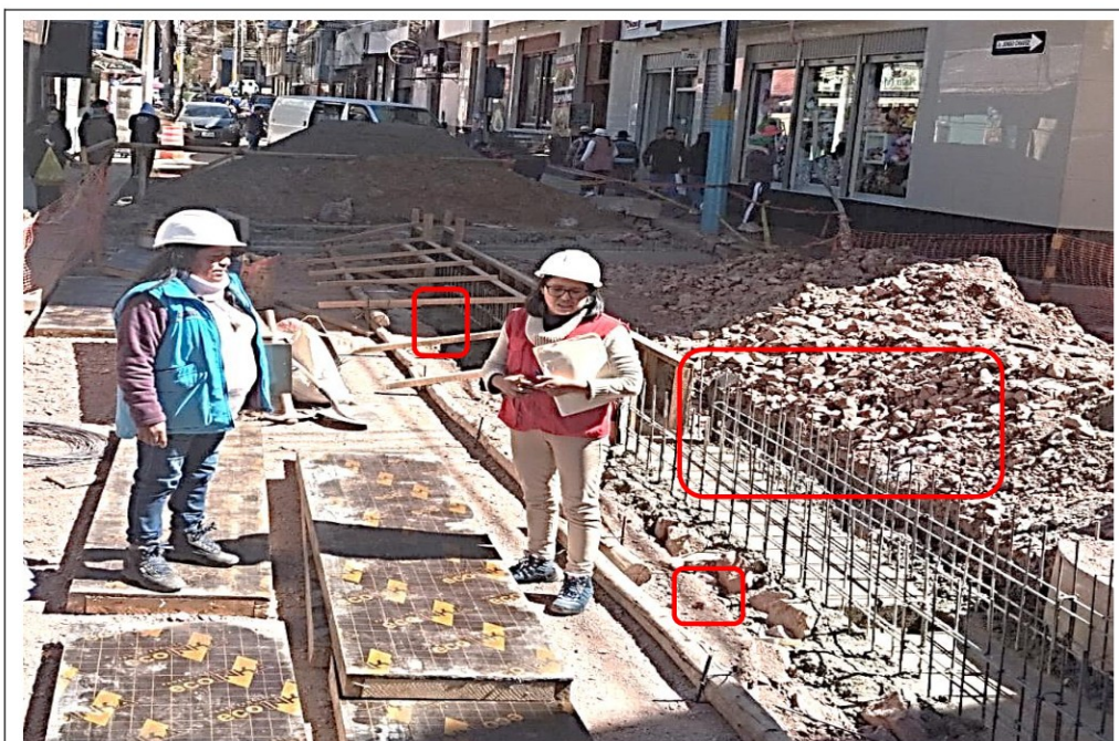
Fotografía n.º 5: Falta de protección de durmientes varillas de acero expuesto.
