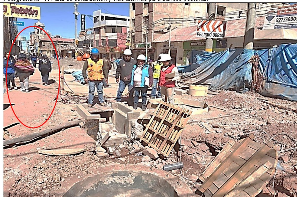
Fotografía n.º 8: Falta de señalización y vías alternas para tránsito peatonal.
