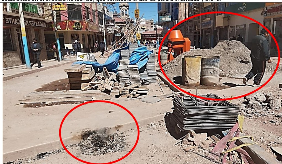
Fotografía n.º 2: Uso inapropiado del agregado en forma global contaminado con tierra y plástico, sin protección e inadecuadas condiciones de almacenamiento, inobservando el expediente técnico aprobado.
