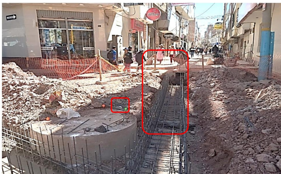
Fotografía n.º 6: Falta de protección de varillas de acero expuesto.
