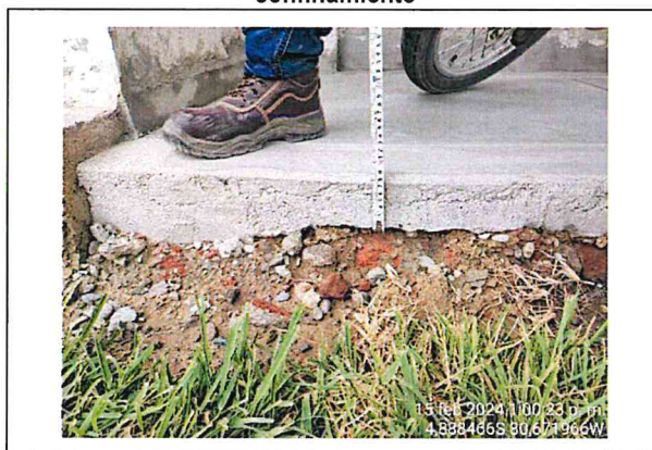
Vista Fotográfica n.º 17 Vereda con espesor inferior y sin uña de confinamiento
