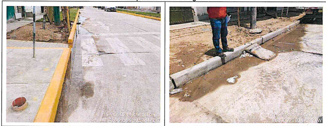
Vistas Fotográficas n.º 20 Empozamientos de agua
