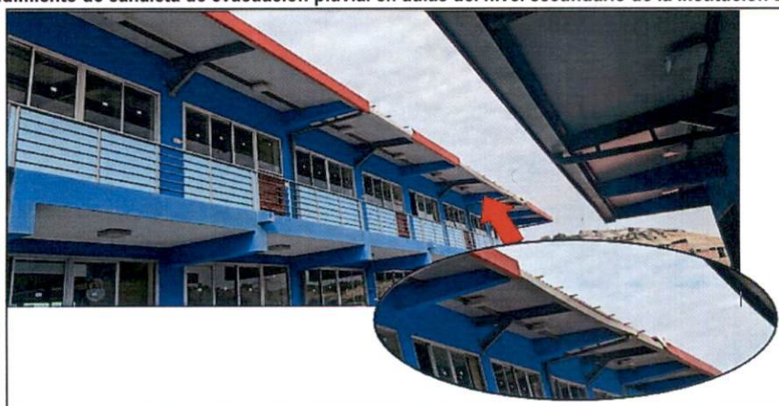
Toma Fotográfica n.º 38 Desprendimiento de canaleta de evacuación pluvial en aulas del nivel secundario de la Institución Educativa.
