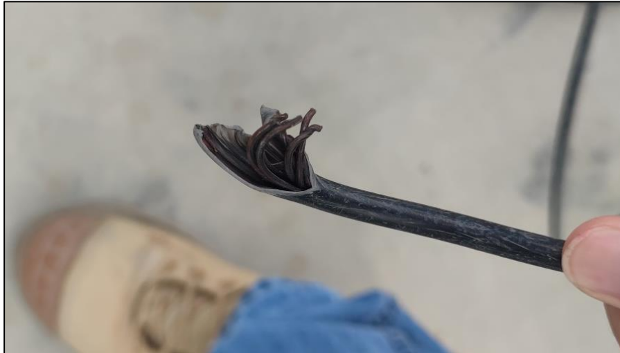
Imagen n.º 4 Conductor eléctrico roto aparentemente por una sobre tensión
