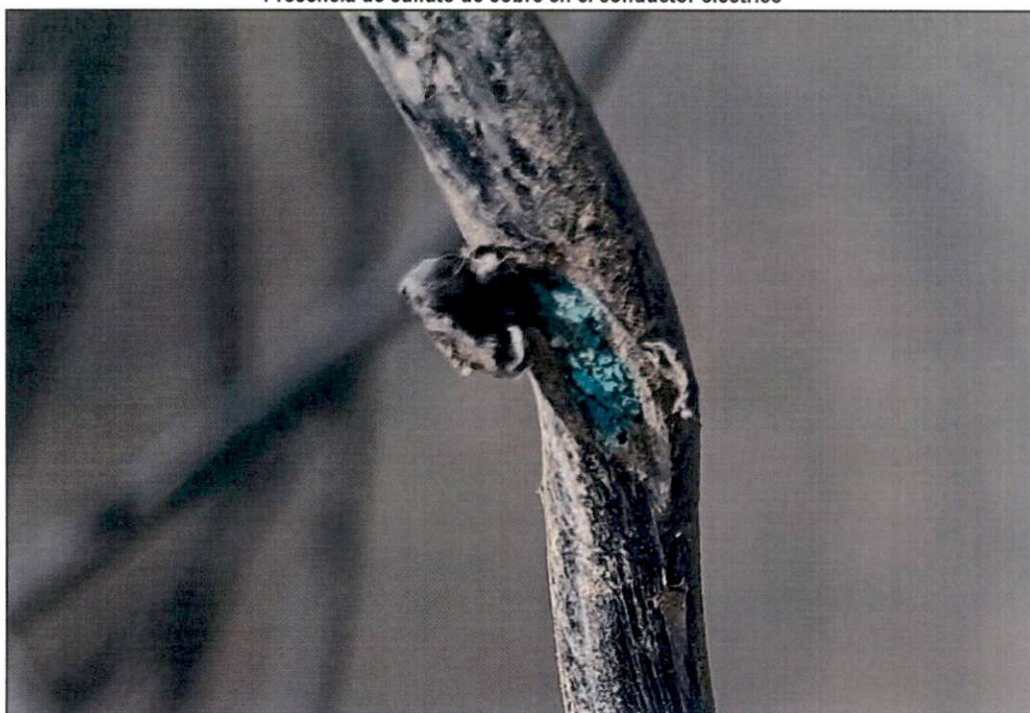
Toma Fotográfica n.º 5 Presencia de sulfato de cobre en el conductor eléctrico
