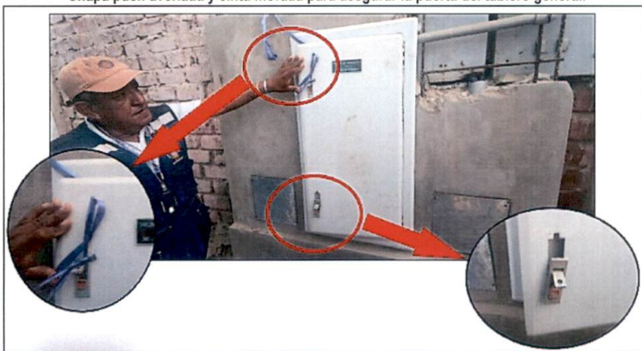
Toma Fotográfica n.º 2 Chapa push averiada y cinta morada para asegurar la puerta del tablero general.
