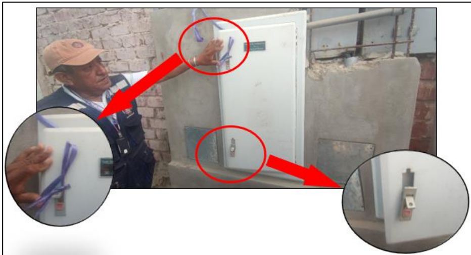
Imagen n.º 2 Chapa push averiada y cinta morada para asegurar la puerta del tablero general.
