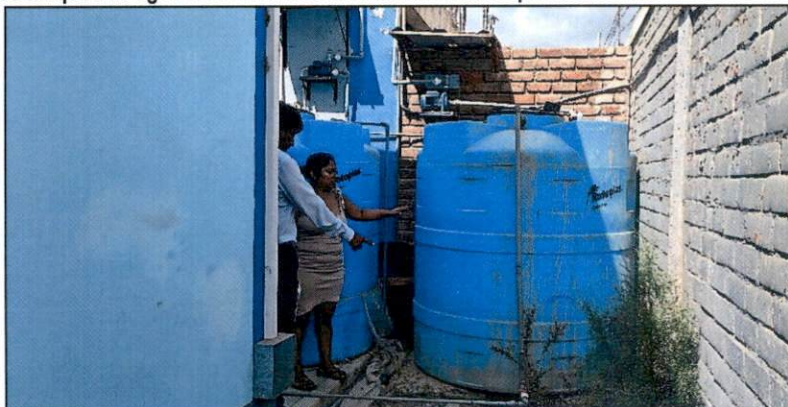
Toma Fotográfica n.º 34 Dos tanques de agua de 2 800 litros cada una instalados por las instituciones educativas
