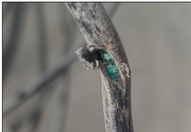
Imagen n.º 5 Presencia de sulfato de cobre en el conductor eléctrico
