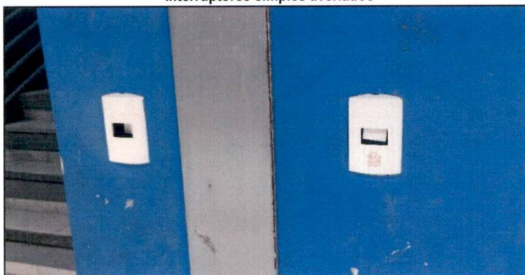
Toma Fotográfica n.º 14 Interruptores simples averiados
