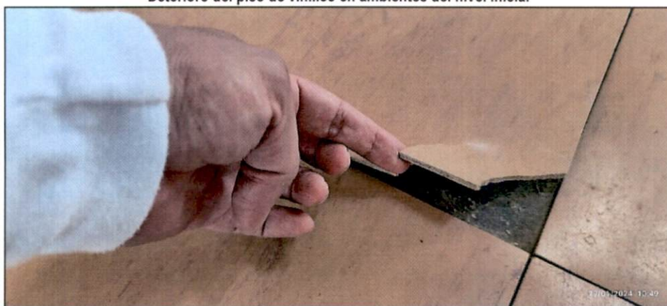
Toma Fotográfica n.º 52 Deterioro del piso de vinílico en ambientes del nivel inicial
