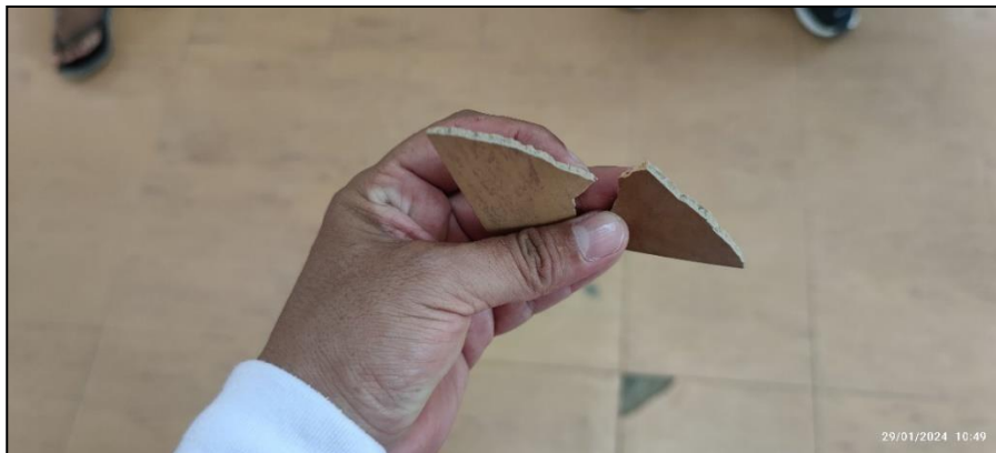
Imagen n.º 54 Deterioro del piso de vinílico en ambientes del nivel inicial
