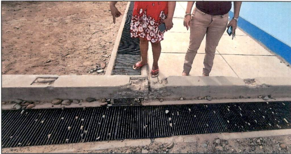
Toma Fotográfica n.º 46 Desprendimiento de barandas de seguridad en ambientes correspondientes al nivel inicial
