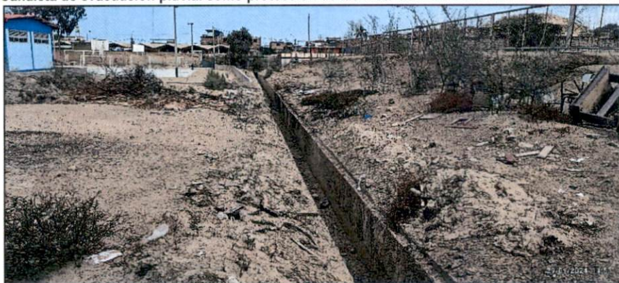
Toma Fotográfica n.º 16 Desprendimiento de la rejilla metálica en las canaletas de evacuación pluvial.
