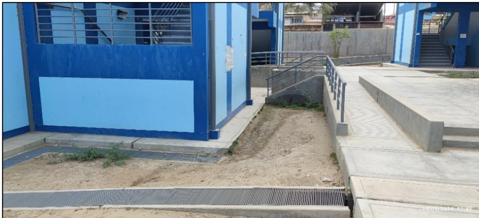
Imagen n.º 43 Humedecimiento en la escalera que une los ambientes de la Institución Educativa
