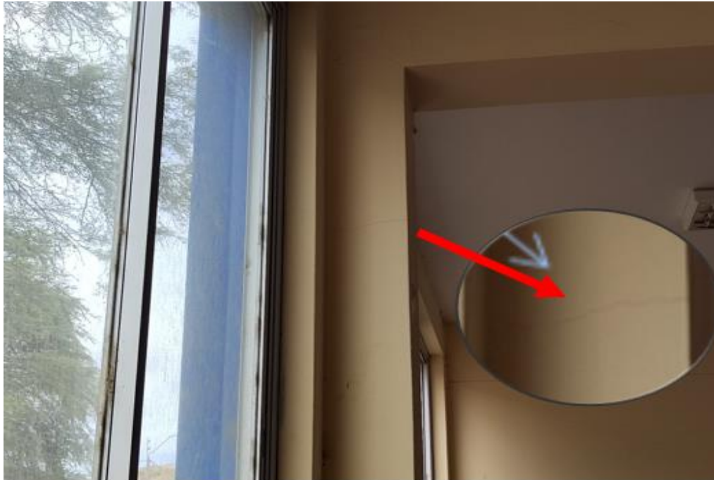
Imagen n.º 382 Presencia de fisuras en columna de aula del primer nivel
