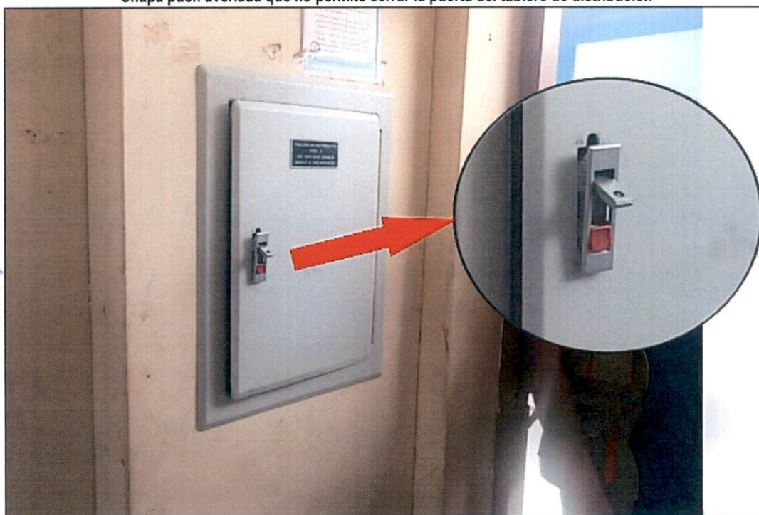
Toma Fotográfica n.º 12 Chapa push averiada que no permite cerrar la puerta del tablero de distribución
