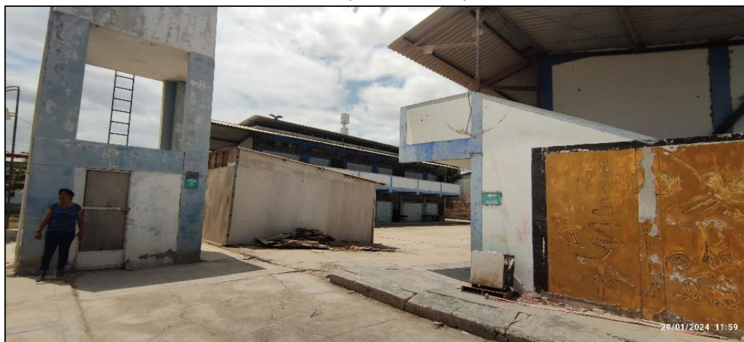
Imagen n.º 64 Estructuras próximas a colapsar
