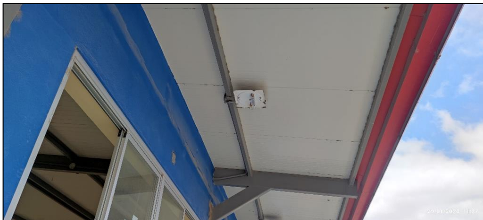
Imagen n.º 57 Luminarias sustraídas
