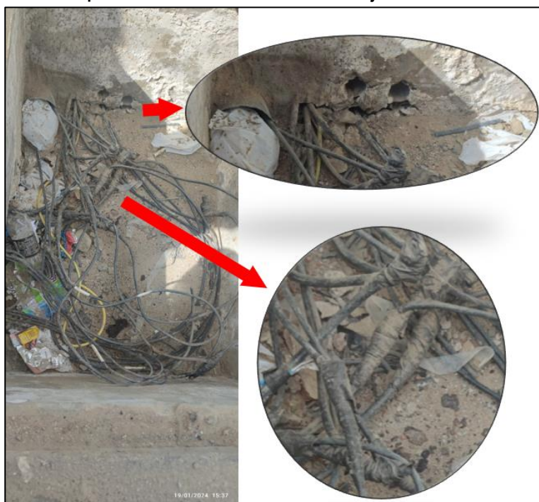
Imagen n.º 7 Empalmes de conductor eléctrico en la caja de derivación
