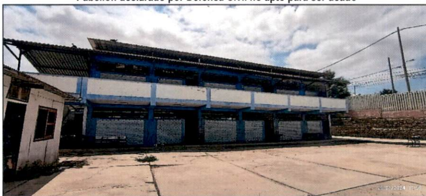
Toma Fotográfica n.º 28 Pabellón declarado por Defensa Civil no apto para ser usado
