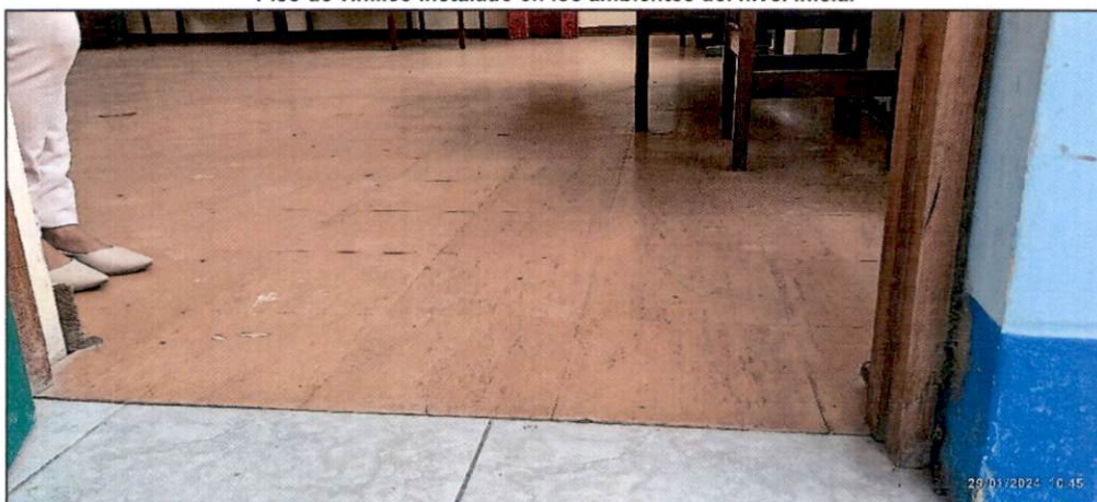
Toma Fotográfica n.º 49 En los ambientes del nivel inicial el piso de vinílico presenta grietas y desprendimientos
