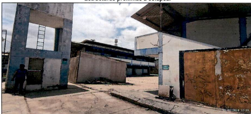
Toma Fotográfica n.º 26 Estructuras próximas a colapsar
