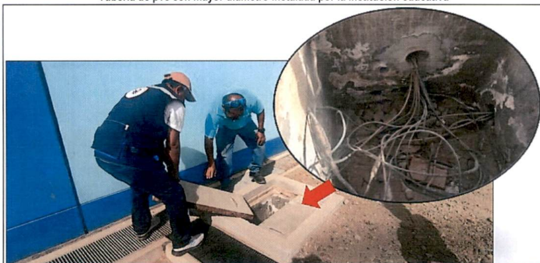
Toma Fotográfica n.º 9 Tubería de pvc con mayor diámetro instalada por la institución educativa
