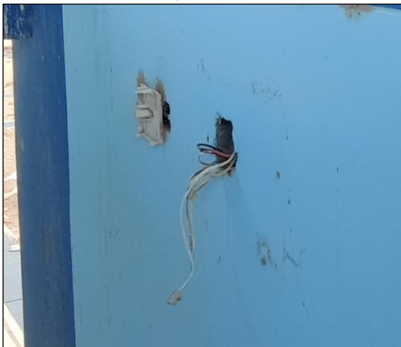
Imagen n.º 58 Interruptores sustraídos
