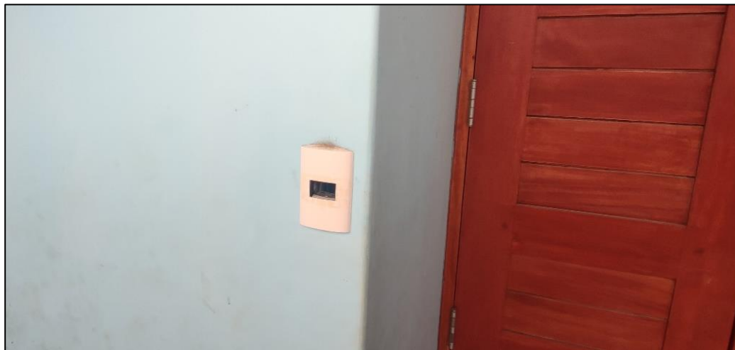
Imagen n.º 17 Interruptor simple averiado
