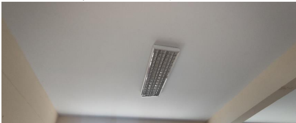
Imagen n.º 22 Rejilla de los fluorescentes desprendida del techo
