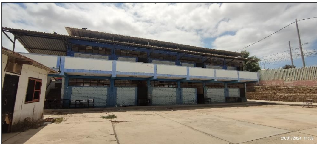
Imagen n.º 66 Pabellón declarado por Defensa Civil no apto para ser usado
