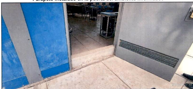
Toma Fotográfica n.º 4 Parapeto instalado en la puerta del ambiente informático
