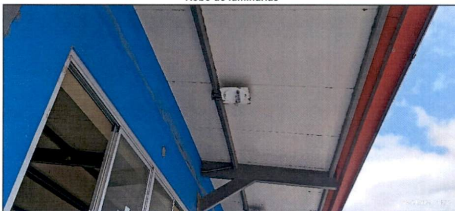
Toma Fotográfica n.º 19 Robo de luminarias
