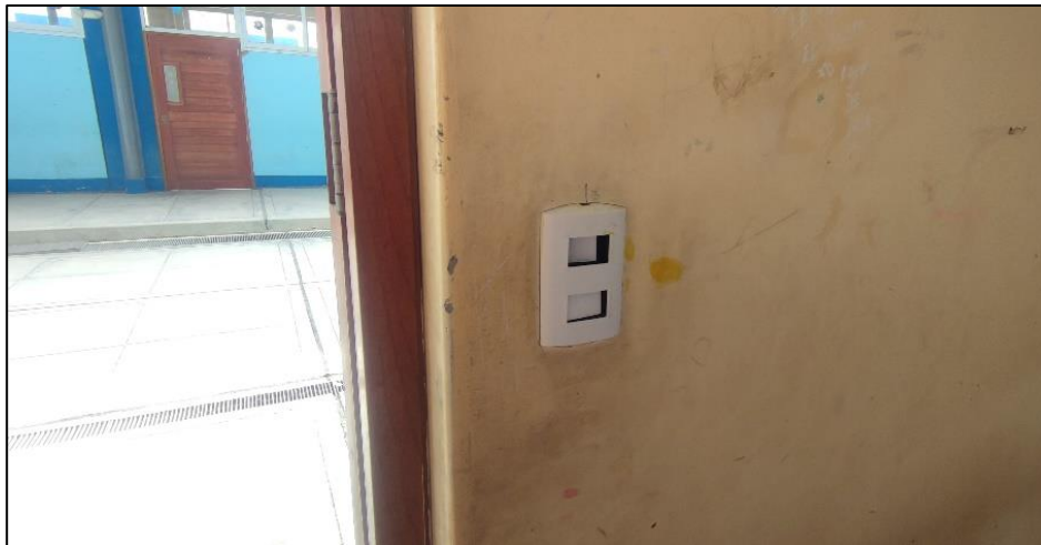
Imagen n.º 16 Interruptor doble averiado
