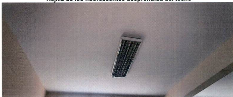
Toma Fotográfica n.º 22 Rejilla de los fluorescentes desprendida del techo
