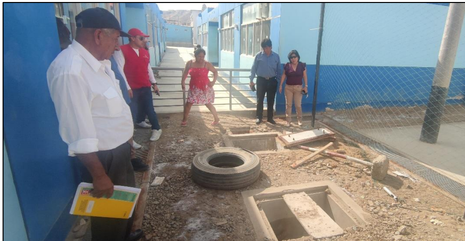
Imagen n.º 8 Caja de derivación eléctrica que se empozó durante las lluvias de 2023
