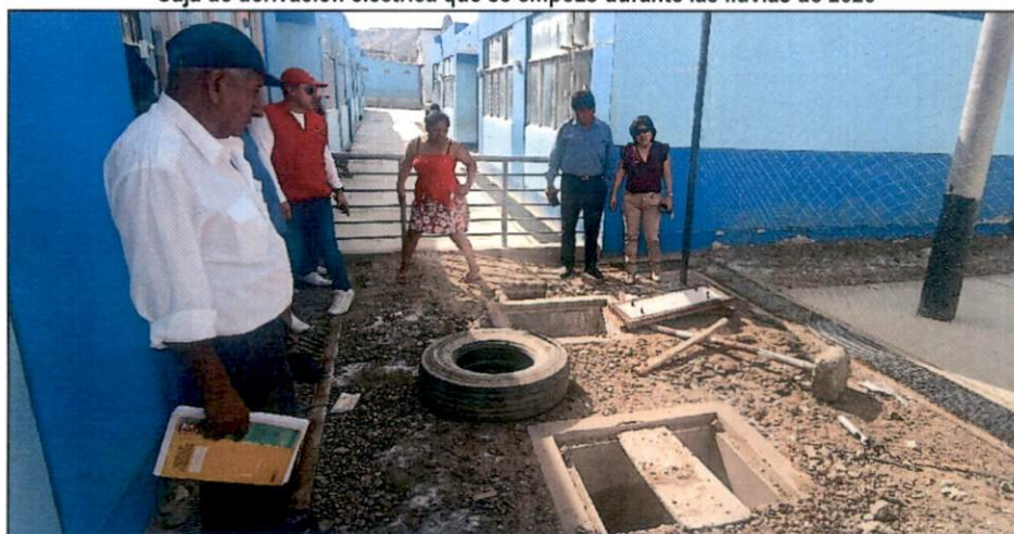
Toma Fotográfica n.º 8 Caja de derivación eléctrica que se empozó durante las lluvias de 2023
