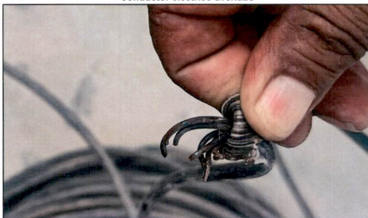
Toma Fotográfica n.º 3 Conductor eléctrico averiado
