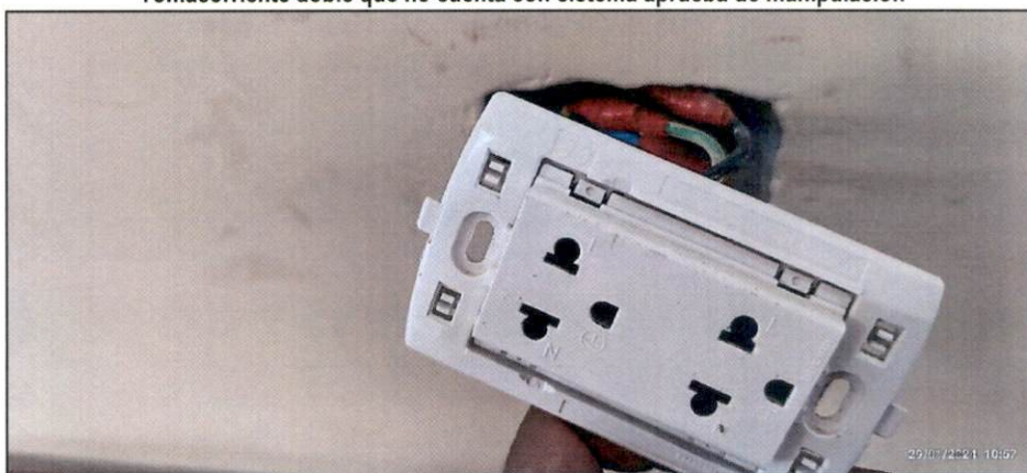
Toma Fotográfica n.º 21 Tomacorriente doble que no cuenta con sistema aprueba de manipulación
