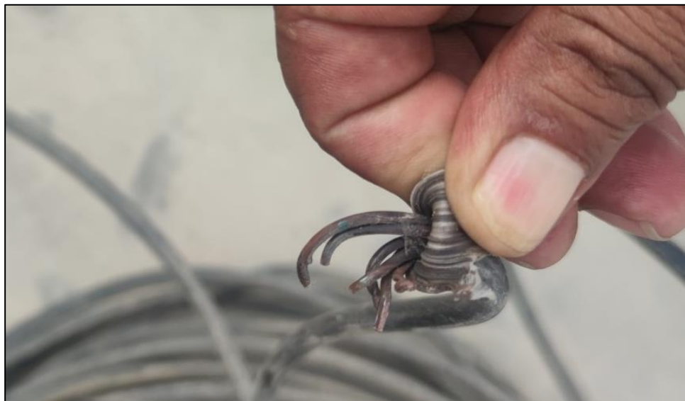
Imagen n.º 3 Conductor eléctrico averiado
