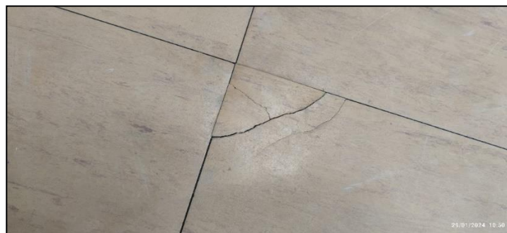
Imagen n.º 55 Deterioro del piso de vinílico por filtración de agua de lluvia en el techo de los ambientes del nivel inicial
