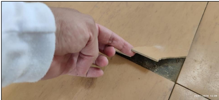
Imagen n.º 53 Deterioro del piso de vinílico en ambientes del nivel inicial
