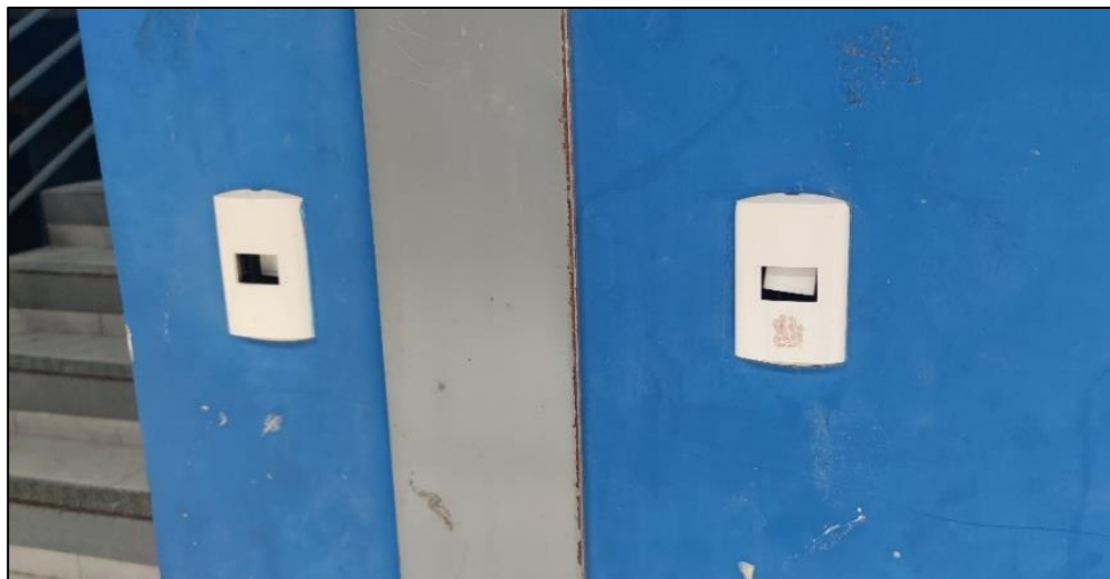
Imagen n.º 14 Interruptores simples averiados
