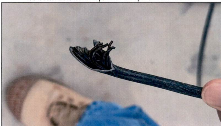
Toma Fotográfica n.º 4 Conductor eléctrico roto aparentemente por una sobre tensión
