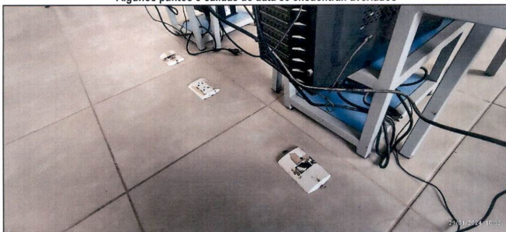
Toma Fotográfica n.º 31 Algunos puntos o salidas de data se encuentran averiados
