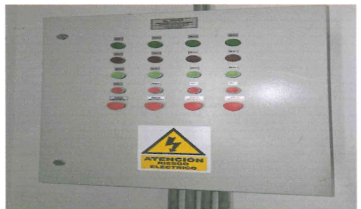
Fotografía 57. Instalaciones de tablero de fuerza para bombas de agua caliente en cuarto de bombas.
