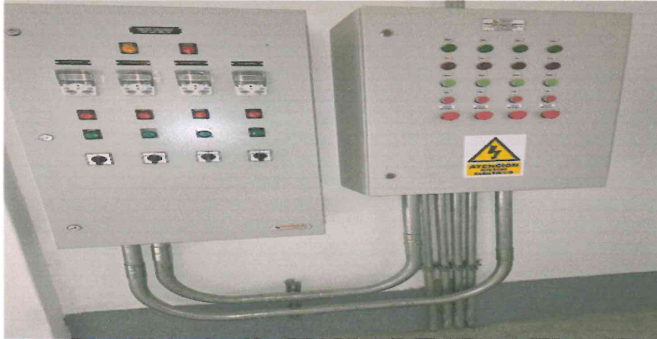
Fotografía 58. Instalaciones de tablero de alternador de presión constante y tablero de fuerza para bombas de agua potable en cuarto de bombas.
