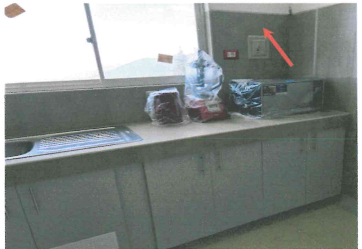
Fotografía 45. En comedor-cocina, se ha instalado horno microondas (E-86), licuadora (E-88), hervidor eléctrico (E-167), lavadero de acero (B-9), mostrador de madera para lavadero (MO-3). Se ha instalado mueble de madera bajo; sin embargo no se han colocado cajones (MO-6). No se ha instalado Mueble repostero alto (MO-11).
