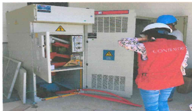
Fotografía 4. Verificación de instalación de celdas de llegada y protección, así como celda de transformación.
