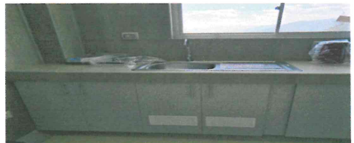
Fotografía 47. En comedor-cocina, se ha instalado lavadero de acero (B-9), mostrador de madera para lavadero (MO-3), cocina eléctrica (E-81). Se ha instalado mueble de madera bajo; sin embargo no se han colocado cajones (MO-6) y cuyas puertas no abren con facilidad. No se ha instalado Mueble repostero alto (MO-11).
