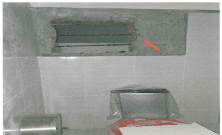
Fotografía 72. En baño de Ecograf. General u obstétrica se ha instalado Dispensador de papel higiénico con llave (E-7), papelera de plástico con tapa y ventana batible (M-14), inodoro de loza vitrificada con válvula fluxométrica (C-1) Se observa un forado en el muro por el que están expuestas 2 tuberías
