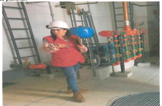
Fotografía 52. Instalaciones mecánico eléctrica y sanitarias de agua fría, caliente y blanda en cuarto de bombas.
