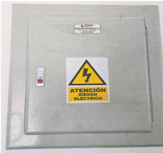
Fotografía 8. Sub tablero de distribución STD.
