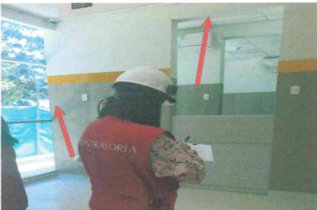
Fotografía 26. Área de caja no tiene señalización ni señalética colocada
