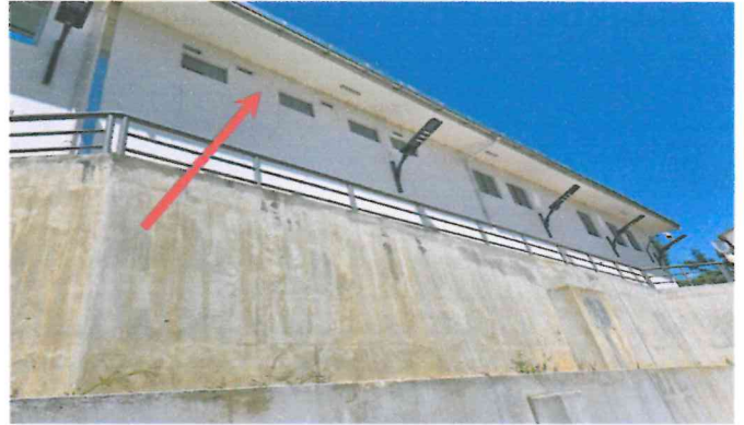
Fotografía 13. Malecón mirador, se observa manchas en encuentro de techo con muro, así como en muro perimetral .
