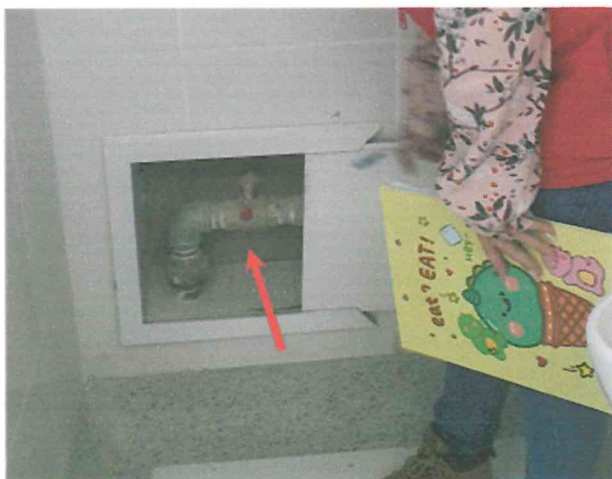
Fotografía 36. En baño personal hombres se observa que la manija de la válvula sobresale del límite de la caja de la válvula de control, por lo que la tapa no cierra por completo
