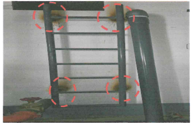
Fotografía 55. Instalaciones de escalera metálica en cuarto de bombas, se observa manchas de soldadura en muro.
