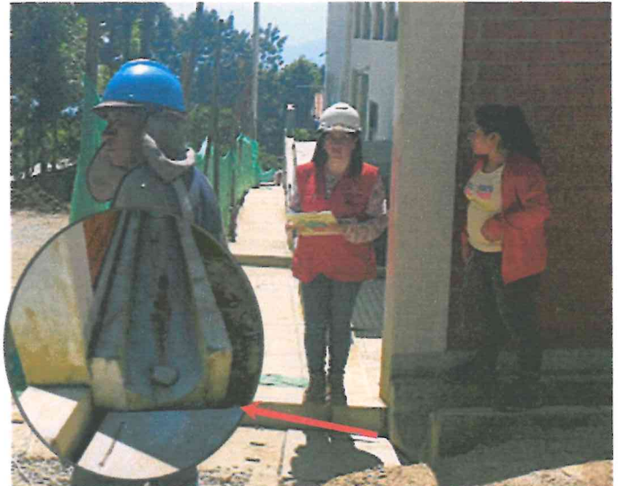
Fotografía 25. Cuneta de concreto para drenaje pluvial tiene nivel superior a vereda terminada.
