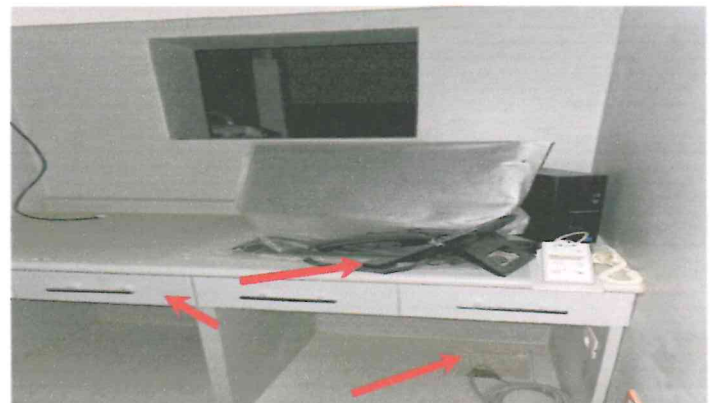
Fotografía 62. En comando de rayos X, se ha instalado teléfono de mesa (T-20) y se observa que se encuentra expuesto, desconectado y sin protección, así también el equipo de cómputo. En el mueble de madera instalado se observó que los cajones no abren con facilidad. El piso tiene salida de cableado sin resanar
