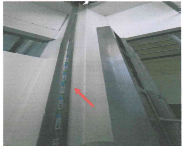
Fotografía 60. Se observa montante de tubería PVC de 3" de diámetro, la cual no presenta ningún tipo de fijación a muro
