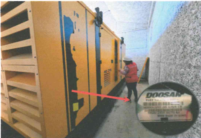
Fotografía 19. Grupo electrógeno MD 315 I con cabina
