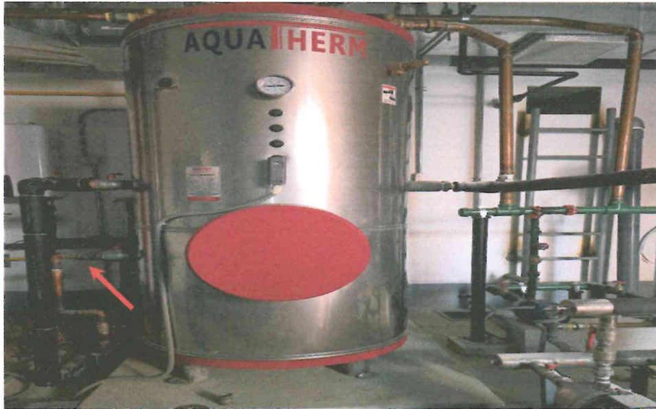
Fotografía 53. Instalaciones mecánico eléctricas y sanitarias de agua caliente en cuarto de bombas.
