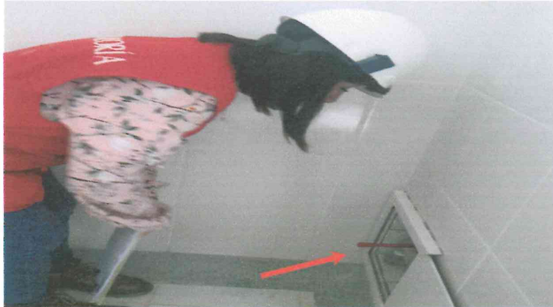
Fotografía 38. En baño personal mujeres se observa que la manija de la válvula sobresale del límite de la caja de la válvula de control, por lo que la tapa no cierra por completo
