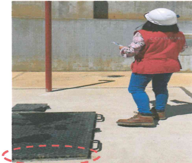
Fotografía 14. Se observa corrosión en tapa metálica de sistema de combustible
