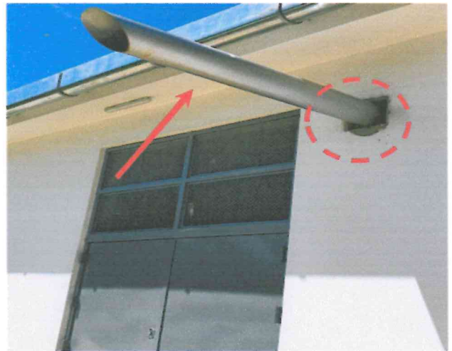
Fotografía 15. Salida de ventilación de cuarto de grupo electrógeno, presenta espacios que no abarcan el contorno del tubo.
