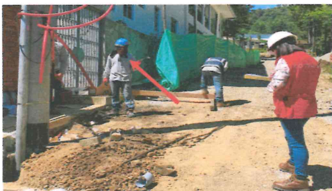
Fotografía 3. Se observa personal sin EPP completo, se colocaron guantes; sin embargo, no utilizan mascarillas.
