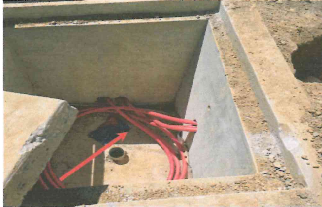
Fotografía 7. Acometida media tensión
