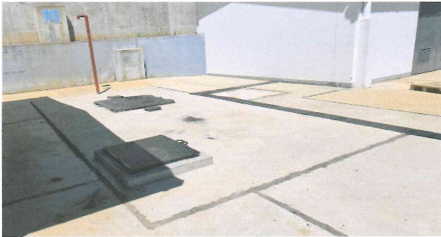
Fotografía 18. Sistema de combustible terminada con losa de concreto, tapas metálicas, tubo ventilación y juntas asfálticas.
