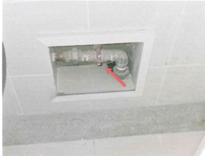
Fotografía 73. . En baño de Ecograf. General u obstétrica se observa que la manija de la válvula sobresale del límite de la caja de la válvula de control, por lo que la tapa no cierra por completo
