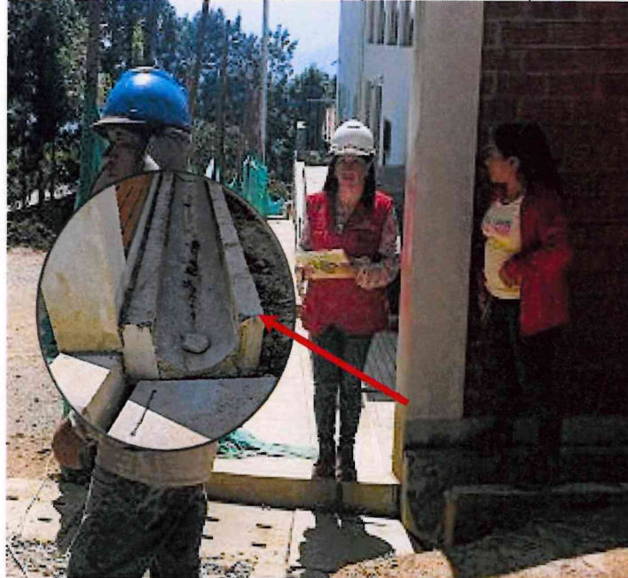
Fotografía n.° 6. Cuneta de concreto para drenaje pluvial tiene nivel superior a vereda terminada
