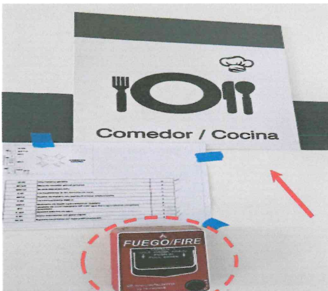
Fotografía 44. En comedor-cocina se ha colocado señalética pero no señalización de seguridad
