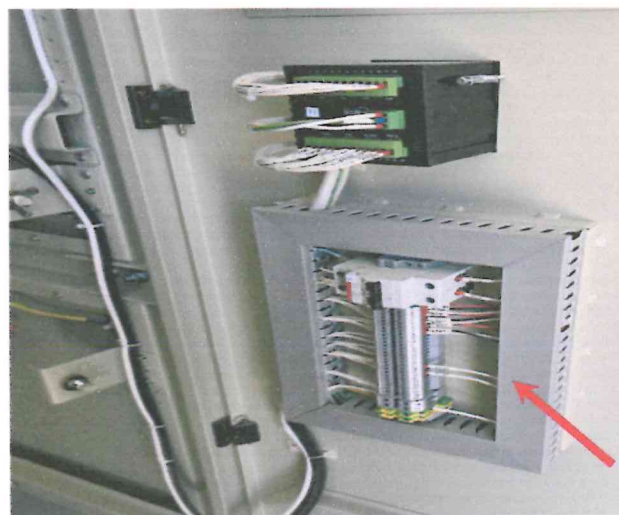
Fotografía 6. Verificación de celda de transformación
