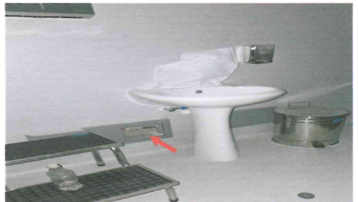
Fotografía 67. En ambiente de Ecograf. General u obstétrica se ha instalado lavamanos de loza vitrificada (A-3), dispensador de jabón y papel toalla (O-2 y O-3). Se observa que la manija de la válvula sobresale del límite de la caja de la válvula de control, por lo que la tapa no cierra por completo
