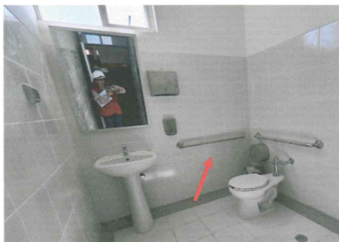
Fotografía 35. Baño de discapacitados, se ha instalado espejo (H-1a), lavamanos (A-3), inodoro (C-1a), papelera (M-14), dispensador papel higiénico (E-7), dispensador papel toalla (E-55), barandas de acero (O-2 y O-3) .
