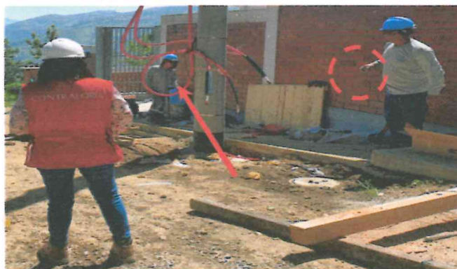
Fotografía 2. Ejecución de trabajos de instalación de media tensión, se observa personal sin EPP completo, sin guantes y mascarillas.
