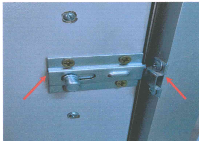
Fotografía 37. En baño personal hombres se observa mala instalación de cerrojo en puerta tipo P-4
