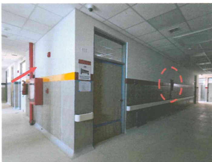
Fotografía 34. En corredor de servicio de UPS urgencia y emergencia no se ha colocado señalética y se observa corte en pared no resanado.
