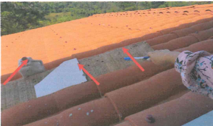
Fotografía 51. Se observa residuos sólidos sobre techo de teja andina.
