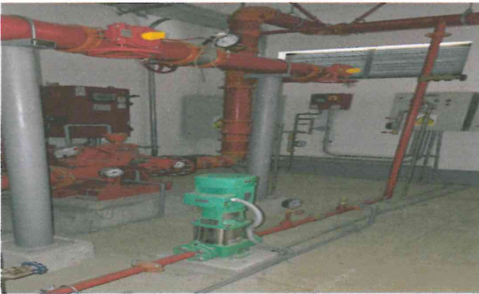
Fotografía 54. Instalaciones mecánico eléctricas y sanitarias de agua contra incendio en cuarto de bombas.
