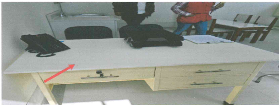
Fotografía 33. Sala de inmunizaciones, se ha instalado mesa (M-28), sillas (M-34), lavamanos con grifería convencional (A-3) y mueble bajo para instalar lavadero (MB-3a) . No se ha instalado pizarra acrílica (M-33), equipo de sonido (T-6), blu ray (T-14), televisor (T-16), reloj de pared (T-79) computadora personal (T-50)
