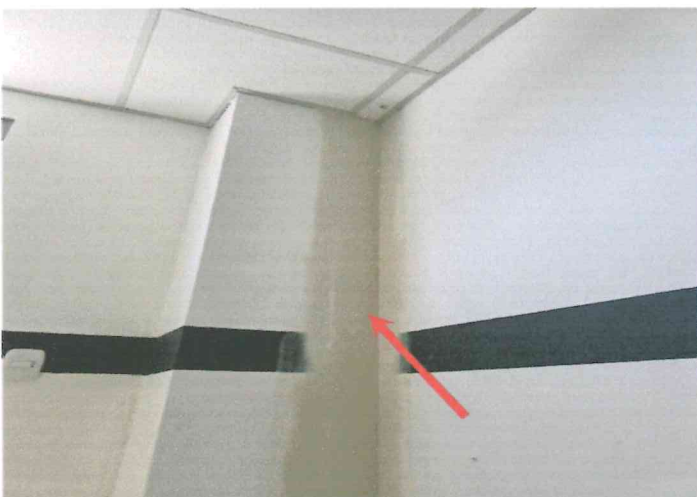
Fotografía 41. Depósito o almacén, se observa resane en esquina de columna, pendiente de pintura
