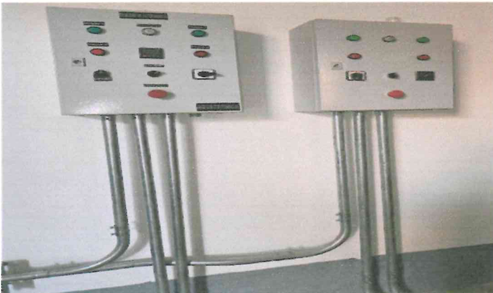
Fotografía 56. Instalaciones de tablero de alternancia en cuarto de bombas.
