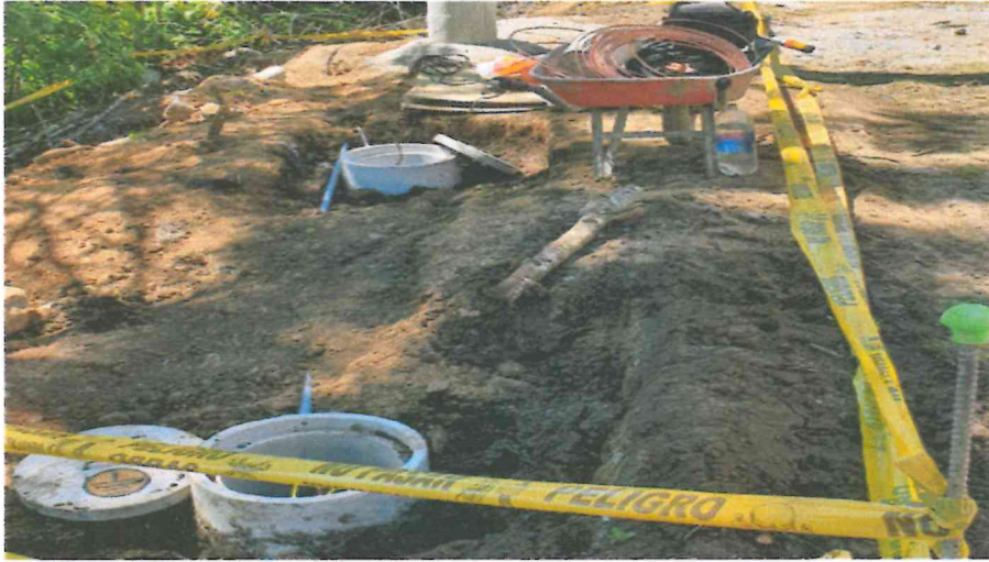
Fotografía 23. Instalaciones de pozos con puesta a tierra.
