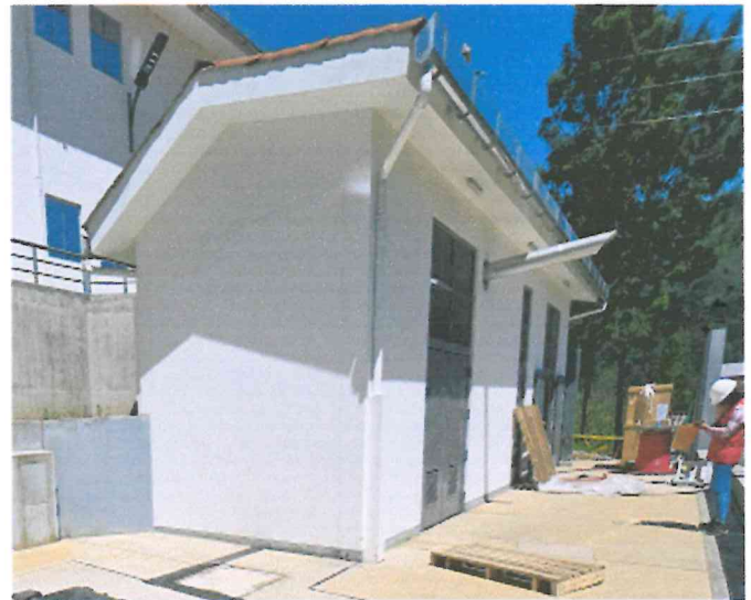
Fotografía 17. Vista de subestación para media tensión trifásica.
