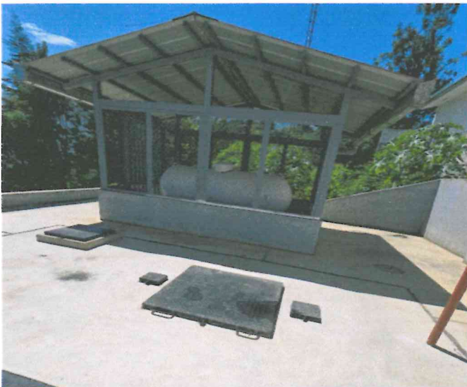
Fotografía 16. Vista de caseta con tanque de petróleo instalado
