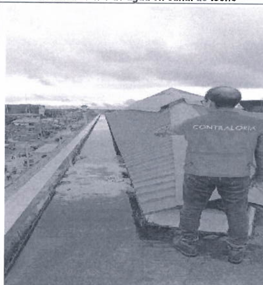
Imagen n.º 14 Estancamiento de agua en canal de techo
