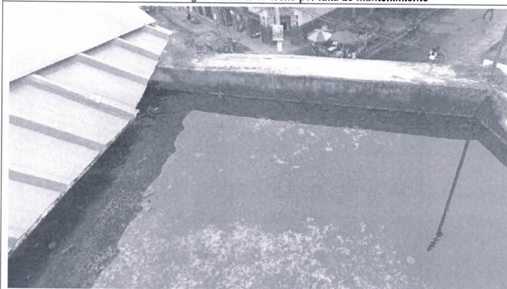
Imagen n.º 15 Estancamiento de agua en canal de techo por falta de mantenimiento
