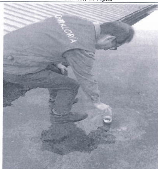
Imagen n.º 13 Obstrucción de rejilla
