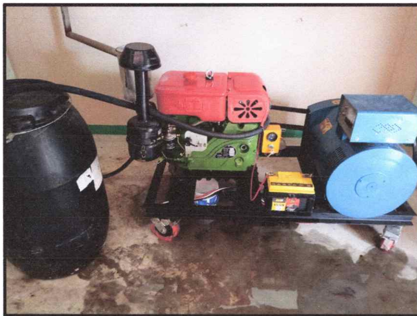
FOTO N° 15.- EXISTE FUGA DE PETRÓLEO EN GRUPO ELECTRÓGENO
