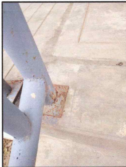
FOTO N° 05.-SE OBSERVA QUE LA BASE DE LOS TUBOS SE ENCUENTRAN OXIDADOS.
