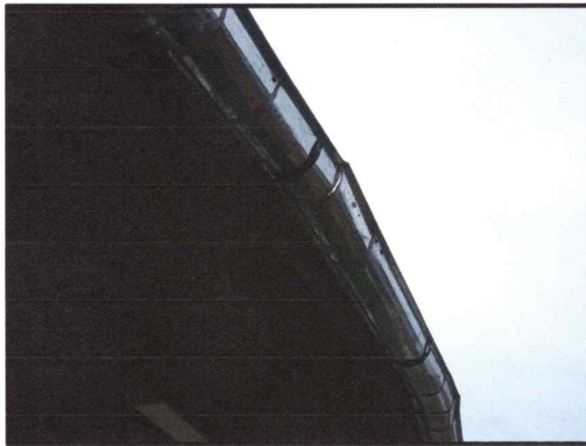
FOTO N° 13.- CANALETA DE EVACUACIÓN PLUVIAL SE ENCUENTRA DESPRENDIDO
