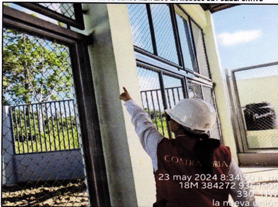
IMAGEN N° 3 FALTA DE RESANE EN ANCLAJE DE CERCO METÁLICO EN MÓDULO DE POLIDEPORTIVO
