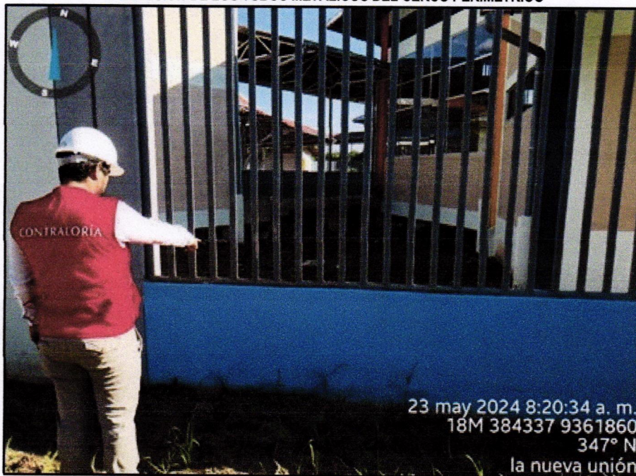
IMAGEN N° 1 CORROSIÓN DE LOS TUBOS METÁLICOS DEL CERCO PERIMÉTRICO
