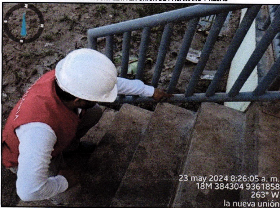
IMAGEN N° 2 SOLDADURA INCOMPLETA EN UNIÓN DE PASAMANO Y REJAS
