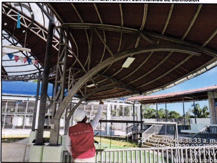
IMAGEN N° 4 COBERTURA DE ESTRUCTURA METÁLICA LIVIANA CON INDICIOS DE CORROSIÓN
