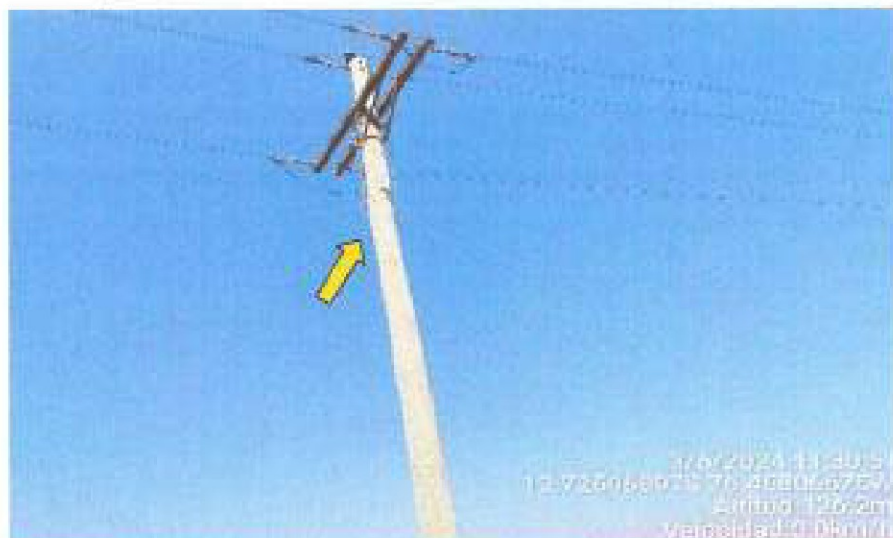
Foto 57. Cable de retención de estructura de MT cortado, Coaylla, provincia de Cañete, coordenada: 12.72593973; -76.45806675.
