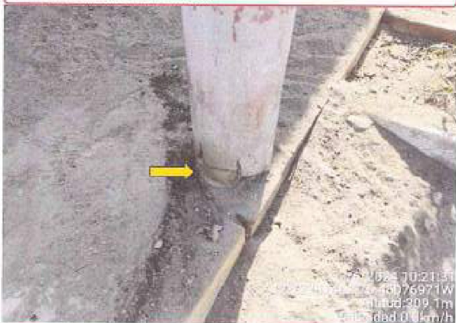
Foto 21. Base de poste de BT en mal estado, Coaylla, provincia de Cañete, coordenada: 12.72803482; -76.46101778
