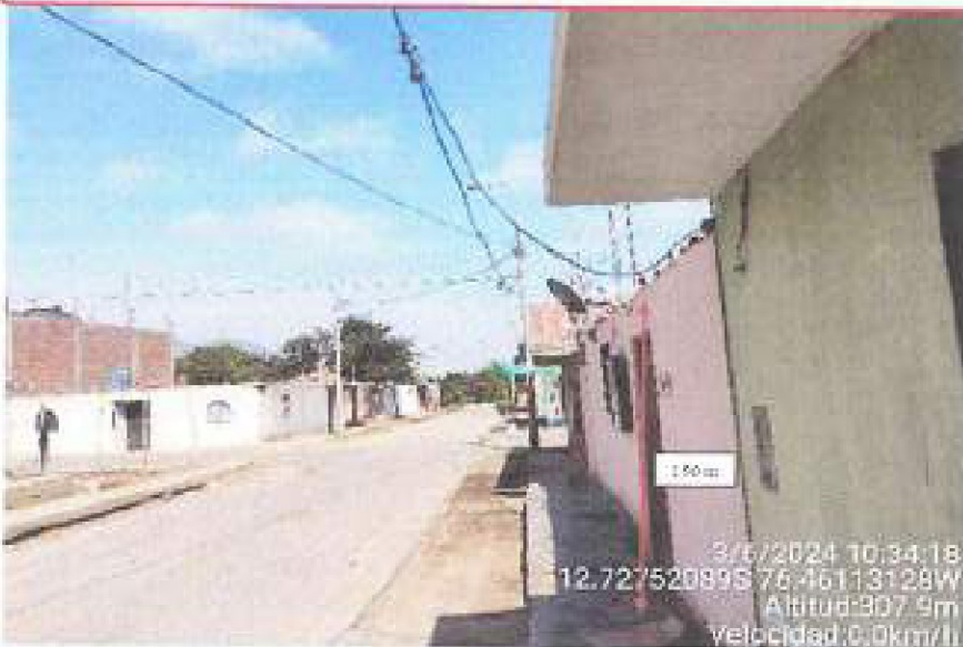
Foto 32. Conductor de acometida a 1.90 m de distancia vertical de la vereda, Coaylla, provincia de Cañete, coordenadas: -12.72752089S - 76.46113128W.
