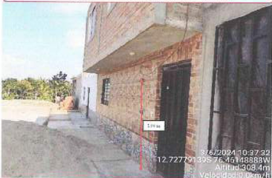
Foto 34. Conductor de acometida a 1.00 m de distancia vertical de la vereda, Cayullo, provincia de Cañete, coordenadas: -12.72779139; -76.46148888
