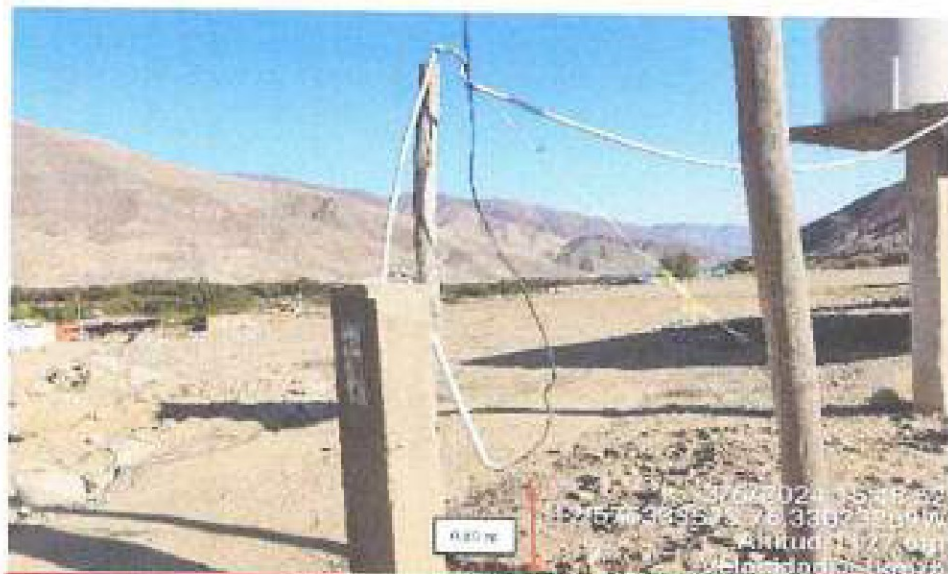
Foto 103. Conductor de acometida a 0,80 m del suelo, anexo Unchor, provincia de Cañete, coordenada: 12.57533357; 76.33023269.
