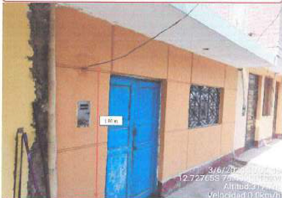
Foto 12. Conductor de acometida a 1,60 m de altura del Portal de la vivienda, Coayllo, provincia de Cañete, coordenadas: -12.727655; -76.45746087.
