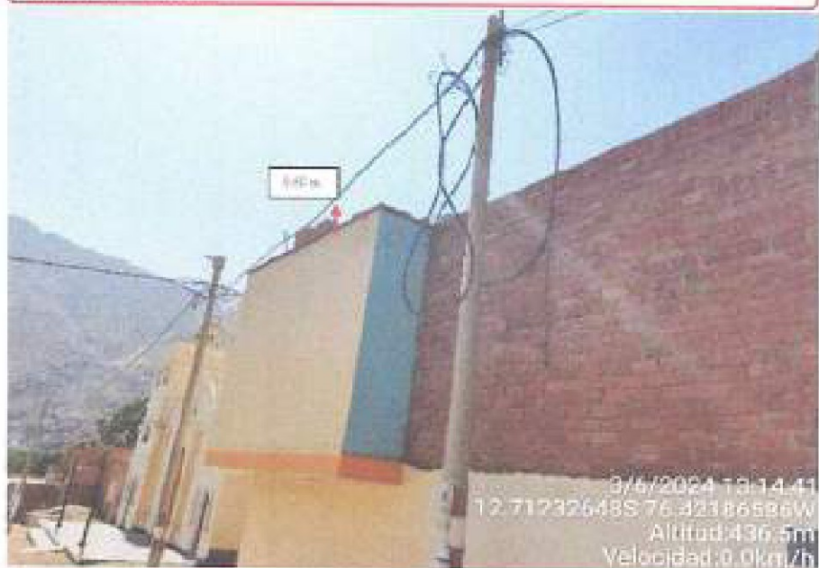
Foto n.º 72. Conductor de BT sobre edificación a 3.00 m de la distancia vertical, anexo Uquira, provincia de Cuzco, coordenada: 12.71232648; -76.42186586.
