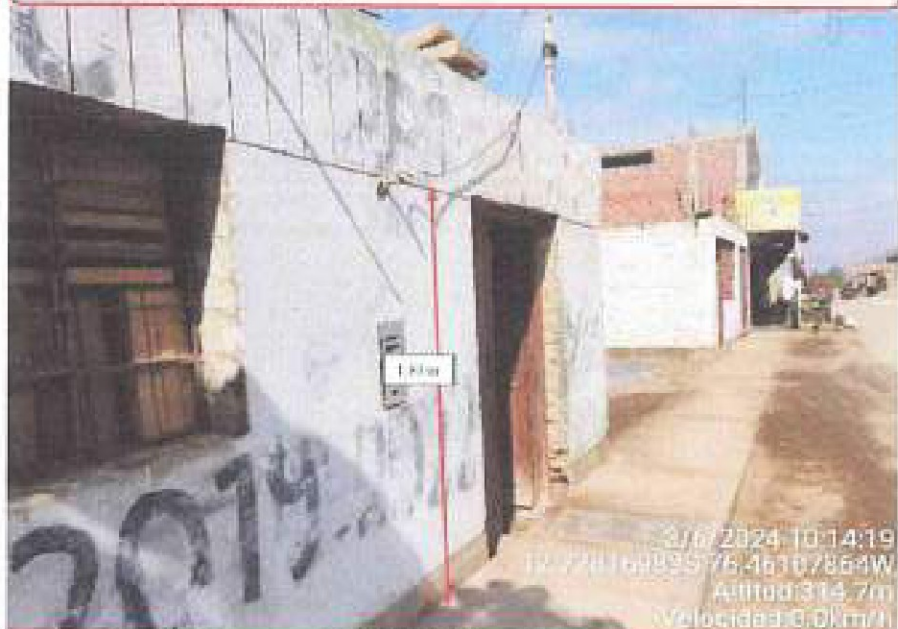
Foto 20. Conductor de acometida a 1.80 m de distancia vertical de la vereda, Coaylla, provincia de Cañete, coordenada: -12.72816995; -76.46107864
