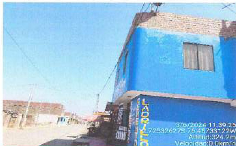
Foto 59. Conductor de BEI rojo con pared de edificación. Coayllo, provincia de Canete, coordenadas: 12.72532627; -76.45733122.
