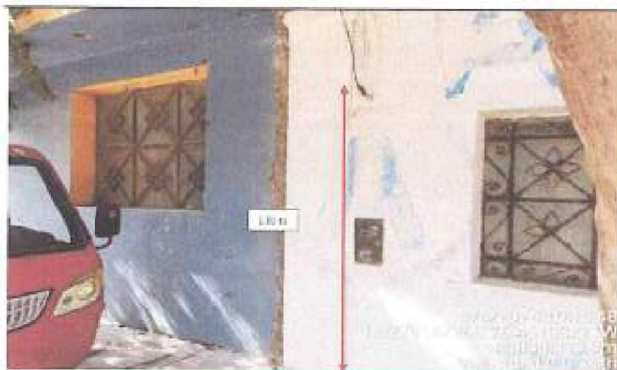
Foto 19. Conductor de acometida a 1.80 m de distancia vertical de la vereda, Coaylla, provincia de Cañete, coordenada: -12.72814756; -76.46103271
