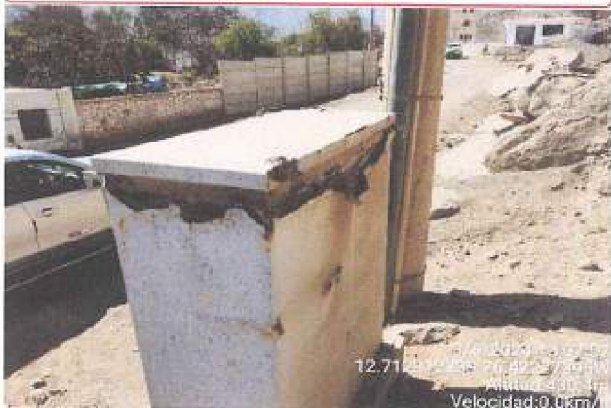
Foto 66. Tablero de distribución de SED por corrosión, nueva Uquira, provincia de Cabelo, coordenadas: -12.71281233; -76.42277395.
