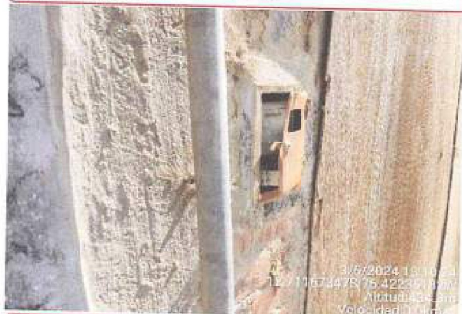
Foto 68: Caja portamedidor con tapa abierta, anexo Uquira, provincia de Cañete, coordenada: -12.711673447; -76.42235182.
