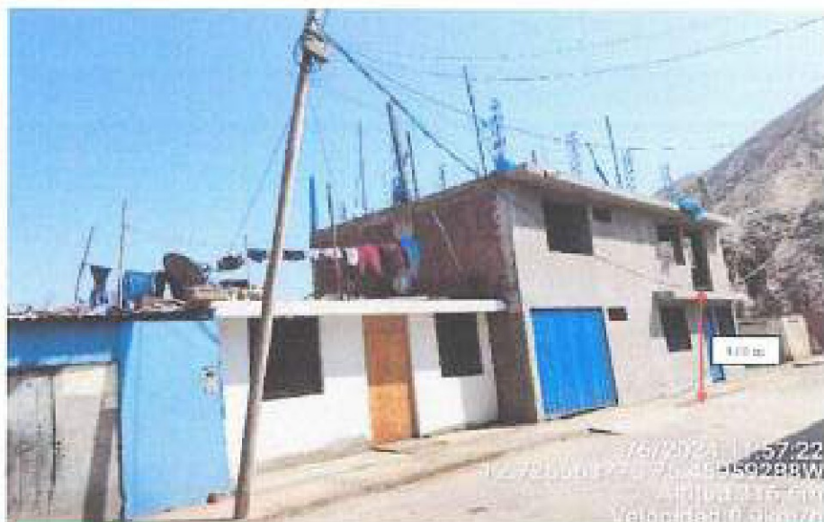
Foto 61. Conductores de DT a 3,00 m del piso. Caylla, provincia de Caete, coordenada: -12.7266077; -76.4599288
