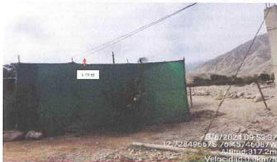
Foto 11. Conductor de BT sobre vivienda 6,20 m de distancia vertical, Coayllo, provincia de Cañete, coordenadas: -12.72849667; -76.45746087.
