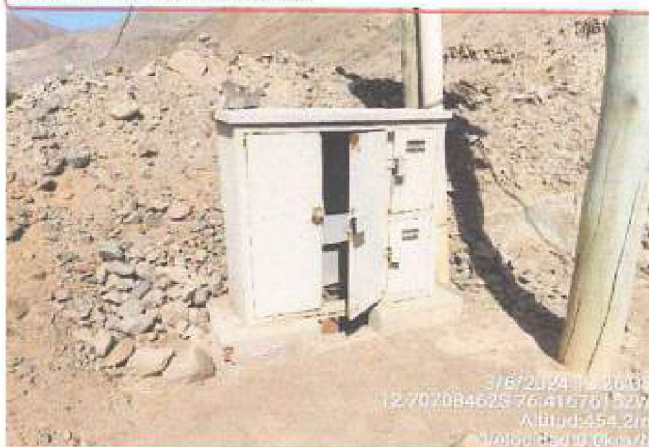
Foto 76. Tablero de distribución con los puertos abiertos, partes energizadas accesible, anexo Santiago La Venera, provincia de Cañete, coordenada: -12.70709021^{\circ} -76.41674215^{\circ} .
