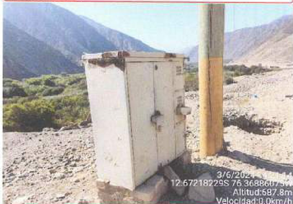
Foto 92. Tablero de distribución de SED en mal estado, anexo Santiago La Yevera, provincia de Cañar, coordenada: -12.67218229; -76.36886075. Página 68 de 78
