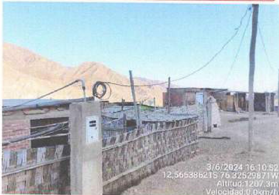
Foto 112. Conductor de acometida a 1,60 m del suelo, anexo Callangas, provincia de Cañete, coordenada: -12.56638621; -76.32529871.
