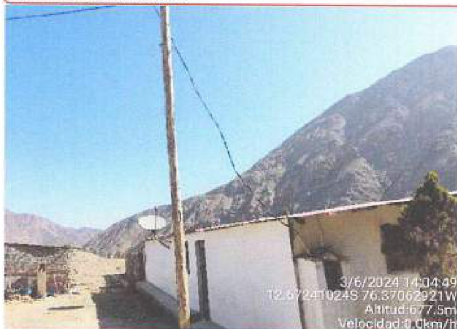
Foto 88. Conductor de acometida cruz con borde de techo metálico, anexa Santiago La Yevera, provincia de Cañete, coordenada: -12.67241024; -76.37062921.
