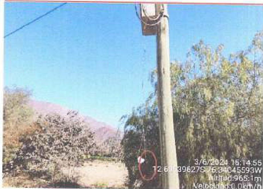
Foto n.º 98. Interruptor termomagnético colado a 1.50 m de distancia vertical del suelo, anexo Cabaño, provincia de Cabaño, coordenada: 12.64639827; 76.34045593.
