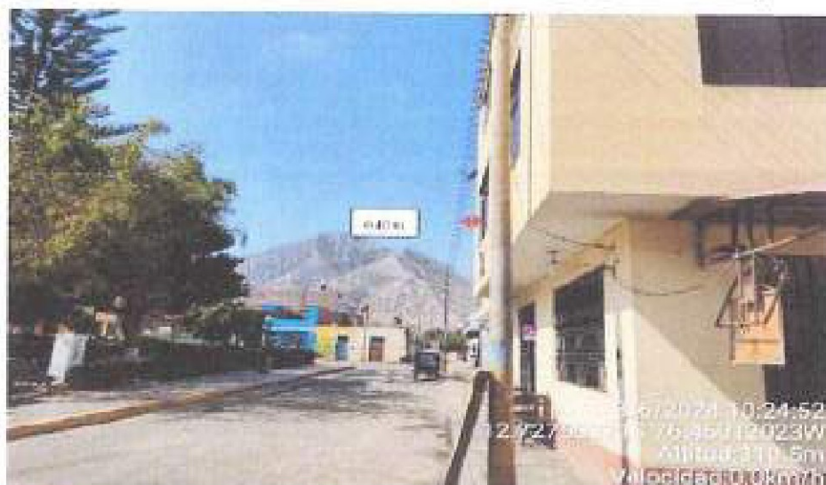
Foto 27. Conductor de BT tipo CPI a 0.40 m de ventana de una edificación, Coaylla, provincia de Cañete, coordenada: -12.72741058; -76.46012013.
