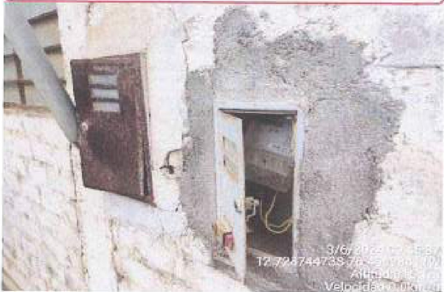
Foto 08. Tapa de caja portamedidor abierta. Coaylla, provincia de Cañete, coordenada: -12.72874473; -76.45829411.
