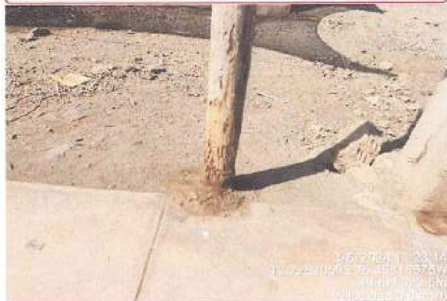
Foto 54. Poste de palo que soporta en mal estado, Coaylla, provincia de Cañete, coordenada: -12.72580590; -76.45815575.
