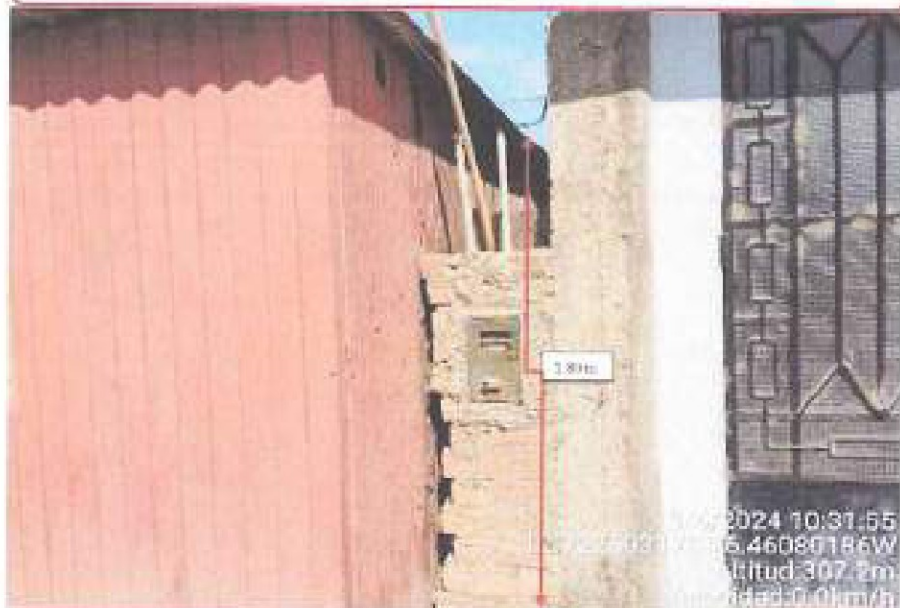
Foto 30. Conductor de acometida a 1.80 m de distancia horizontal y 0.50 m de distancia vertical de la vereda, Coayllo, provincia de Cusco, coordenadas: -12.72750317; -76.46080186.
