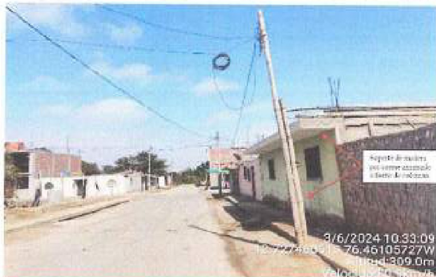
Foto 31. Proteja palo por cable, amarrado a torre de columna de edificación, Coaylla, provincia de Cañete, coordenadas: -12.7174609S - 76.4610572W.
