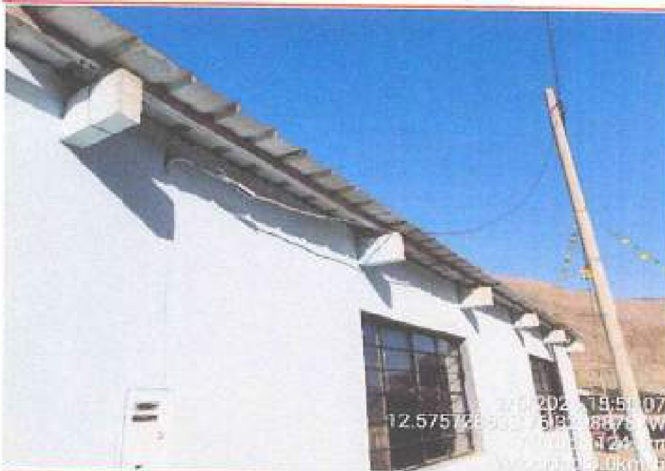
Foto 104. Conductor de acometida roza con borde de techo metálico, anexo Unchor, provincia de Cañete, coordenada: 12.57572863; 76.32988787Página 74 de 78
