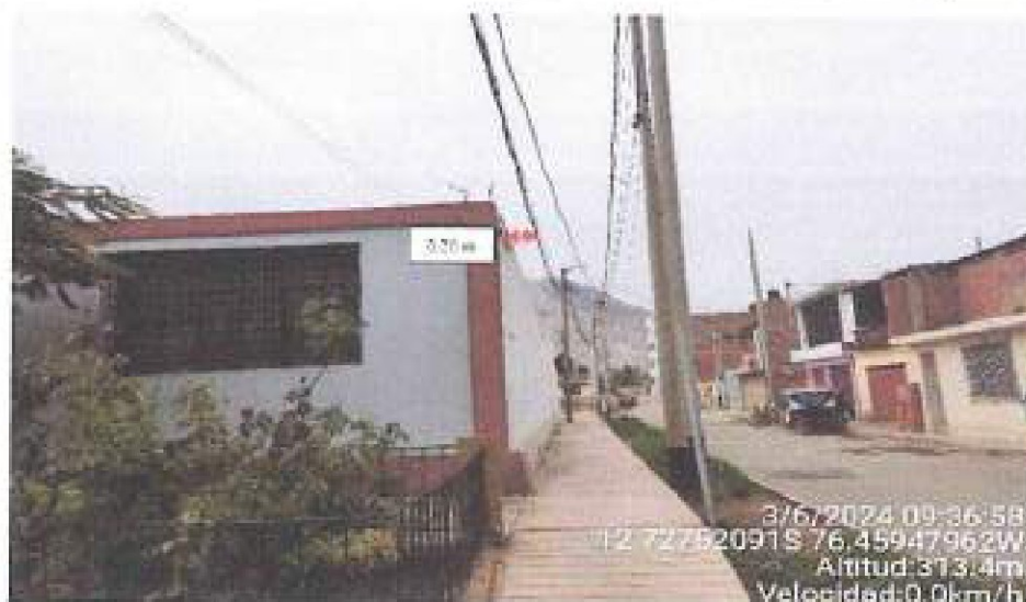
Foto 03. Conductor autoportante a 0.20 m de pared de edificación, de IE Francisco Bolognesi, Cayallo, provincia de Cajete, coordenadas: 12.72752091S - 76.45947962.
