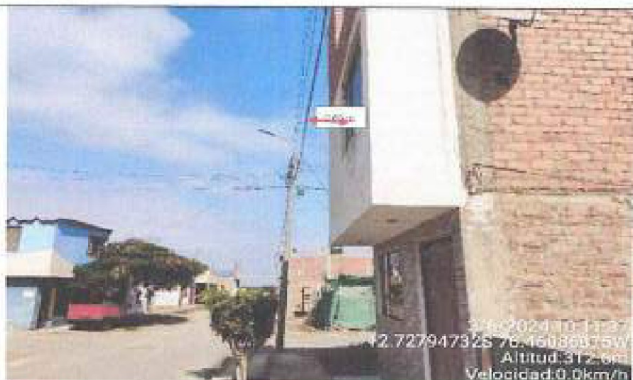
Foto 17. Conductor de BT acompañante a 0.60 m de ventana de edificación, Coaylla, provincia de Canete, coordenadas: -12.72794732; -76.46086875.
