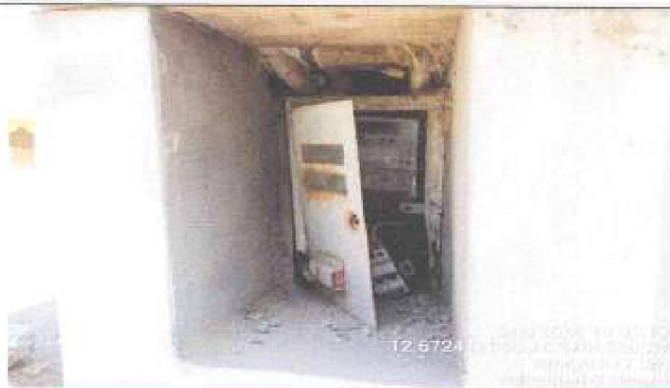
Foto 88. Caja portamedidor con tapa abierta, anexo Santiago La Yezra, provincia de Cañete, coordenadas: -12.67241296; -76.37065385.
