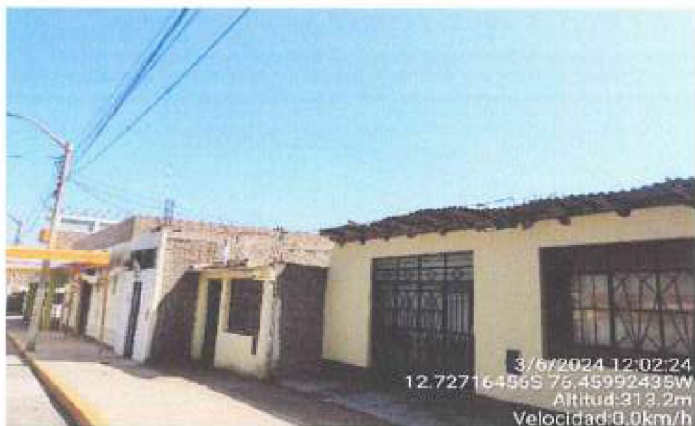
Foto 63. Conductor de arametida en contacto con techo tipo Eternit, Coaylla, provincia de Caete, coordenada: 12.72716456; 76.45992435.
