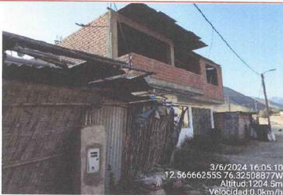
Foto 110. Conductor de acometida roza con parte metálica de techo, anexo Callangas, provincia de Cañete, coordenada: -12.56666255; -76.32508877
