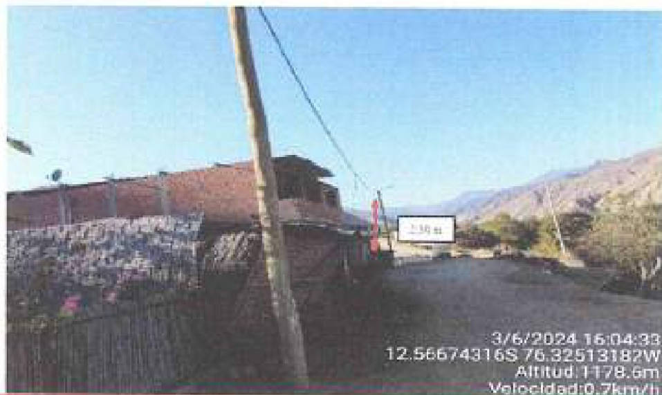
Foto 109. Conductor de BT autoportante sobre techo de vivienda a 2.50 m de distancia vertical, anexo Callangas, provincia de Cañete, coordenada: -12.56674316; -76.32513182.
