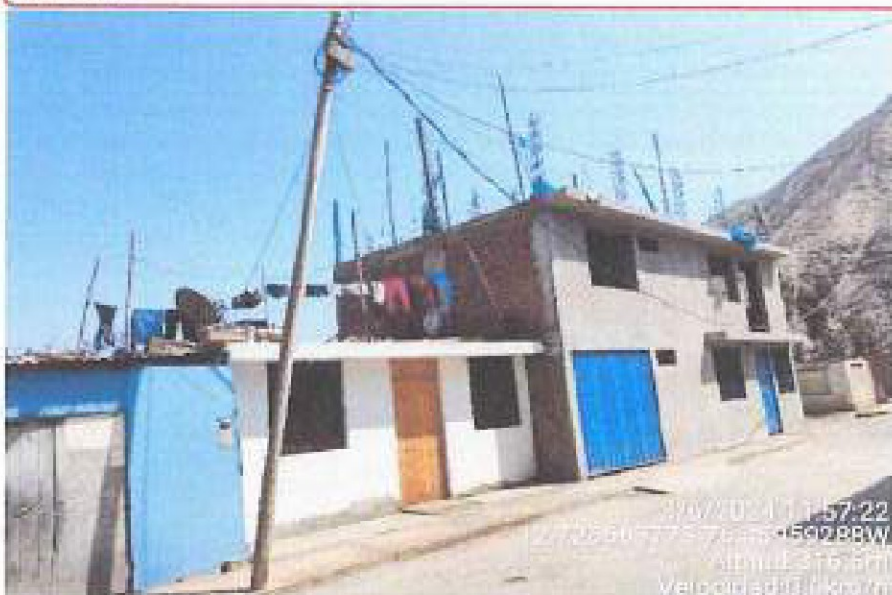
Foto 62. Poste inclinado 6°. Caylla, provincia de Caete, coordenada: -12.7266077; -76.4599288
