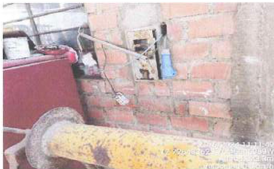
Foto 53. Caja portamedidor con tapa abierta, Coaylla, provincia de Cañete, coordenada: -12.72543362; -76.45846959.
