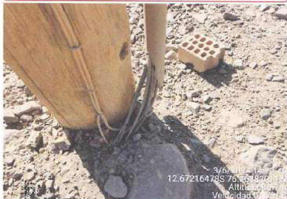
Foto 94. Conductor de BT expuesto en el suelo, anexo Santiago La Yesera, provincia de Cañete, coordenada: 12.67216478; -76.36386075.
