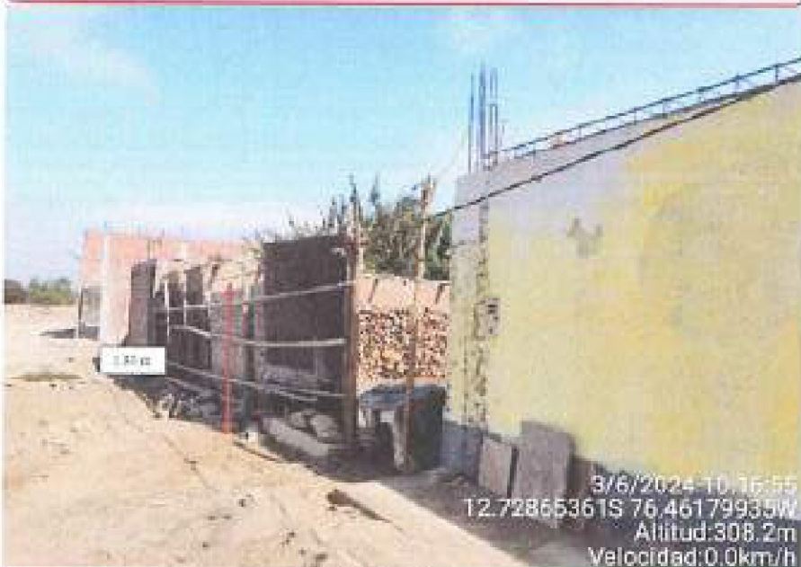
Foto 22. Conductor de BT autoportante a 1.00 m de distancia vertical del suelo, Coaylla, provincia de Canete, coordenada: 12.72865361; -76.46179935.
