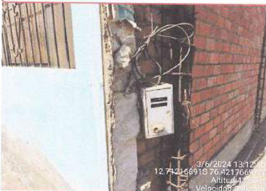
Foto 70. Caja postmedidor colgada, aereo Uquira, provincia de Cañete, coordenada: 12.71216891; 76.42176697.
