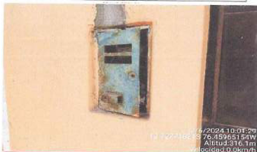
Foto 13. Caja postmedidor abierta, Coaylla, provincia de Cañete, coordenadas: 12.72771821S - 76.45965154W.
