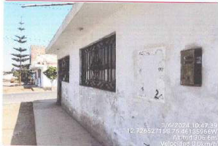
Foto 28. Tapa de caja portamedidor sobre edificación, Caylló, provincia de Cañete, coordenadas: -12.72652718; -76.46135966.
