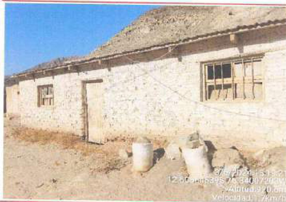
Foto 100. Conductor de acometida cruzando línea de tendido metálico, anexo Cata, provincia de Cuzco, coordenada: -12.605964539; -76.34007293.
