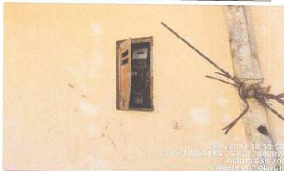
Foto 69. Caja postmedidor con tapa abierta, aereo Uquira, provincia de Cañete, coordenada: 12.71205148; -76.42174458.
