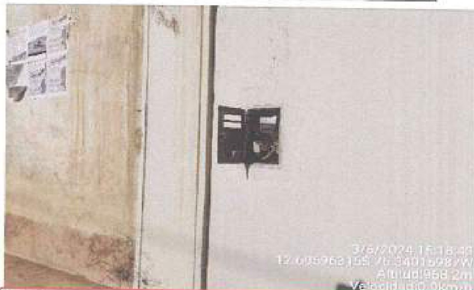
Foto 99. Caja portamedidor con tapa abierta, anexo Cata, provincia de Cuzco, coordenada: -12.60596315; -76.34015287.
