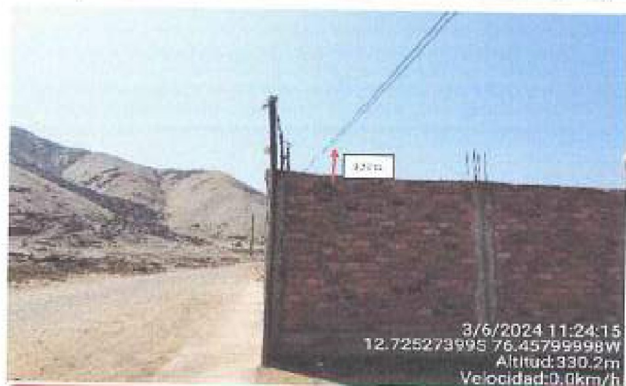
Foto 55. Conductor de BT sobre edificación a 05.0 m de distancia vertical Coaylla, provincia de Canete, coordenadas: -12.72527399; -76.45799998.
