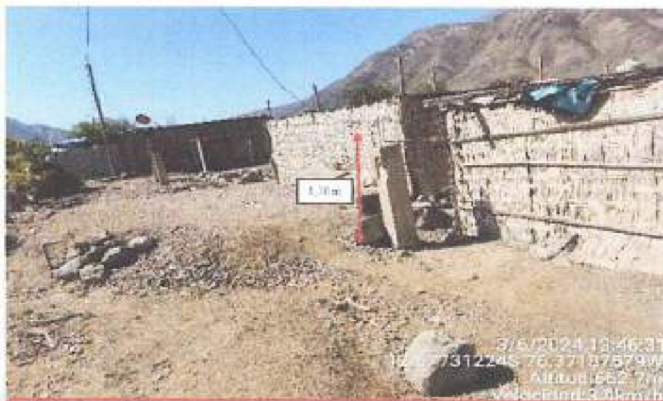
Foto 81. Conductor de acometida a 1.70 m del surfo, anexo Santiago La Yevera, provincia de Canete, coordenada: 12.6770225; 76.3717557.
