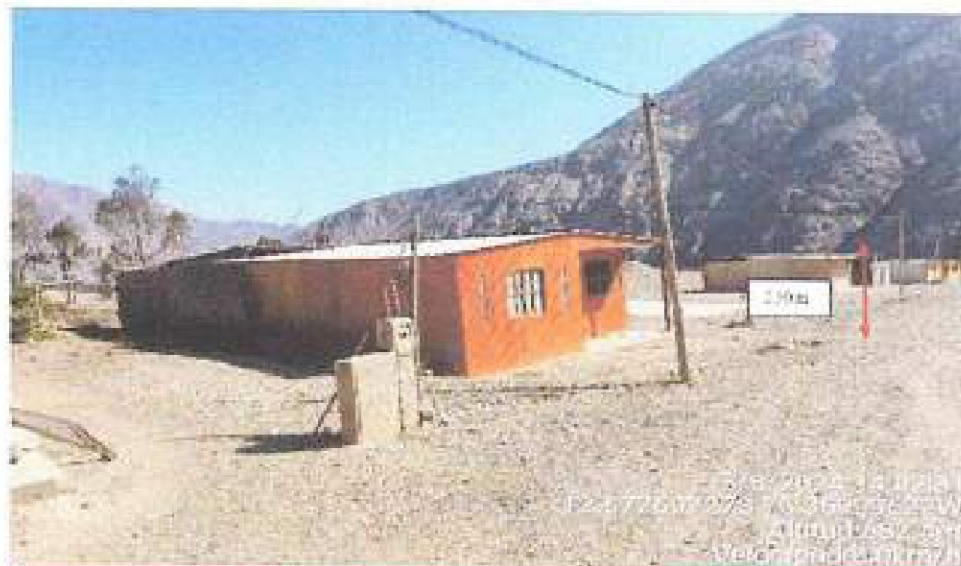
Foto 87. Conductor de 61 kV antipollante a 2.50 m del suelo, anexa Santiago La Yevera, provincia de Cañete, coordenada: -12.67260727; -76.36999621.
