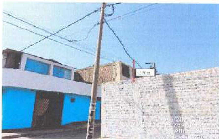
Foto #1. Conductor BT autoportante sobre edificación a 2,50 m de distancia vertical, Caylló, provincia de Cañete, coordenada: -12.72711633; -76.46056526.
