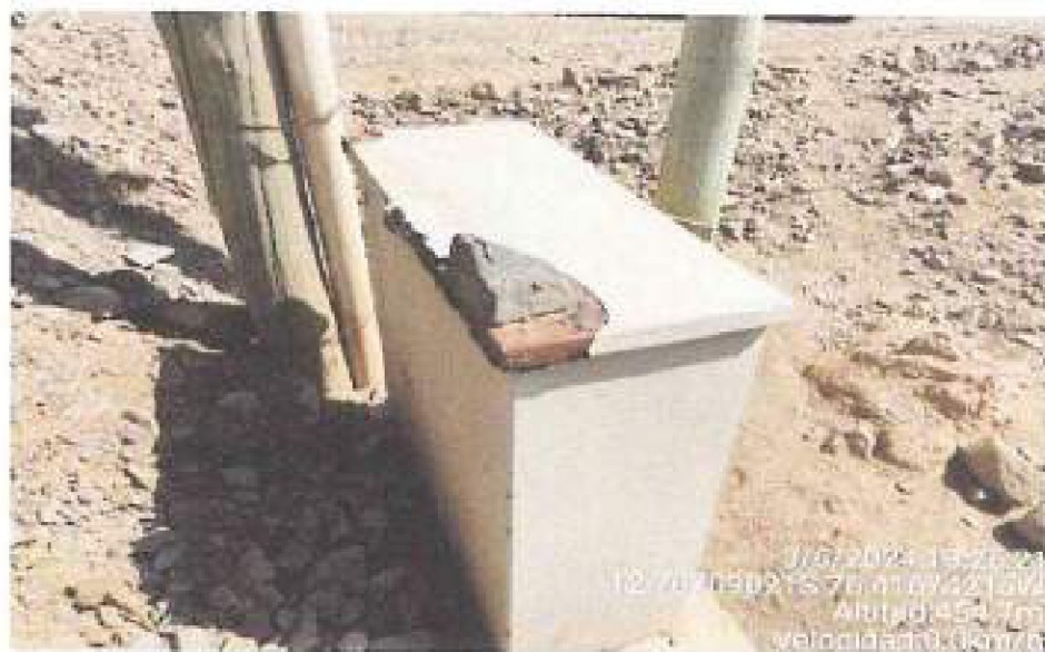
Foto 75. Tablero de distribución en mal estado por corrosión, anexo Santiago La Venera, provincia de Cañete, coordenada: -12.70709021^{\circ} -76.41674215^{\circ} .
