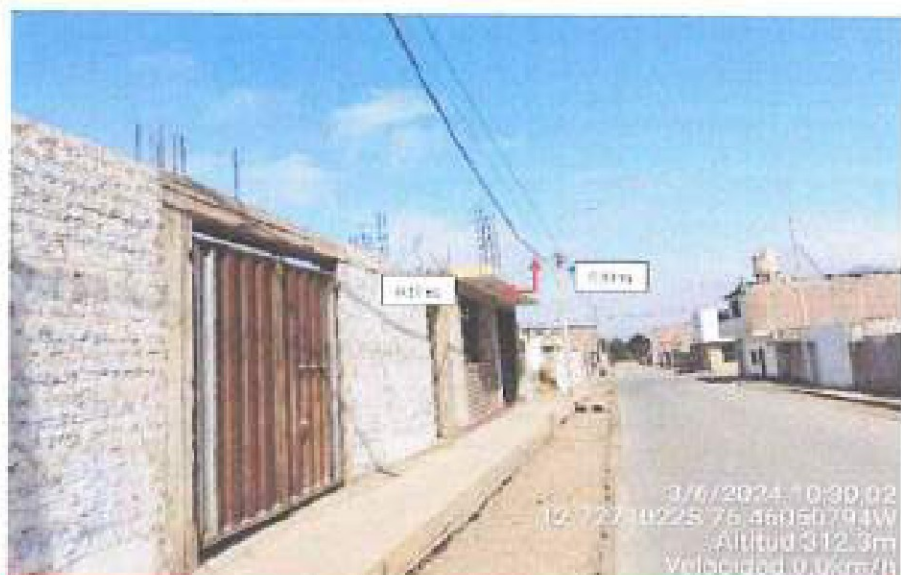
Foto 29. Conductor de BT anteparamento a 0.10 m de distancia horizontal y 0.50 m de distancia vertical de alero de edificación, Coayllo, provincia de Cusco, coordenadas: -12.72719220; -76.46050794.
