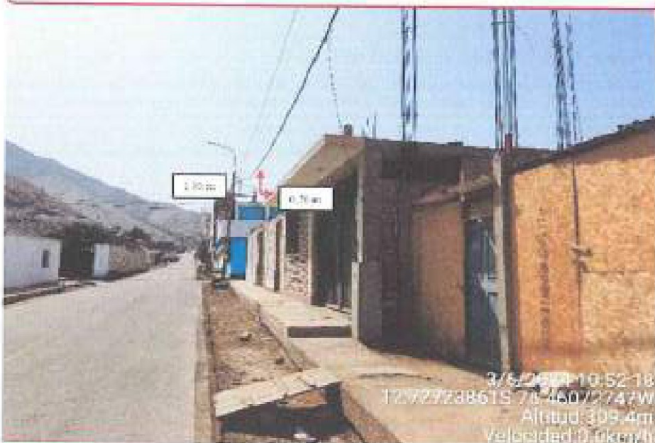
Foto 40. Conductor de BT autoportante que se eleva de forma horizontal y 1.00 m de distancia vertical. Coaylla, provincia de Cañete, coordenadas: 12.72723861; 76.46072747.
