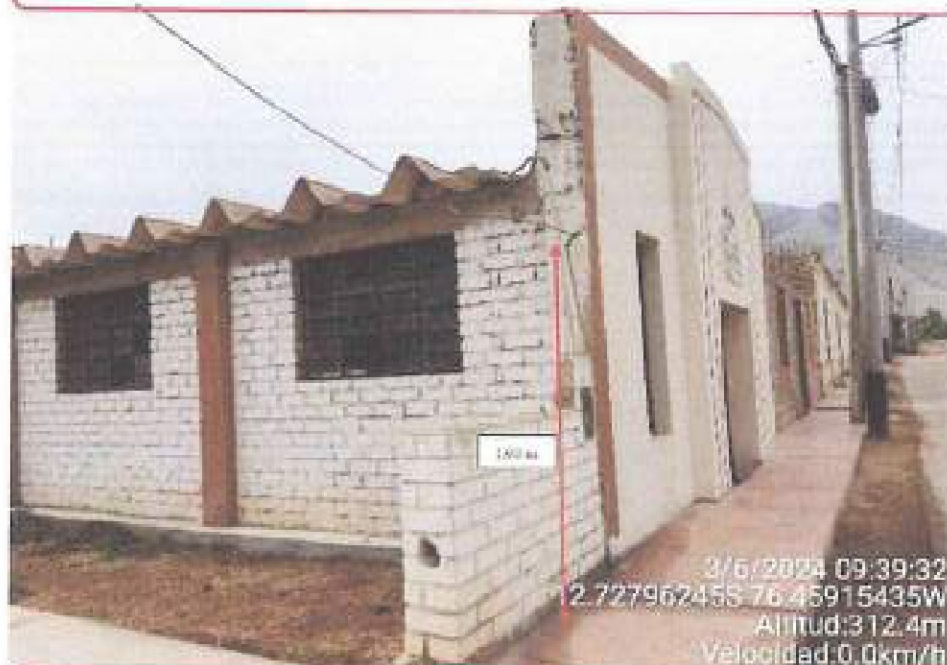
Foto 04. Conductor de acometida a 1.90 m de distancia vertical de la vereda, Cayallo, provincia de Cajete, coordenadas: 12.72796245S - 76.45915435W.
