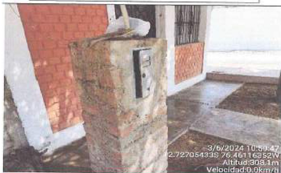
Foto 39. Tapa de caja portamedidor abierta. Coaylla, provincia de Cañete, coordenadas: 12.72705433; 76.46116352.
