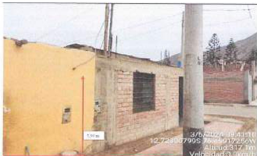
Foto 05. Conductor de acometida a 1.80 m de distancia vertical de la vereda, Coaylla, provincia de Cañete, coordenada: 12.72800799; -76.45917256.
