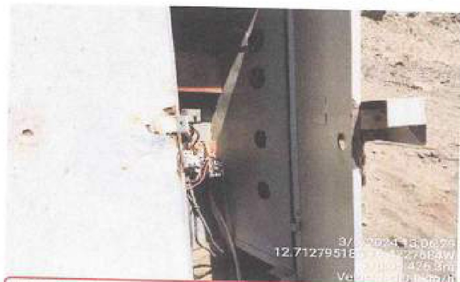
Foto 67: Tablero de distribución de SED con la puerta abierta, partes emergidas accesibles, anexo Uquira, provincia de Cañete, coordenada: -12.71281233; -76.42277395.
