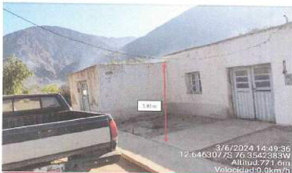
Foto n.º 97. Conductor de acometida a 1.80 m de distancia vertical de la vereda, anexo Huamantla, provincia de Cabaño, coordenada: 12.6463077; 76.3542383.
