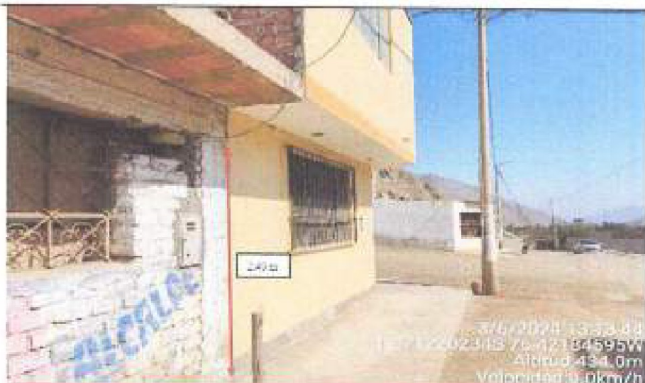
Foto n.º 71. Conductor de acometida a 2.49 m de la vereda, anexo Uquira, provincia de Cuzco, coordenada: 12.71210234; -76.42184595.
