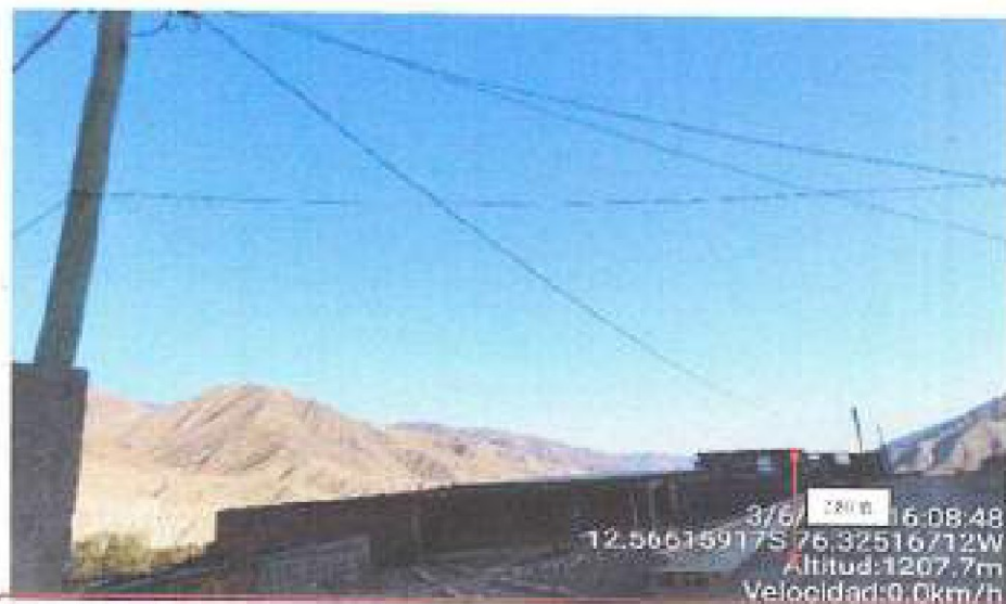
Foto 111. Conductor de BT autoportante a 2,80 m de distancia vertical del suelo, anexo Callangas, provincia de Cañete, coordenada: -12.56615917; -76.32516712.
