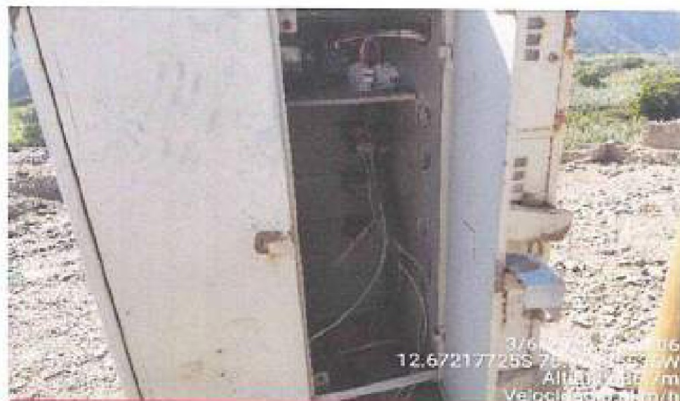
Foto 93. Tablero con puertas abiertas, partes energizadas accesible, anexo Santiago La Yesera, provincia de Cañete, coordenada: 12.67218229; -76.36386075.
