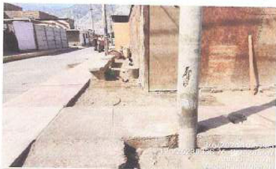
Foto 47. Poste de BT en mal estado, Cuzillo, provincia de Canele, coordenada: -12.72623033; -76.45942565.
