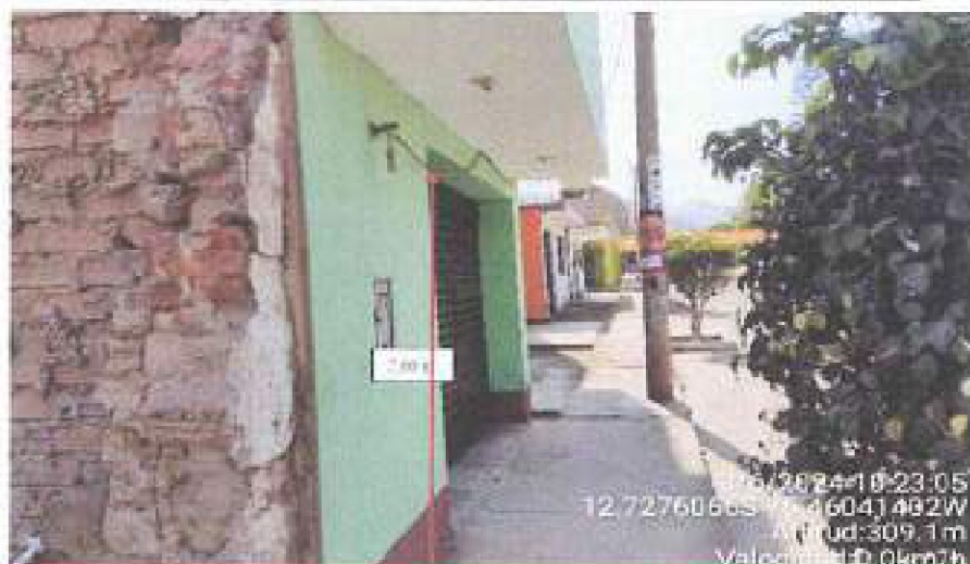
Foto 25, Conductor de acometida a 2.00 m de distancia vertical de la vereda, Coaylla, provincia de Caete, coordenada: -12.7276066; -76.46041402
