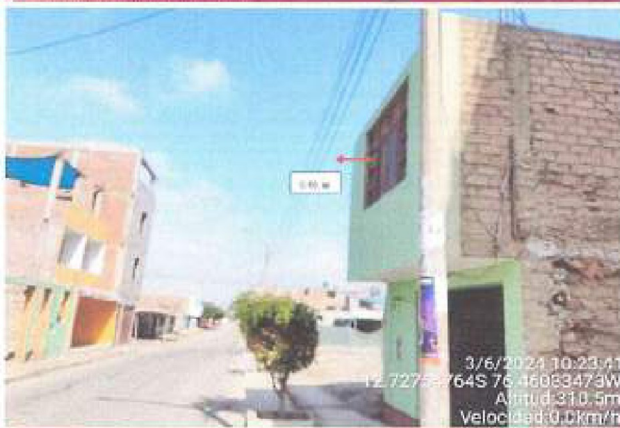
Foto 26, Conductor de BT tipo CPI a 0.60 m de distancia de ventana de edificación, Coaylla, provincia de Caete, coordenada: -12.72754764; -76.46083473 de 78
