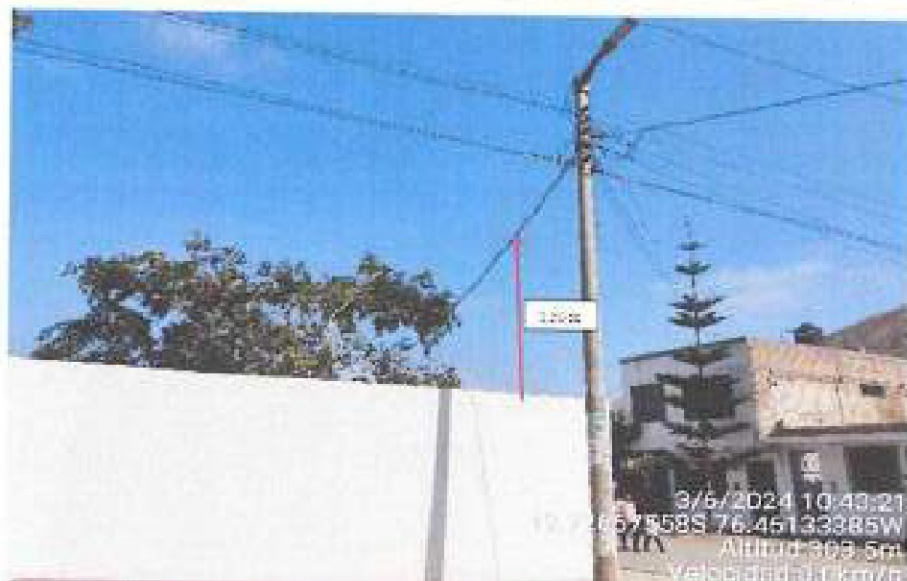
Foto 27. Conductor de BT autoportante sobre edificación a 1.50 m de distancia vertical, Caylló, provincia de Cañete, coordenadas: -12.72657558; -76.46133885
