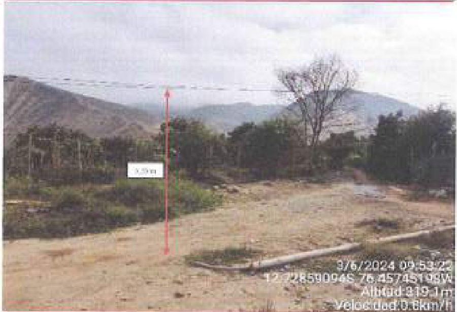
Foto 10. Conductor de BT tipo CPI a 3,20 m del suelo, Coaylla, provincia de Cañete, coordenadas: 12.72859094; 76.45745198.
