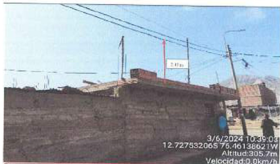
Foto 35. Conductor de BT anteparamento sobre alero de edificación a 2,40 m de distancia vertical, Cayllu, provincia de Cañete, coordenada: 12.72753206; -76.46138621.
