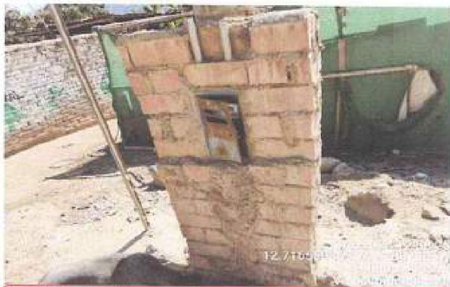
Foto 65. Caja portamedidor con tapa abierta, nueva Uquira, provincia de Cabelo, coordenadas: 12.71651086; -76.42832968.
