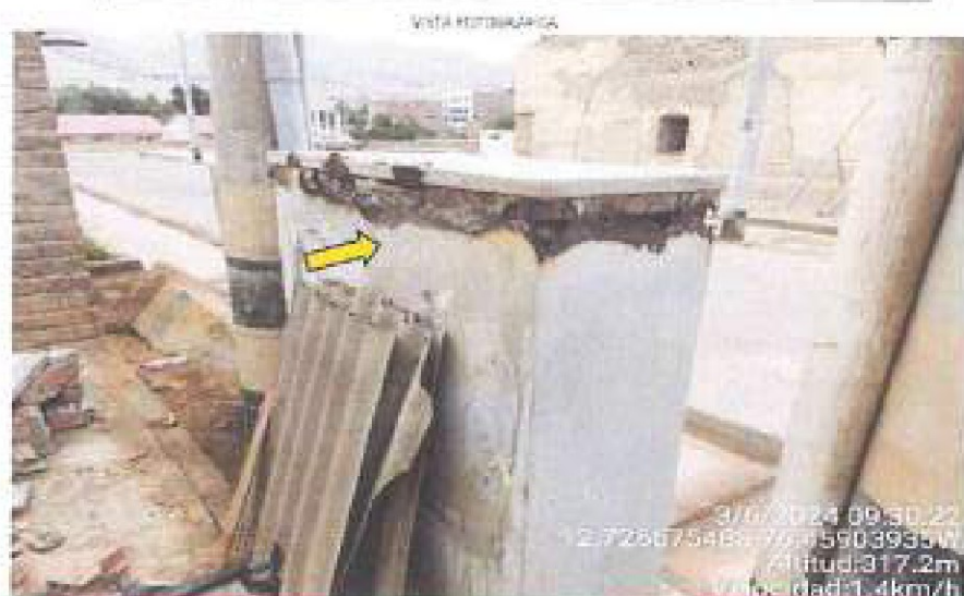
Foto 01. Taflero de distribución de la SED en mal estado, Coaylla, provincia de Cañete, coordenadas: 12.72667548; -76.45903935.
