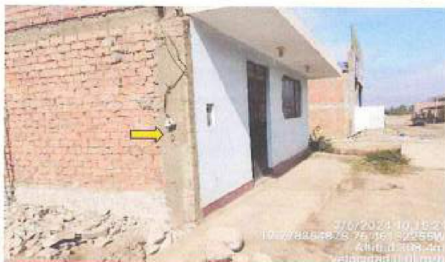
Foto 21. Interruptor termomagnético expuesto a 1.00 m de distancia vertical de la vereda, Coaylla, provincia de Canete, coordenada: 12.72865487; -76.46132255.
