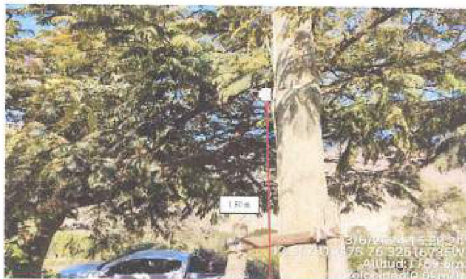
Foto 105. Interruptor termomagnético de control de AF colgado a 1.80 m del suelo, anexo Callangas, provincia de Cañete, coordenadas: -12.56731947; -76.32518738.
