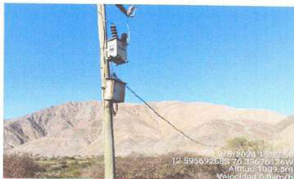
Foto 101: Fuga de aceite del transformador, anexo de Cata, provincia de Canete, coordenadas: -12.59569258; -76.33676126.
