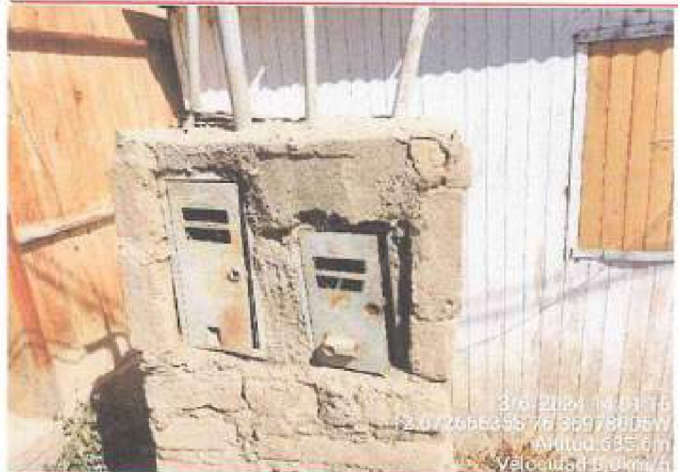
Foto 86. Tapa de caja postmedidor abierta, anexo Santiago La Yesera, provincia de Cuzco, coordenadas: 12.67165635; -76.16978085.
