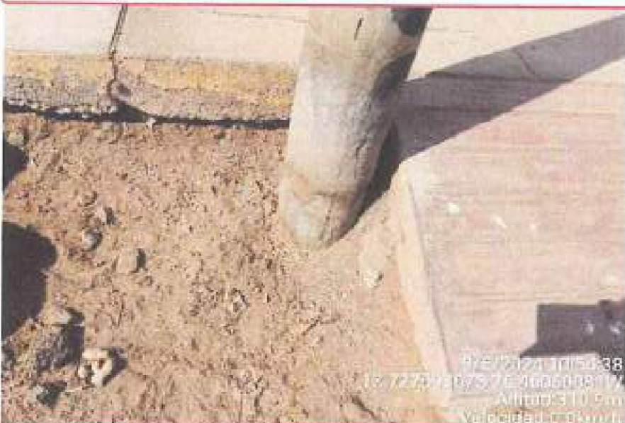
Foto #2. Base de poste de BT en mal estado, Caylló, provincia de Cañete, coordenada: -12.72709367; -76.46050081.
