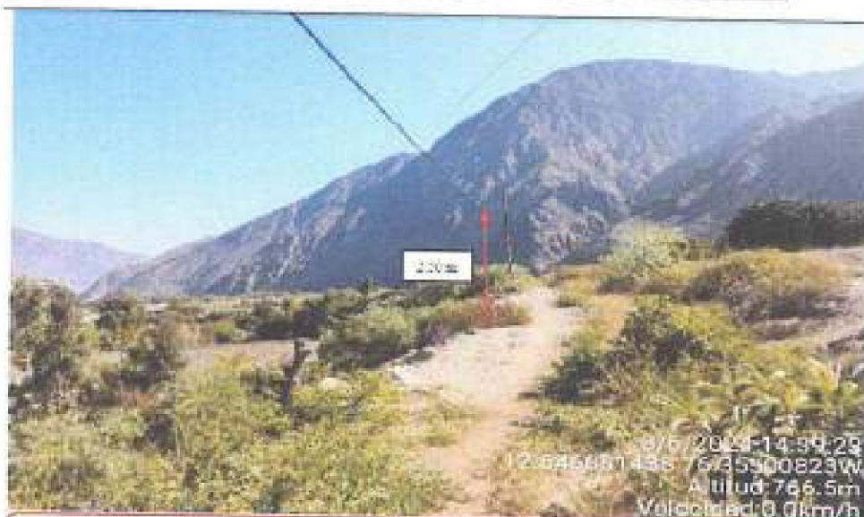
Foto 95. Conductor de BT anteparamento a 250 m. de distancia vertical del suelo, anexo Huamantla, provincia de Cusco, coordenada: -12.64668743; -76.35500823.
