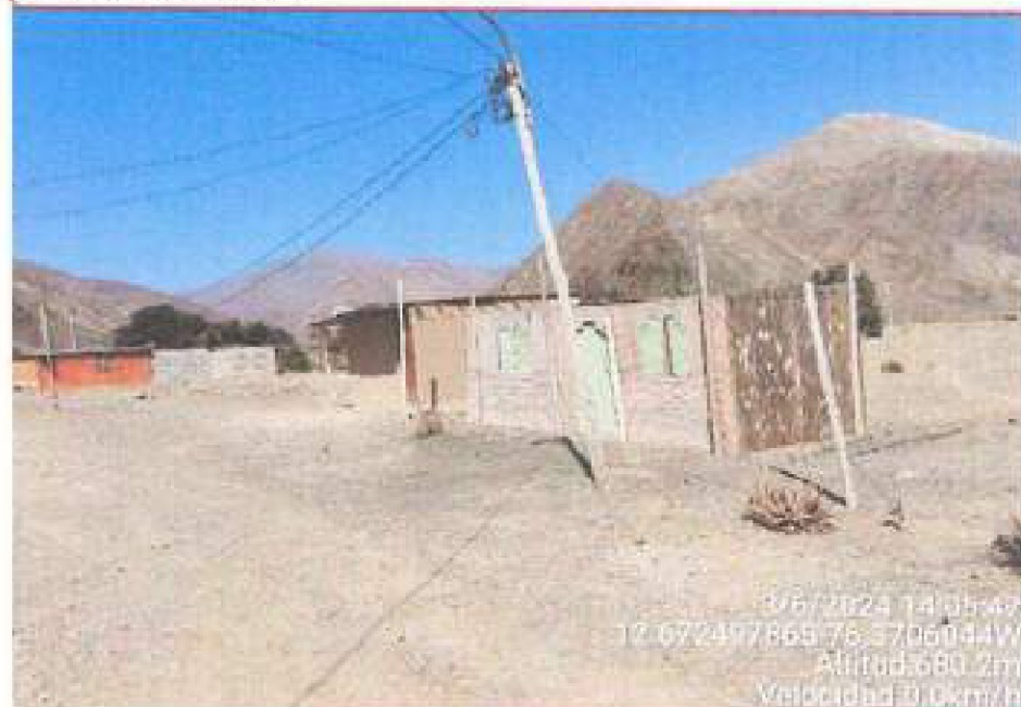
Foto 89. Poste de madera inclinado 6.5°, anexo Santiago La Yezra, provincia de Cañete, coordenadas: -12.67249786; -76.37060044.
