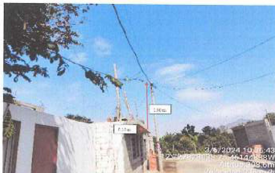
Foto 33. Conductor de BT autoportante a 0.10 m de distancia horizontal y 1.00 m de distancia vertical a tierra de edificación, Cayullo, provincia de Cañete, coordenadas: -12.7278203; -76.4614888
