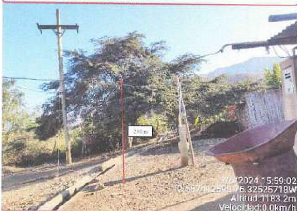
Foto 106. Conductor de acometida a 2.00 m del suelo, anexo Callangas, provincia de Cañete, coordenadas: -12.56741259; -76.32525718.
