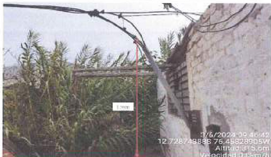
Foto 08. Conductor de arremetida a 1,50 m de distancia vertical del piso, sin fijación, Coaylla, provincia de Cañete, coordenadas: 12.72874888; 76.45828905.
