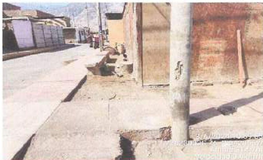
Foto 45. Poste de BT en mal estado, Coaylla, provincia de Cañete, coordenadas: -12.72629055; -76.45942868.
