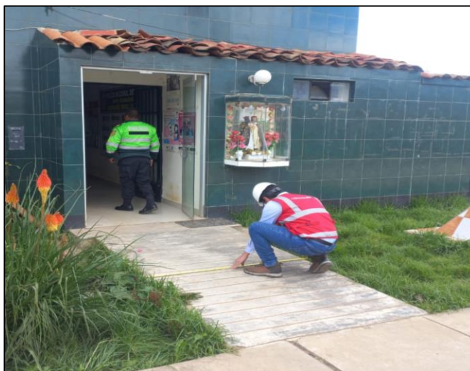
Vista fotográfica n.º 1. Rampa sin señalización podotáctil.
