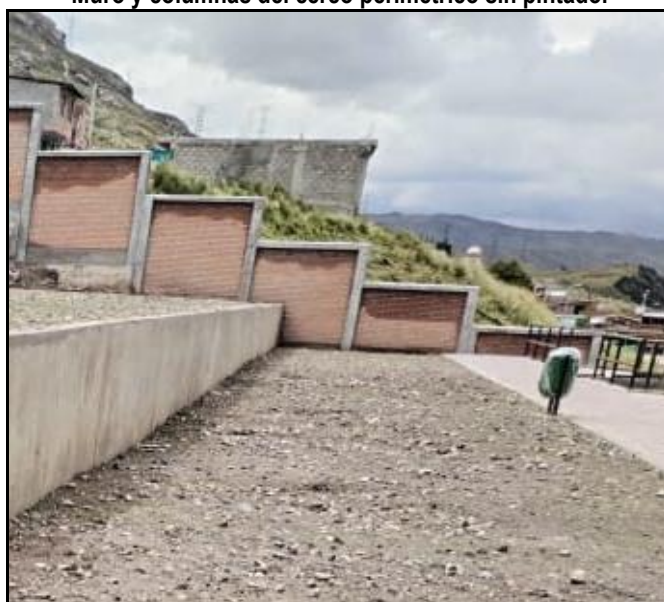
Fotografía n.º 1 Muro y columnas del cerco perimétrico sin pintado.
