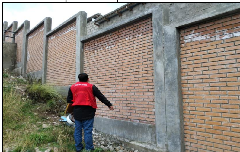
Fotografía n.º 6 Cerco perimétrico con presencia de eflorescencia
