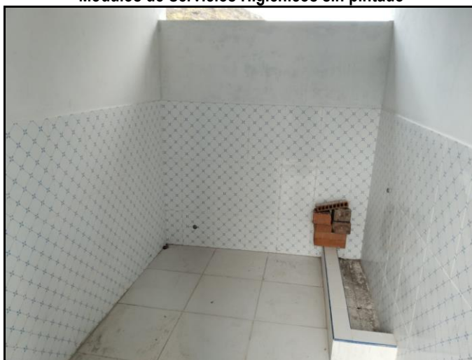
Fotografía n.º 3 Módulos de Servicios Higiénicos sin pintado
