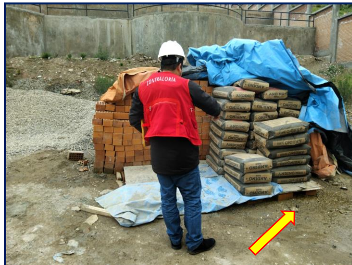
Fotografía n.º 11 Almacenamiento de cemento Portland
