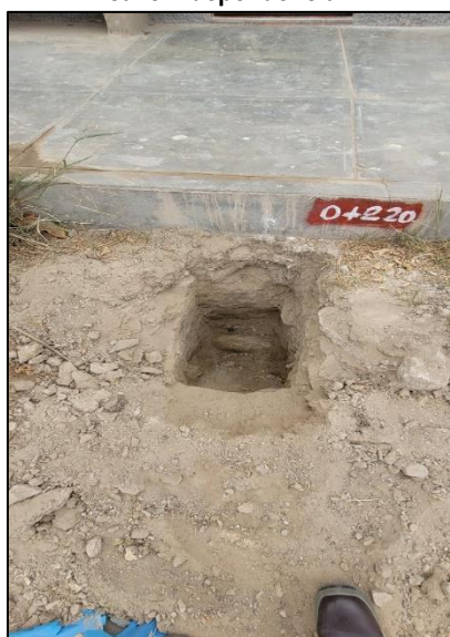
Imagen n.° 6 Calicatas donde se observa tuberías de asbesto cemento en la progresiva 0+220 de la calle Independencia
