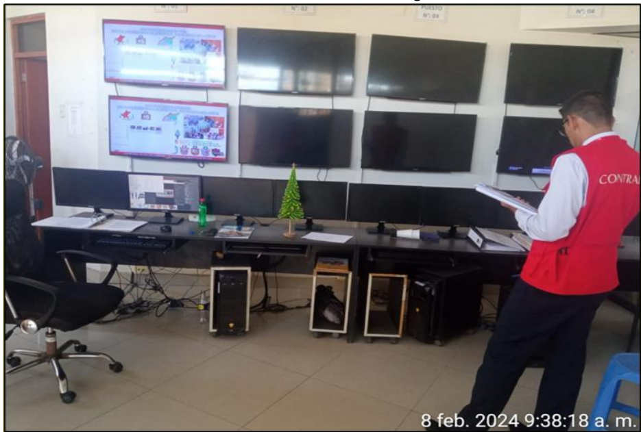
Imagen n.º 2 Verificación de cámaras de videovigilancia
