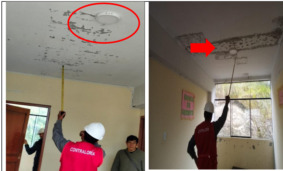
Imagen n.º 5 Identificación de fallas en las instalaciones Eléctricas.
