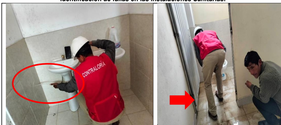
Imagen n.º 4 Identificación de fallas en las instalaciones Sanitarias.
