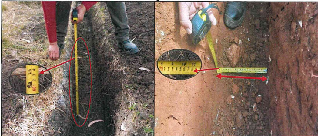
Imagen n.º 3: Altura de la zanja para la red de aducción y distribución es de 0.63m, lo cual es inferior a 0.80m, como lo establece el expediente técnico.
