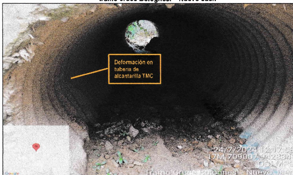
Imagen n.º 3 Deformaciones en tubería de alcantarilla TMC \varnothing 36" de km 4+145, tramo cruce Bolognesi – Nuevo Jaén
