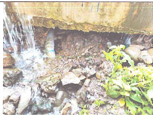
Imagen n.º 10: Tuberías de limpieza y rebose parcialmente expuestas.
