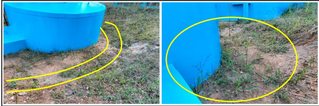
Imagen n.º 5 Reservorio sin cuneta de drenaje perimetral
