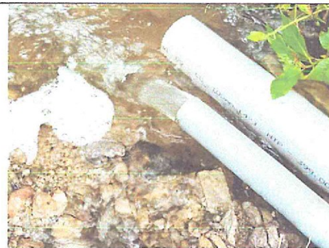
Imagen n.º 12: Agua de rebose en captación, en tubería de dos (2) pulgadas.
