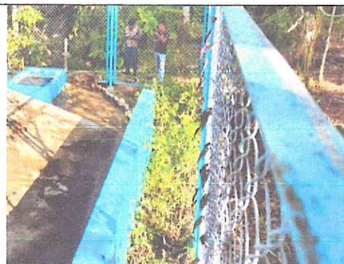
Imagen n.º 4: Presencia de maleza en el interior del cerco perimétrico de la captación.
