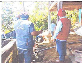
Imagen n.º 48: Conexión C-93
