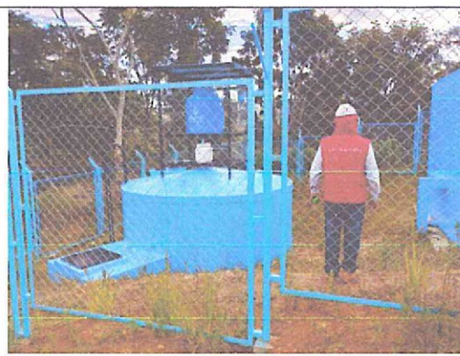
Imagen n.º 16: Vista exterior del reservorio de 15 m³ de capacidad, con su cámara de válvulas y sistema de cloración.
