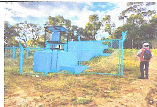
Imagen n.º 13: Vista panorámica de la planta de tratamiento de agua potable y reservorio.
