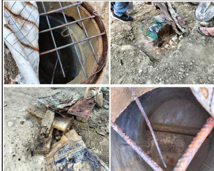
Imagen n.º 9 Buzón sin tapa de inspección de concreto armado, tapado con maderas, sacos y tierra.
