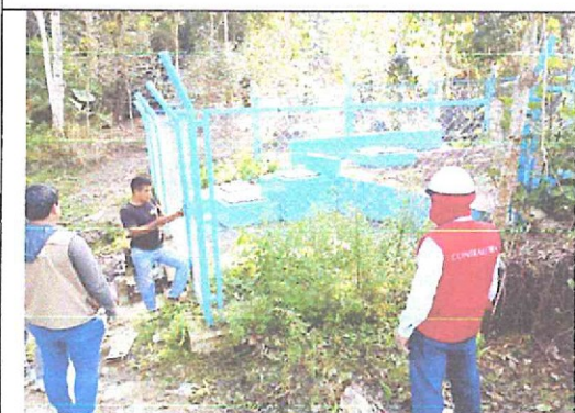
Imagen n.º 5: Presencia de maleza en el interior del cerco perimétrico de la captación.
