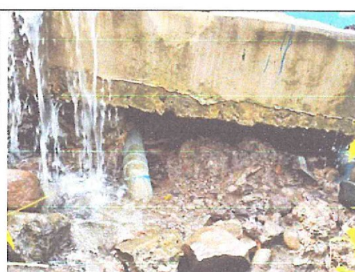
Imagen n.º 8: Socavación en la estructura de protección de la captación alcanza la cimentación de la caja de válvulas.
