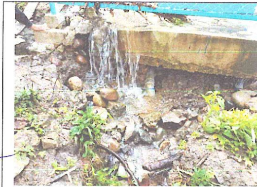
Imagen n.º 9: Socavación en la estructura de protección de la captación.
