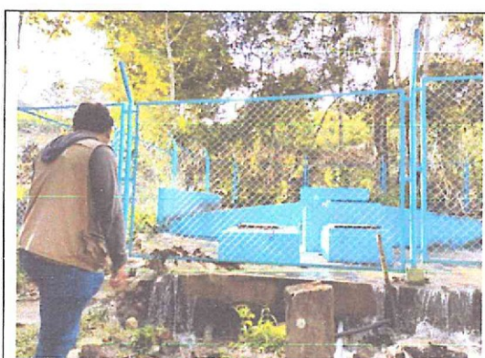
Imagen n.º 7: Socavación en la estructura de protección de la captación.
