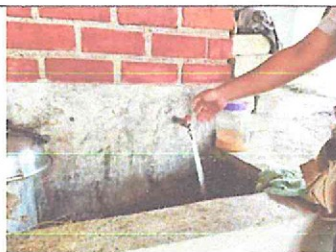
Imagen n.º 42: Conexión C-81
