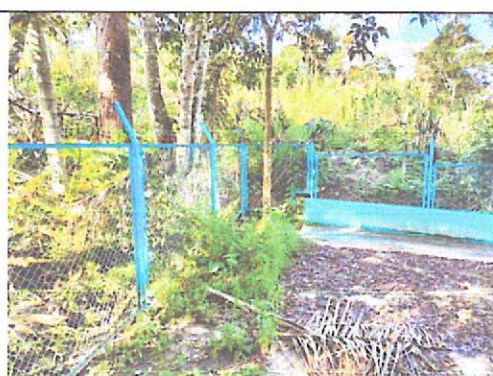
Imagen n.º 6: Presencia de maleza y ramas de vegetación sobre la losa de estructura de captación.
