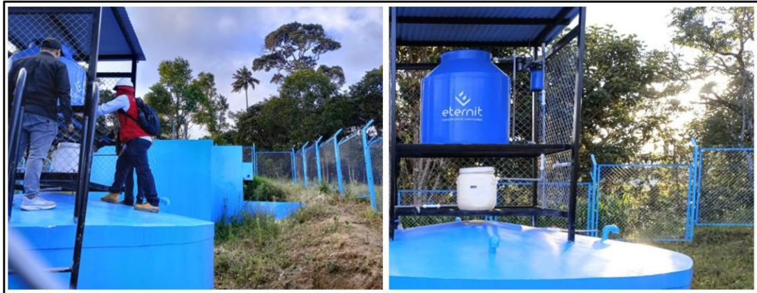
Imagen n.° 14 Sistema de cloración no se encontró en funcionamiento
