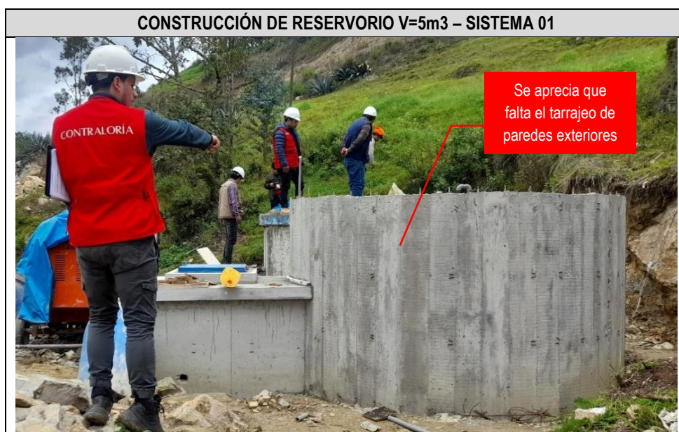
Imagen n.º 2: Se observa que aún no se ha realizado el tarrajeo de las paredes exteriores del reservorio circular.
