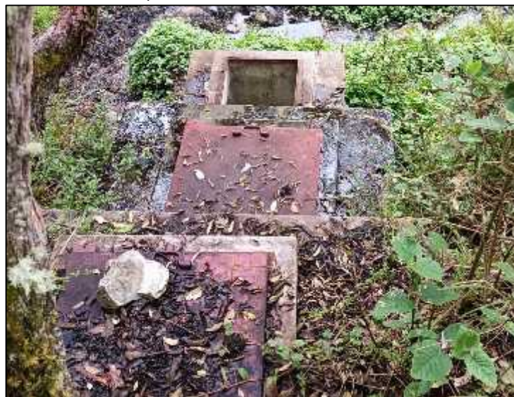
Imagen n.° 09 Captación en Sector Tierras Amarillas
