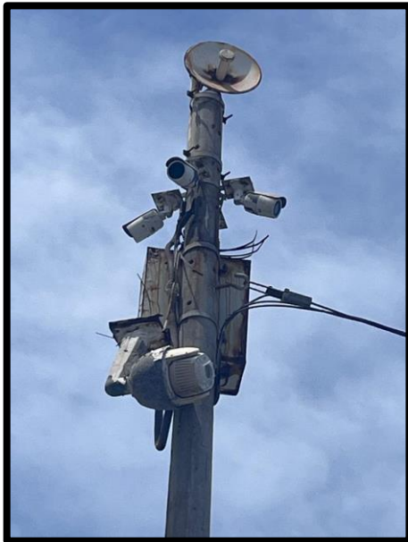
Cámaras instaladas en postes, se aprecian (3) cámaras y una cámara 360°
