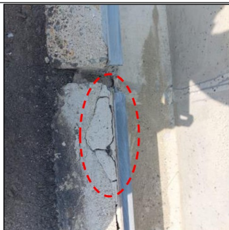
Se visualiza desprendimiento del acabado en la unión de ángulo metálico y borde de canaleta pluvial
