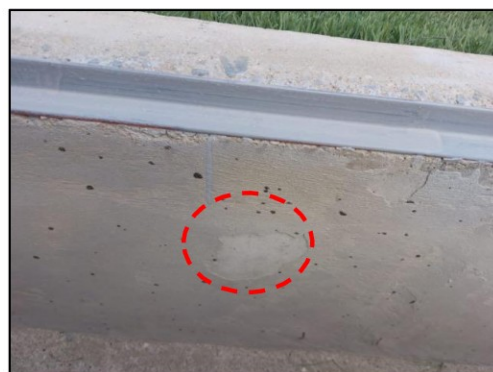
Se visualiza desprendimiento del acabado del revestimiento de las paredes de internas del canal pluvial
