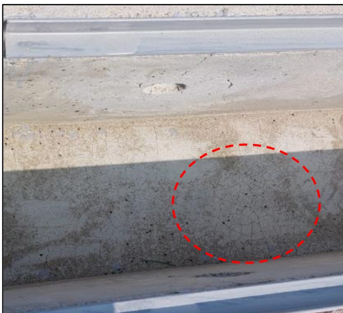
Se visualiza fisuras longitudinales y transversales en el fondo del canal
