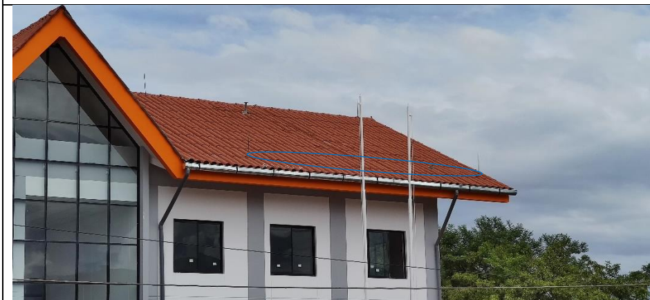
FOTOGRAFÍA N° 26 SE VISUALIZA LA COBERTURA DE LA FRONTAL, LADO DERECHO, LOS PARARRAYOS NO ESTÁN CONECTADOS MEDIANTE EL CONDUCTOR DE COBRE DESNUDO
