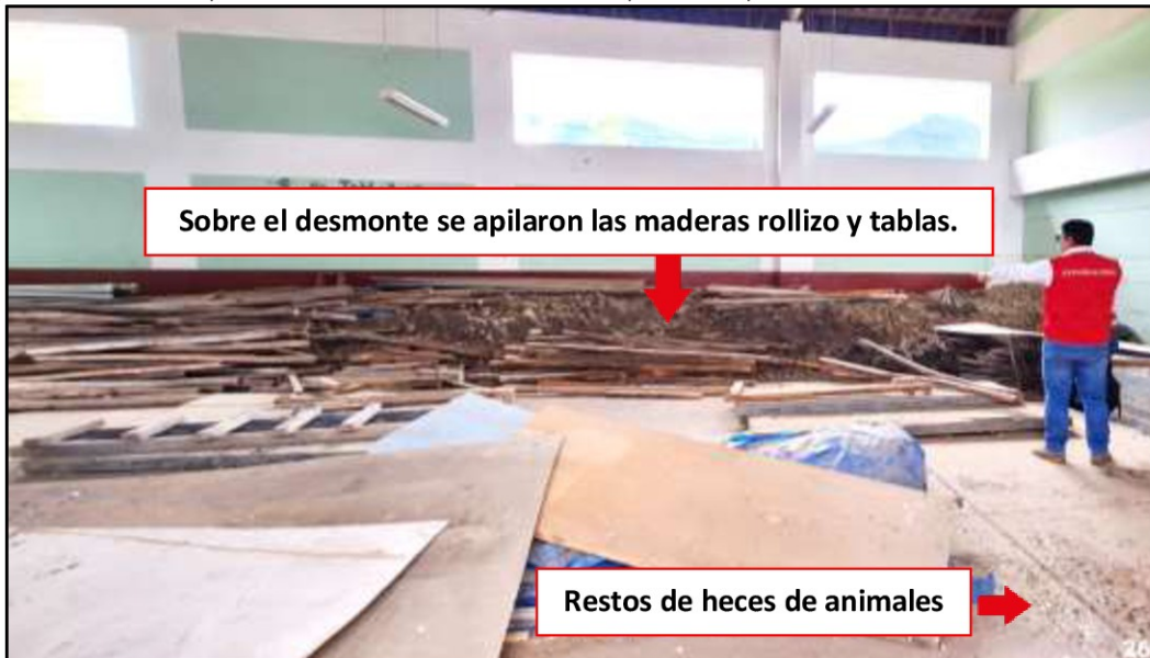
Fuente: Acta de inspección física N° 001-2024-OCI/MPHi/ARCM/2473481, de 26 de noviembre de 2024.
