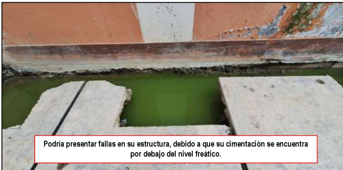
Fuente: Acta de inspección física N° 001-2024-OCI/MPHi/ARCM/2473481, de 26 de noviembre de 2024.
