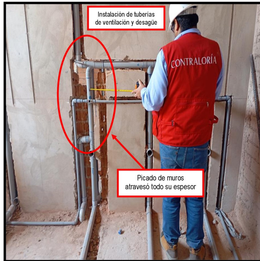
FOTOGRAFÍA N° 12 ESTADO DE LOS SS.HH. DEL MÓDULO II DURANTE LA VISITA REALIZADA POR LA COMISIÓN DE CONTROL EL 11 DE SETIEMBRE DE 2024
