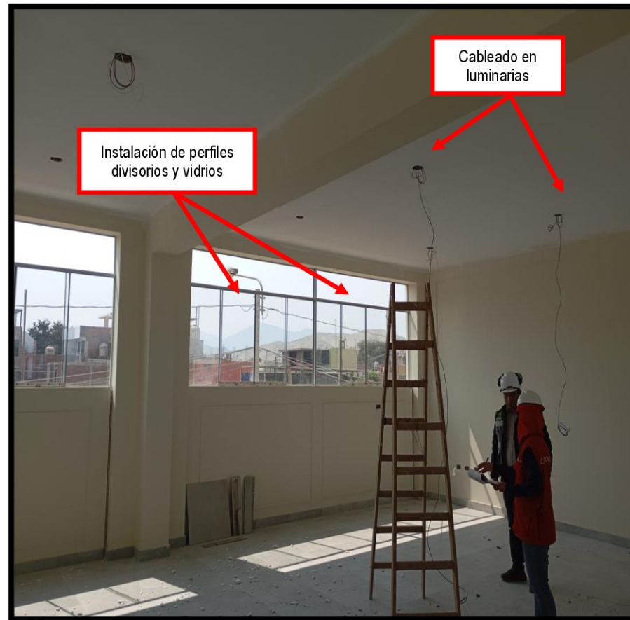
FOTOGRAFÍA N° 8 ESTADO DE LAS AULAS DEL 2DO PISO, MÓDULO II DURANTE LA VISITA REALIZADA POR LA COMISIÓN DE CONTROL EL 15 DE AGOSTO DE 2024
