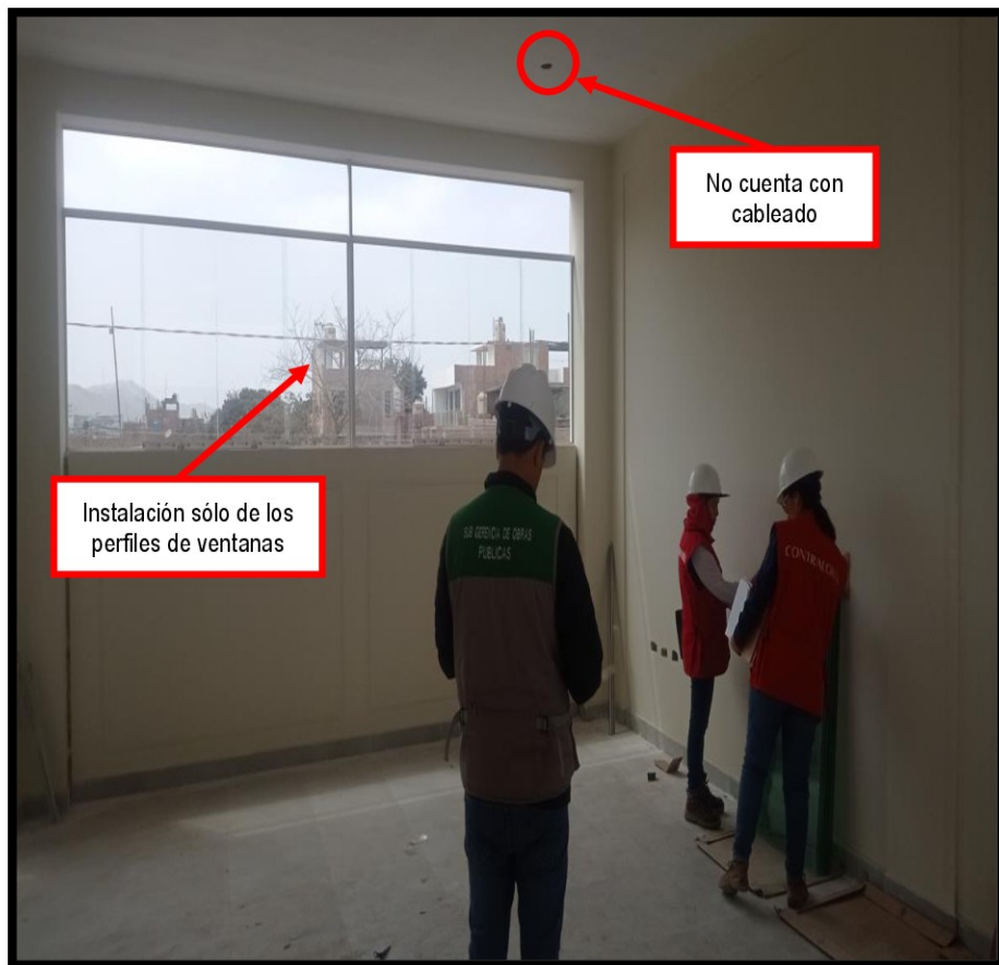
FOTOGRAFÍA N° 7 ESTADO DE LAS AULAS DEL 2DO PISO, MÓDULO II DURANTE LA VISITA REALIZADA POR LA COMISIÓN DE CONTROL EL 15 DE AGOSTO DE 2024
