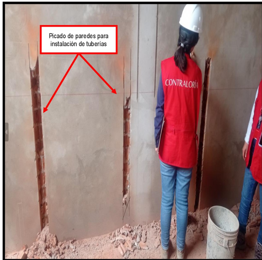
FOTOGRAFÍA N° 11 ESTADO DE LOS SS.HH. DEL MÓDULO II DURANTE LA VISITA REALIZADA POR LA COMISIÓN DE CONTROL EL 15 DE AGOSTO DE 2024
