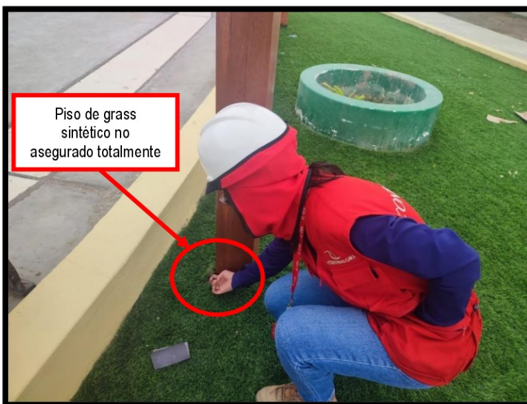
IMAGEN N° 9 PISO DE GRASS SINTÉTICO NO ASEGURADO TOTALMENTE – VISTA PANORÁMICA
