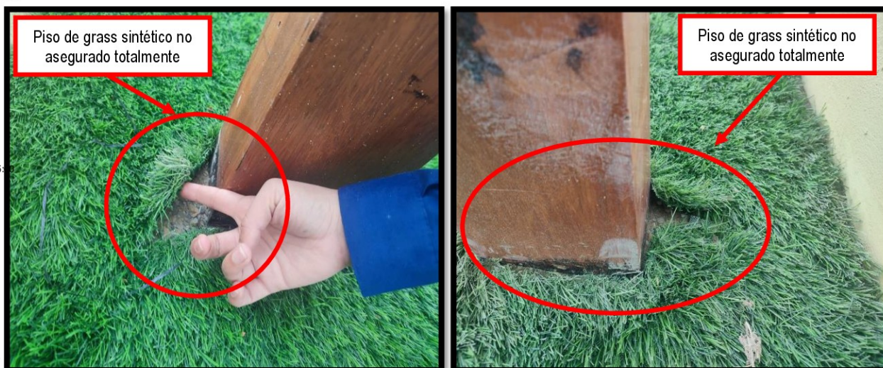
IMAGEN N° 10 PISO DE GRASS SINTÉTICO NO ASEGURADO TOTALMENTE – VISTA DE CERCA
