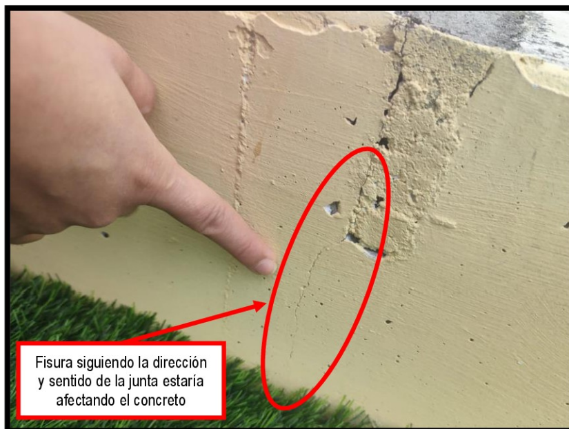
IMAGEN N° 7 FISURA SIGUIENDO SENTIDO DE JUNTA
