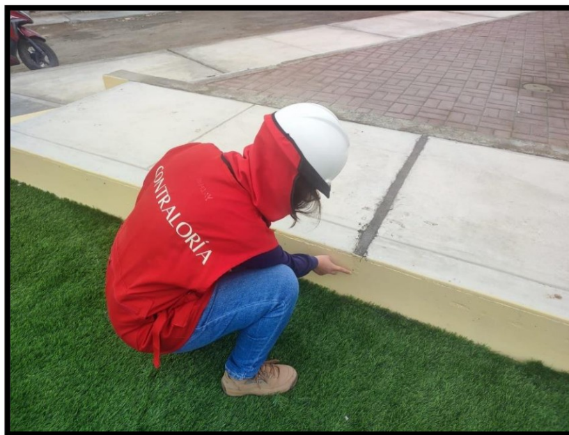
IMAGEN N° 6 JUNTAS EN VEREDA
