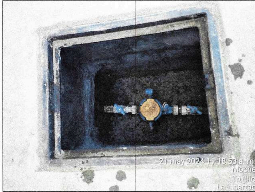
Fotografía n.º 7: Instalación de marco y tapa termoplásticas (intervención tipo A2 por Renovación) en Sector Taquilla Mz. 03 Lote 05-A de la Calle Independencia del distrito de Moche.
