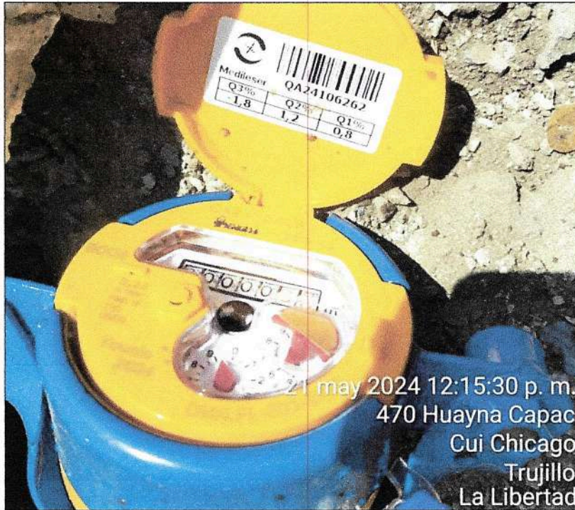
Fotografía n.º 19: Medidor instalado en Huayna Cápac N° 466 en la Urb. Santa María del distrito de Trujillo, con número de serie QA24106262 como se aprecia en la tapa plástica del medidor.
