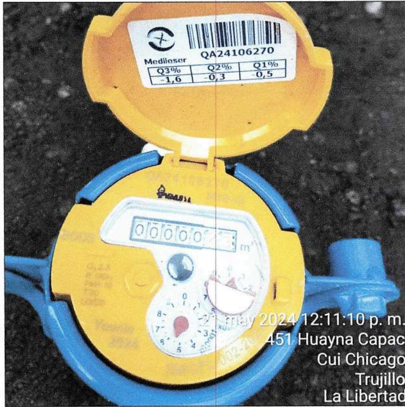
Fotografía n.º 17: Medidor instalado en Huayna Cápac N° 451 en la Urb. Santa María del distrito de Trujillo, con número de serie QA24106270 como se aprecia en la tapa plástica del medidor.
