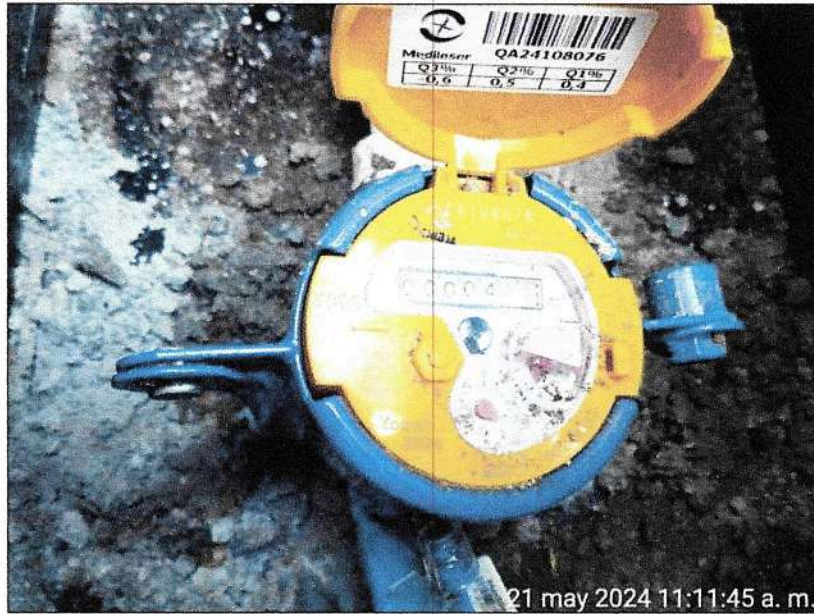
Fotografía n.º 5: Medidor instalado en Sector Taquila Mz. 04 Lote 08 del Pasaje Joel Arroyo del distrito de Moche, con número de serie QA24108076 como se aprecia en la tapa plástica del medidor.
