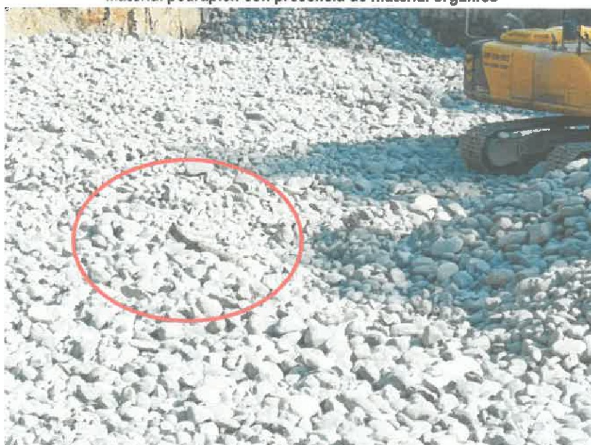
Fotografía n.º 4 Material pedraplén con presencia de material orgánico
