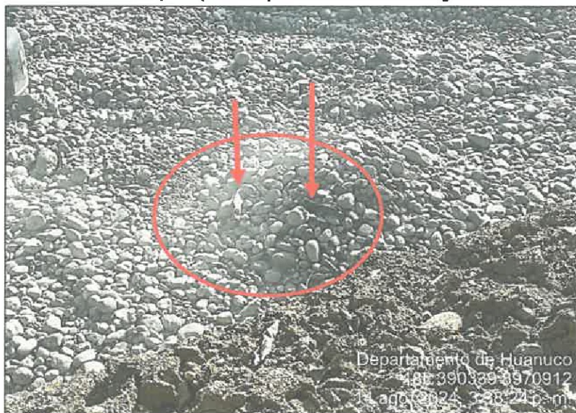
Fotografía n.º 2 Material pedraplén con presencia de material orgánico
