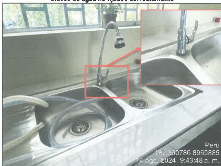
Panel fotográfico n.º 31 Llaves de agua no fijados correctamente
