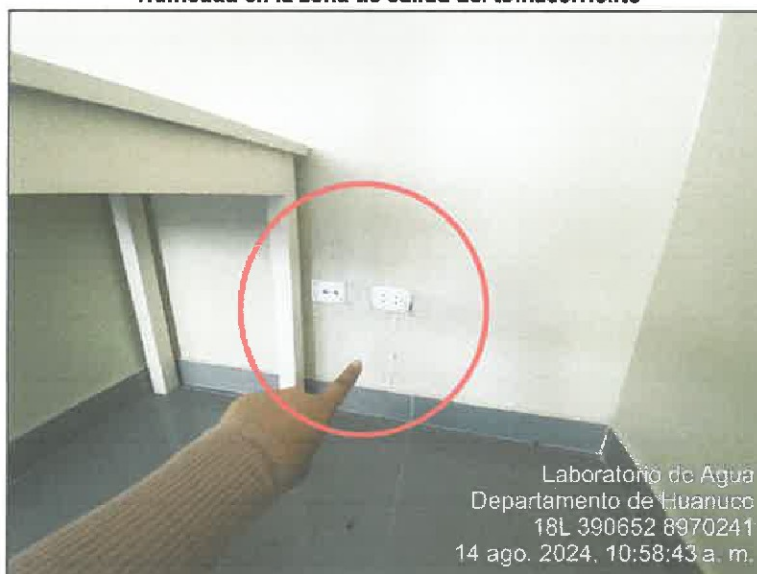
Panel fotográfico n.º 19 Humedad en la zona de salida del tomacorriente
