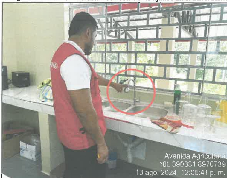
Panel fotográfico n.º 5 Los grifos del lavadero no están correctamente fijados en el Laboratorio
