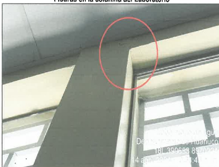
Panel fotográfico n.º 16 Fisuras en la columna del Laboratorio
