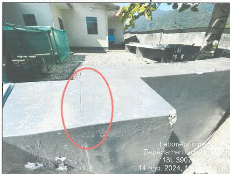
Panel fotográfico n.º 26 Fisuras en los muros del patio
