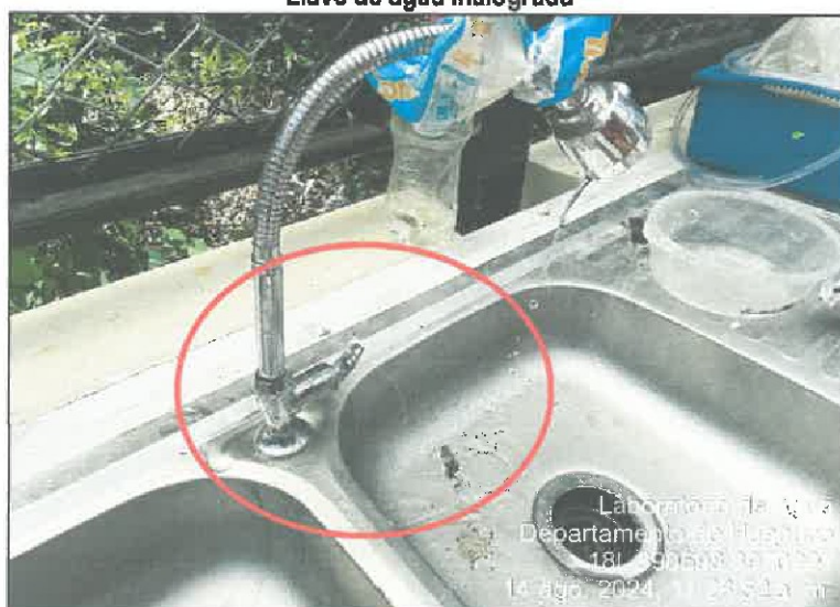
Panel fotográfico n.º 22 Llave de agua malograda
