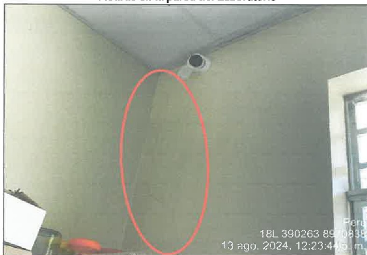
Panel fotográfico n.º 9 Fisuras en la pared del Laboratorio
