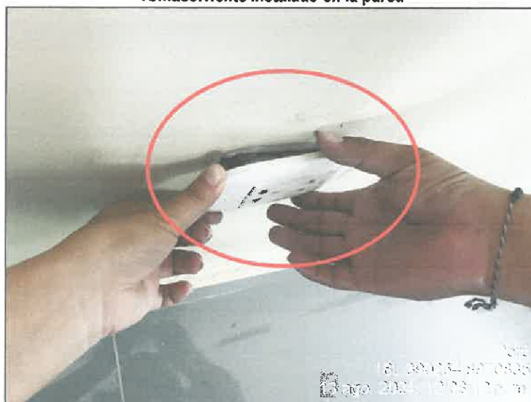
Panel fotográfico n.º 7 Tomacorriente instalado en la pared
