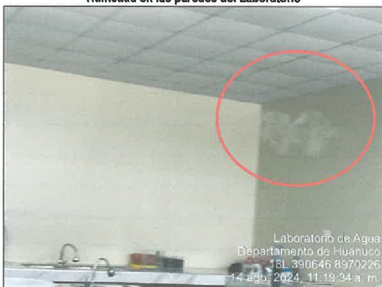
Panel fotográfico n.º 18 Humedad en las paredes del Laboratorio
