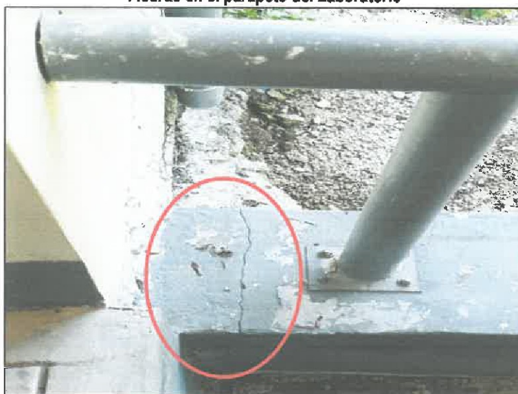
Panel fotográfico n.º 10 Fisuras en el parapeto del Laboratorio
