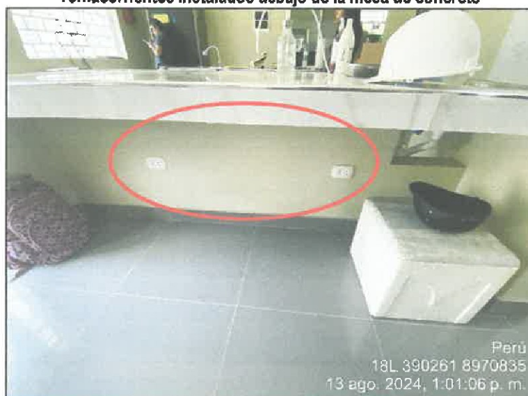
Panel fotográfico n.º 6 Tomacorrientes instalados debajo de la mesa de concreto
