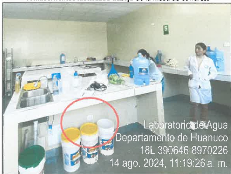
Panel fotográfico n.º 20 Tomacorrientes instalados debajo de la mesa de concreto
