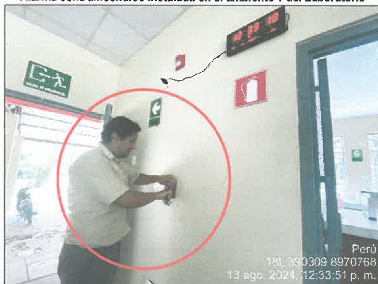
Panel fotográfico n.º 8 Alarma contra incendios instalada en el ambiente 1 del Laboratorio
