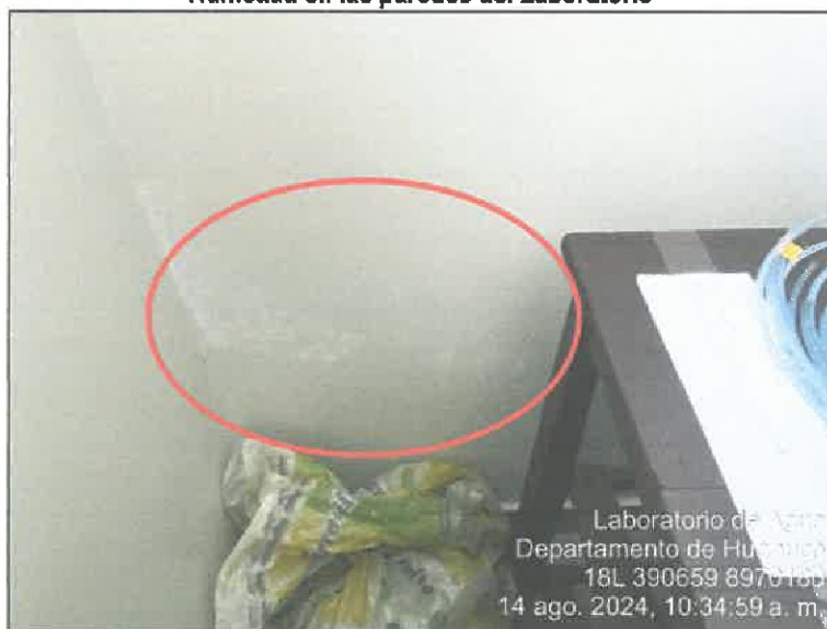
Panel fotográfico n.º 17 Humedad en las paredes del Laboratorio
