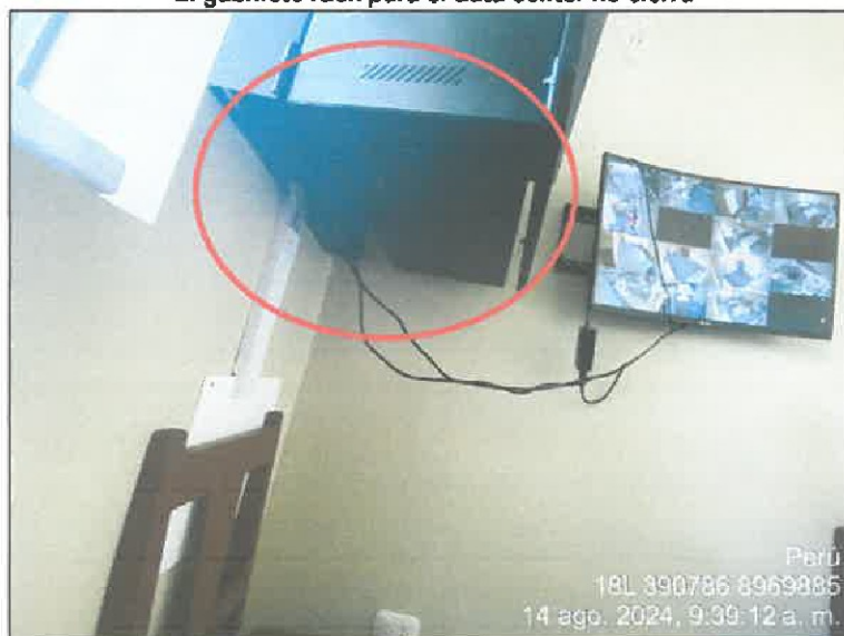
Panel fotográfico n.º 24 El gabinete rack para el data center no cierra
