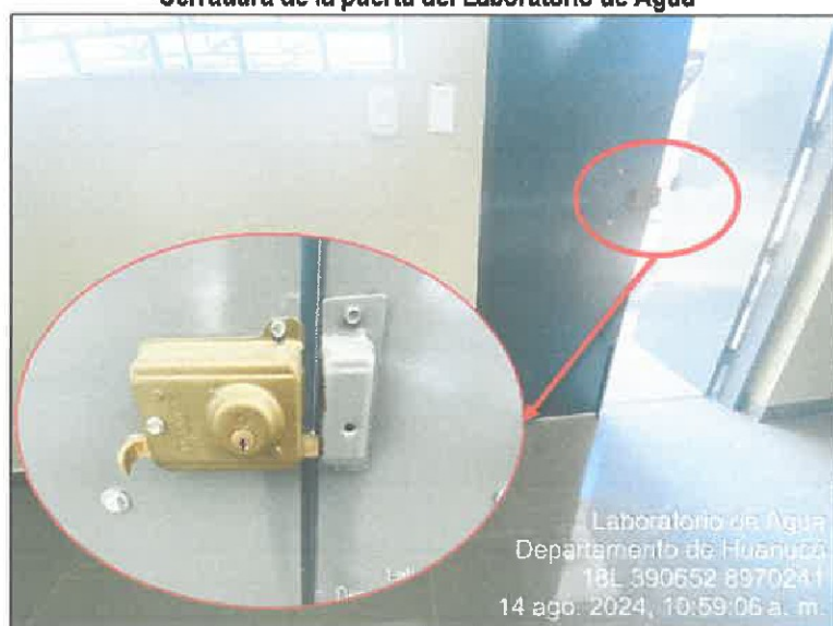
Panel fotográfico n.º 14 Cerradura de la puerta del Laboratorio de Agua
