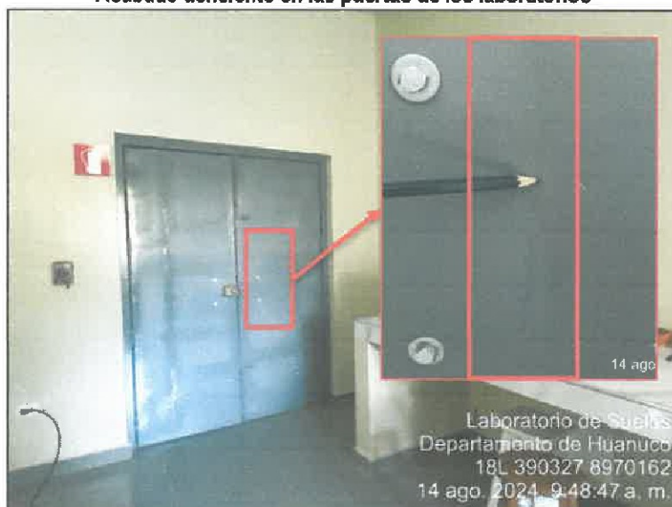
Panel fotográfico n.º 27 Acabado deficiente en las puertas de los laboratorios
