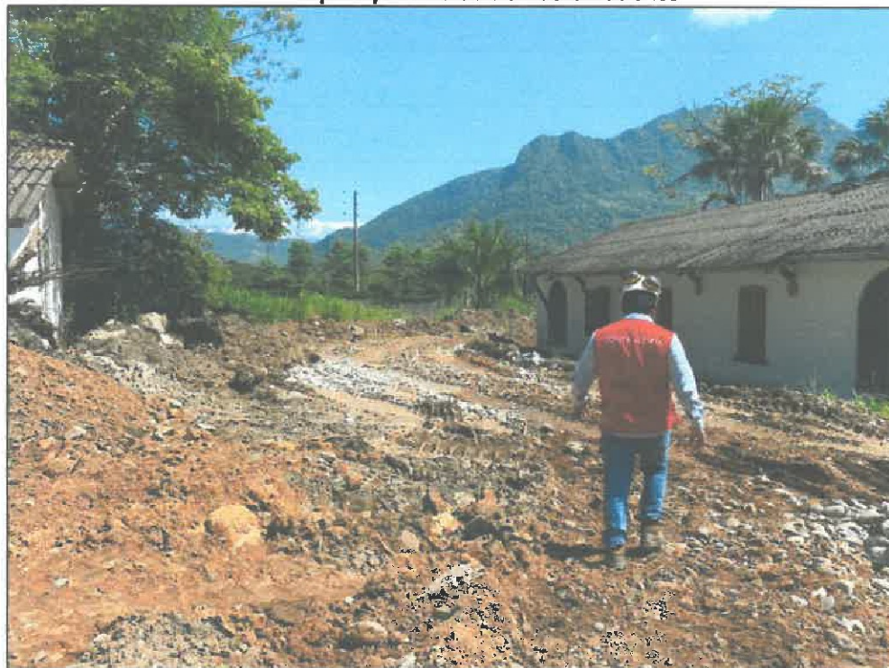
Panel fotográfico n.° 1 Botadero principal de la obra sin señalizaciones
