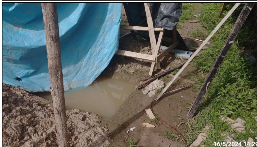
Fotografía n.ºs 406 y 407: Se observa una zanja entre la casa de madera y la edificación de los servicios higiénicos, con presencia de agua.
