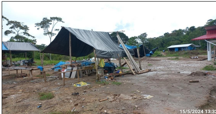
Fotografía n.º 401: Se observa otro de los ambientes, construido con postes de madera y plásticos, en el cual se tiene, pegamento para cerámicos, baldes de pintura, porcelanato y diversas herramientas.
