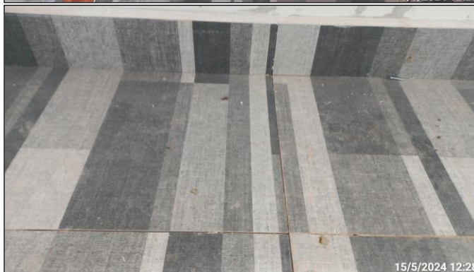
Fotografía n.ºs 168 y 169: Se observa el piso y contrazócalos enchapados y sin fraguar.
